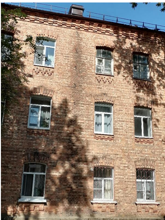
7. «Жилой дом» в составе объекта культурного наследия регионального значения «Комплекс военного городка Лужского Сергиевского артиллерийского полигона», Ленинградская область, Лужский район, г. Луга-3, 1-й полигон, тер. в/г №3, д.3/40. Юго-восточный фасад. Фрагмент. Фото 01.08.2023г.
