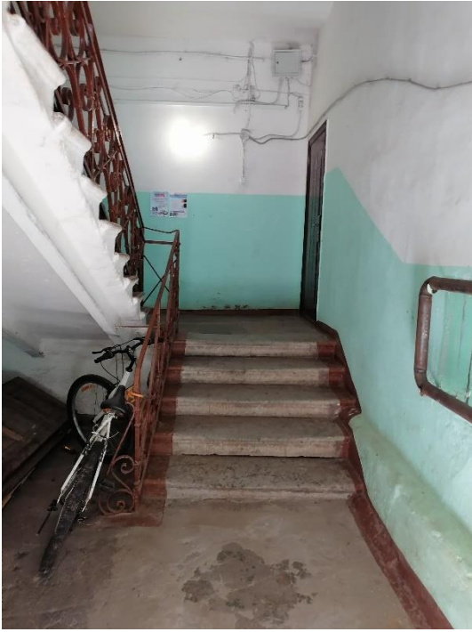
21. «Жилой дом» в составе объекта культурного наследия регионального значения «Комплекс военного городка Лужского Сергиевского артиллерийского полигона», Ленинградская область, Лужский район, г. Луга-3, 1-й полигон, тер. в/г №3, д.3/40. Лестничная клетка №1. Общий вид. Фото 01.08.2023г.
