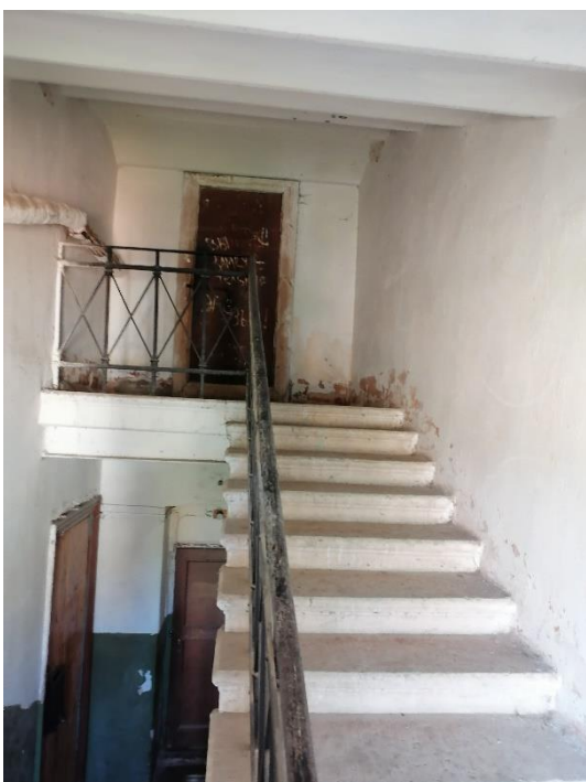
34. «Жилой дом» в составе объекта культурного наследия регионального значения «Комплекс военного городка Лужского Сергиевского артиллерийского полигона», Ленинградская область, Лужский район, г. Луга-3, 1-й полигон, тер. в/г №3, д.3/42. Лестничная клетка №2. Общий вид. Фото 01.08.2023г.
