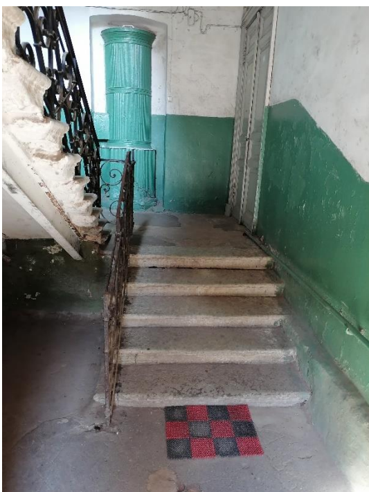
22. «Жилой дом» в составе объекта культурного наследия регионального значения «Комплекс военного городка Лужского Сергиевского артиллерийского полигона», Ленинградская область, Лужский район, г. Луга-3, 1-й полигон, тер. в/г №3, д.3/42. Лестничная клетка №1. Общий вид. Фото 01.08.2023г.
