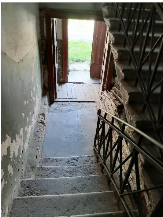
21. «Жилой дом» в составе объекта культурного наследия регионального значения «Комплекс военного городка Лужского Сергиевского артиллерийского полигона», Ленинградская область, Лужский район, г. Луга-3, 1-й полигон, тер. в/г №3, д.3/42. Лестничная клетка №1. Общий вид. Фото 01.08.2023г.
