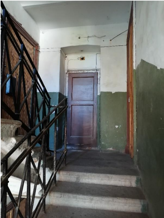
32. «Жилой дом» в составе объекта культурного наследия регионального значения «Комплекс военного городка Лужского Сергиевского артиллерийского полигона», Ленинградская область, Лужский район, г. Луга-3, 1-й полигон, тер. в/г №3, д.3/42. Лестничная клетка №2. Общий вид. Фото 01.08.2023г.
