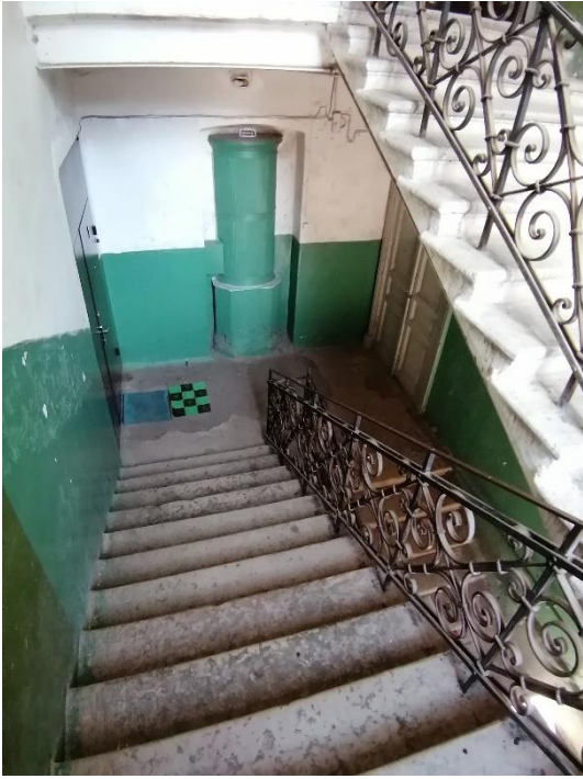
25. «Жилой дом» в составе объекта культурного наследия регионального значения «Комплекс военного городка Лужского Сергиевского артиллерийского полигона», Ленинградская область, Лужский район, г. Луга-3, 1-й полигон, тер. в/г №3, д.3/42. Лестничная клетка №1. Общий вид. Фото 01.08.2023г.
