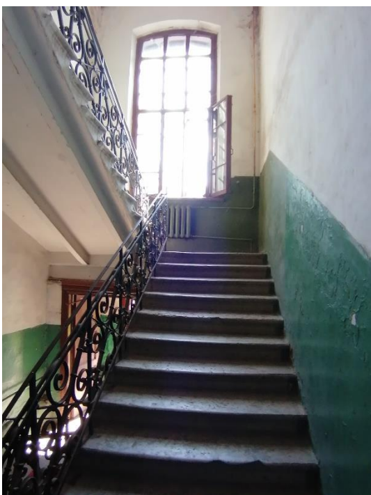
24. «Жилой дом» в составе объекта культурного наследия регионального значения «Комплекс военного городка Лужского Сергиевского артиллерийского полигона», Ленинградская область, Лужский район, г. Луга-3, 1-й полигон, тер. в/г №3, д.3/42. Лестничная клетка №1. Общий вид. Фото 01.08.2023г.
