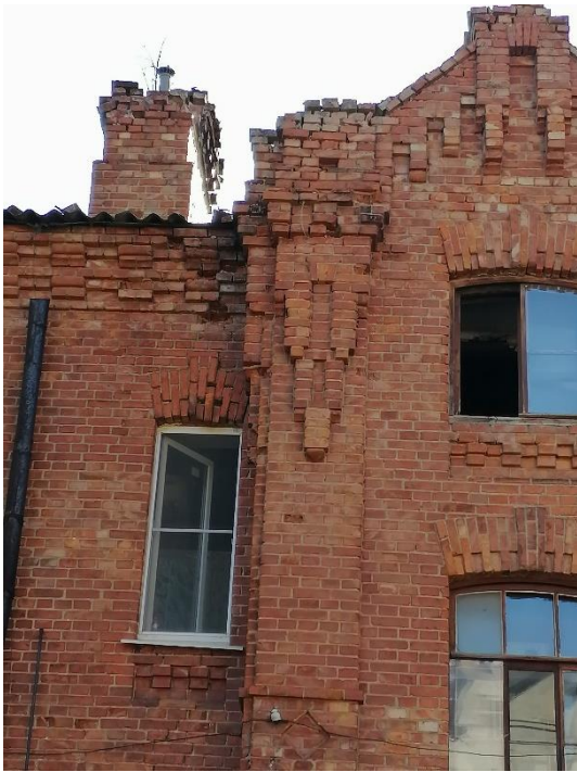
15. «Жилой дом» в составе объекта культурного наследия регионального значения «Комплекс военного городка Лужского Сергиевского артиллерийского полигона», Ленинградская область, Лужский район, г. Луга-3, 1-й полигон, тер. в/г №3, д.3/42. Северо-восточный фасад. Фрагмент. Фото 01.08.2023г.
