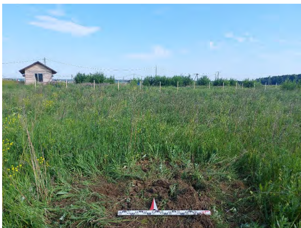
Илл. 103. Ленинградская обл., Ломоносовский район, Лопухинское и Гостилицкое сельские поселения – 2023 г. Шурф №10. Засыпка. Вид с Ю.
