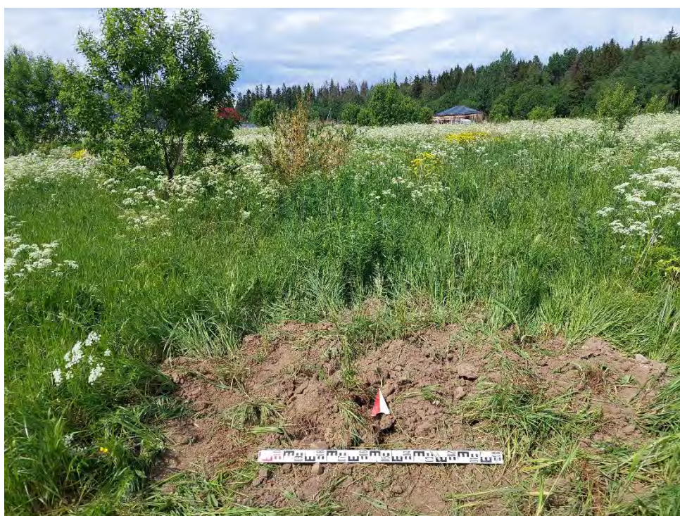
Илл. 52. Ленинградская обл., Ломоносовский район, Лопухинское и Гостилицкое сельские поселения – 2023 г. Шурф №4. Засыпка. Вид с Ю.
