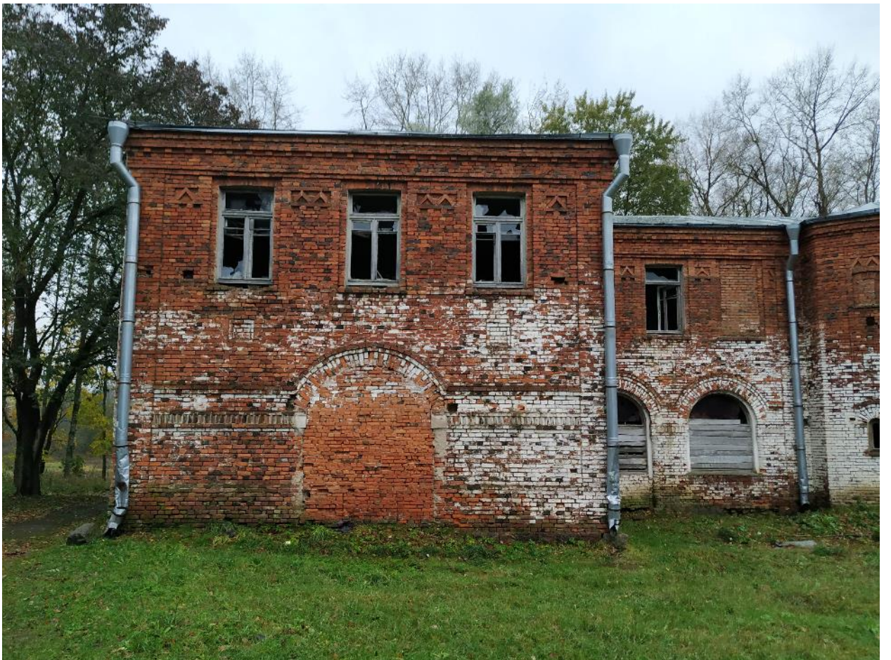
Фото 6. 06 Октября 2023г. Южное крыло, восточный фасад в осях 29/27.
