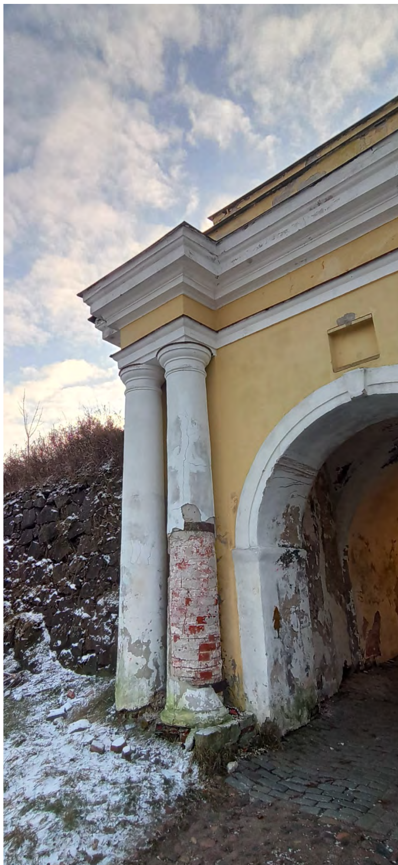
Фото 8. 20 ноября 2023 г. Ворота Фридрихсгамские 1-е. Северный фасад, фрагмент, восточная пара колонн с антаблементом
