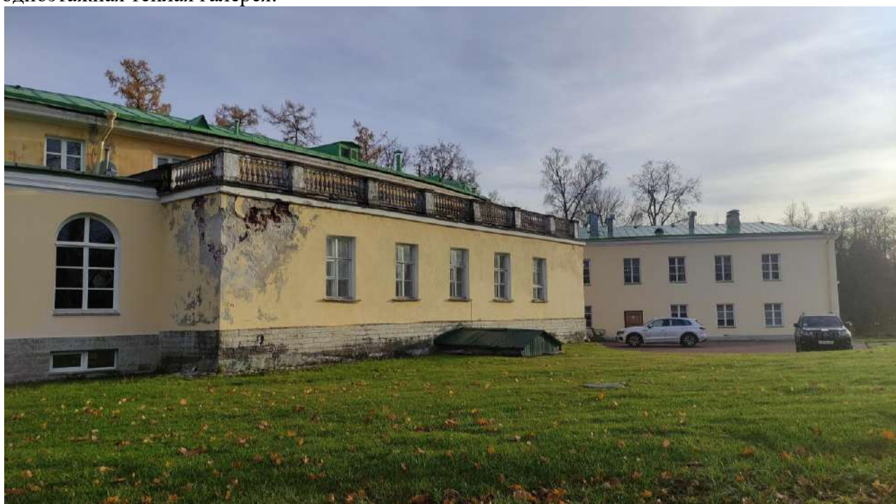
Фото 27. Объект культурного наследия федерального значения «Усадьба Строгановых (Марьино)», расположенный по адресу: Ленинградская область, Госненский муниципальный район, дер. Андрианово, д. 72. Фрагмент северного фасада усадебного дома. Разрушения штукатурного слоя и облицовки цоколя западного ризалита.
