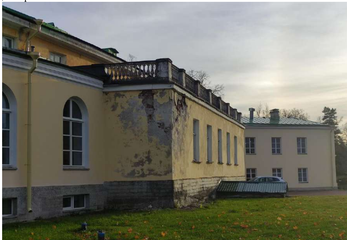
Фото 29. Объект культурного наследия федерального значения «Усадьба Строгановых (Марьино)», расположенный по адресу: Ленинградская область, Госненский муниципальный район, дер. Андрианово, д. 72. Разрушения штукатурного слоя и облицовки цоколя западного ризалита, подсос влаги.
