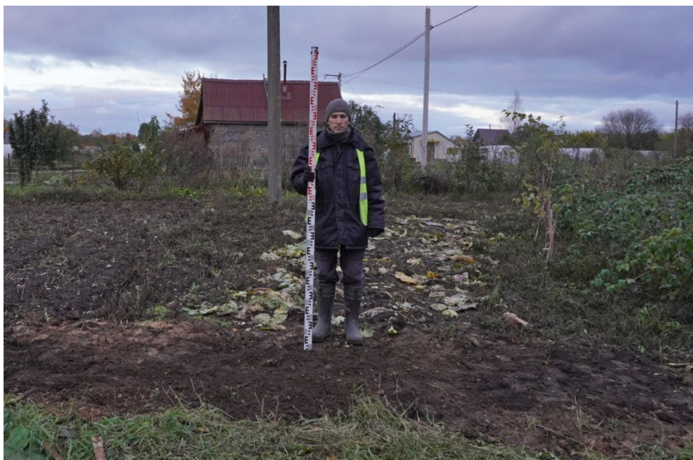
Рис. 50. Ленинградская область, Волховский район, «Распределительный газопровод и газопроводы-вводы в с. Старая Ладога». Участок 1. Шурф 5. Рекультивация. Вид с Ю.
