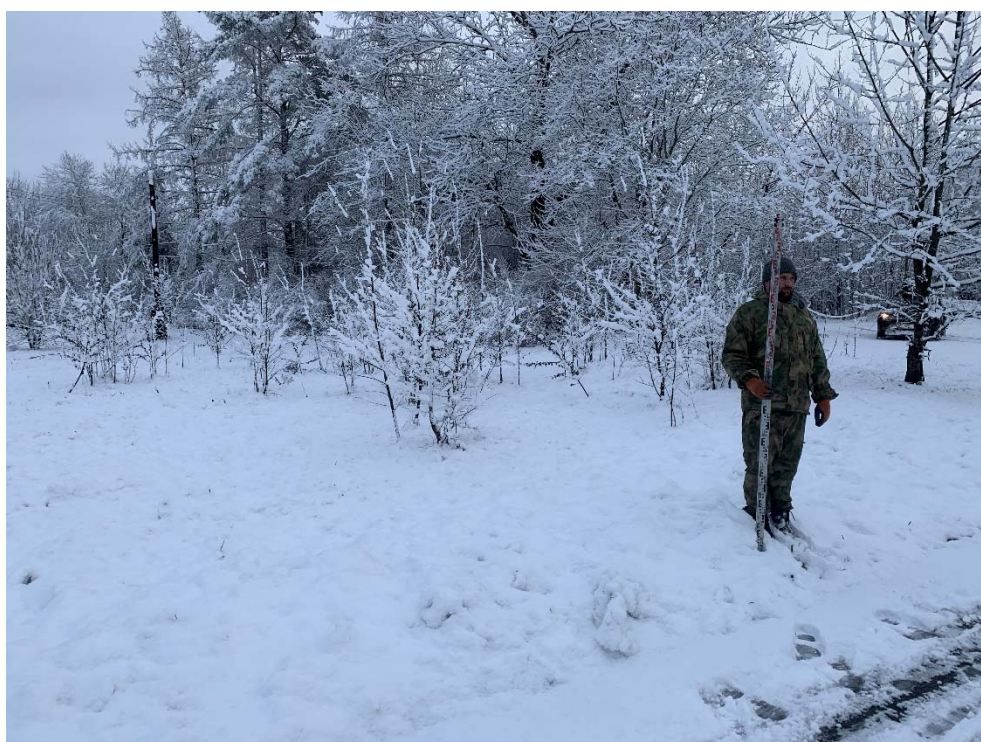
Рис. 191. Ленинградская область, Волховский район, «Распределительный газопровод и газопроводы-вводы в с. Старая Ладога». Участок 3-3. Точка фотофиксации 63. Вид с СЗ.
