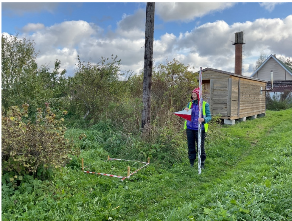
Рис. 52. Ленинградская область, Волховский район, «Распределительный газопровод и газопроводы-вводы в с. Старая Ладога». Участок 1. Шурф 6. Общий вид до начала работ с ЮЗ.
