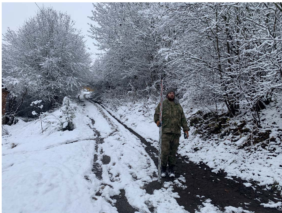
Рис. 134. Ленинградская область, Волховский район, «Распределительный газопровод и газопроводы-вводы в с. Старая Ладога». Участок 3-2. Точка фотофиксации 37. Вид с СВ.
