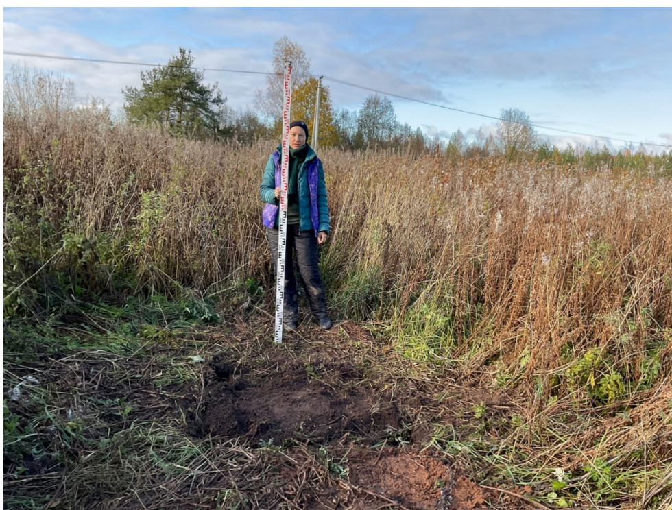
Рис. 23. Ленинградская область, Волховский район, «Распределительный газопровод и газопроводы-вводы в с. Старая Ладога». Участок 1. Шурф 2. Рекультивация. Вид с 3.
