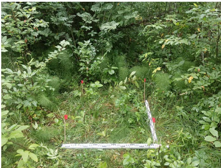
Рис. 25. Ленинградская область, Всеволожский район, «Межпоселковый газопровод до д. Резвых, д. Черная Речка Всеволожского района». 2023 г. Шурф 1. Место закладки. Вид с Ю.
