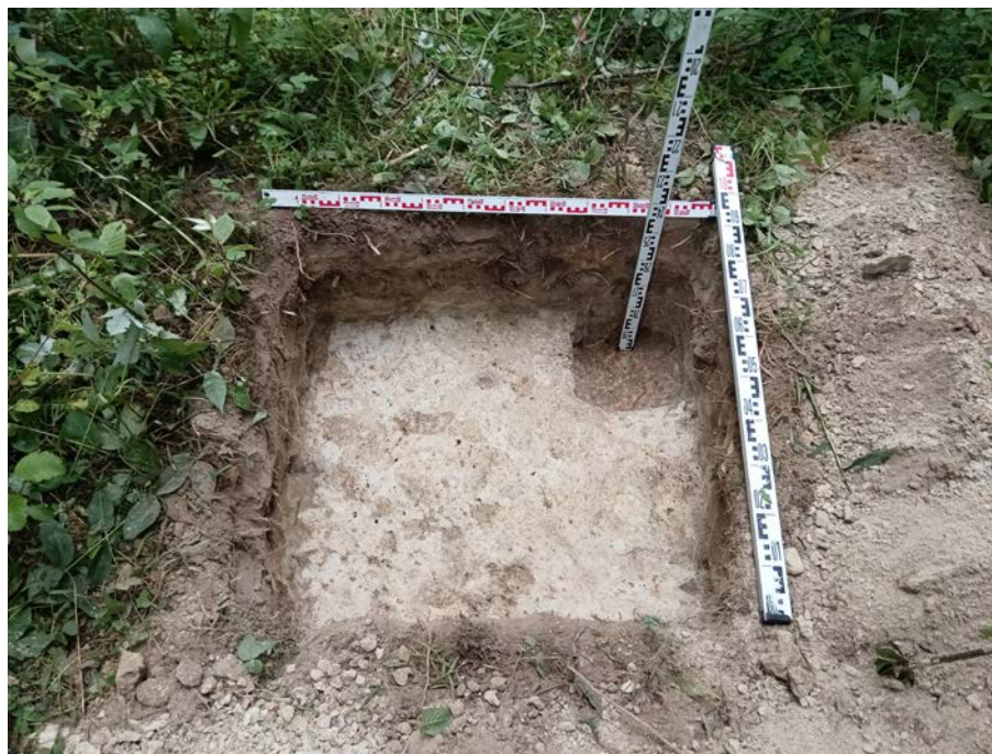
Рис. 37. Ленинградская область, Всеволожский район, «Межпоселковый газопровод до д. Резвых, д. Черная Речка Всеволожского района». 2023 г. Шурф 2. Зачистка по материку. Вид с Ю
