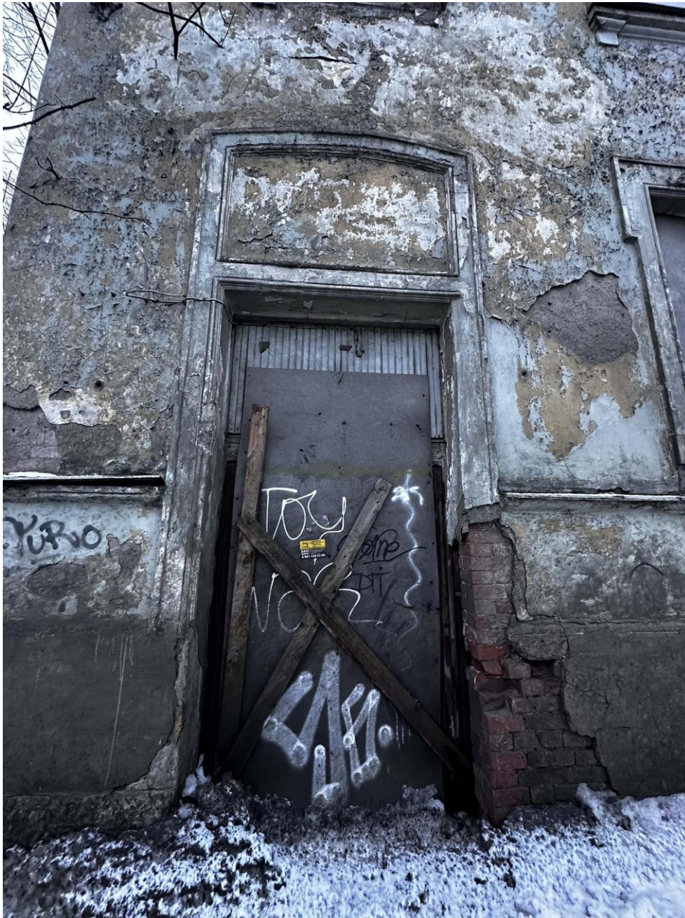
Фото 5. Фрагмент лицевого северо-восточного фасада. Левая часть 1-го этажа. Дата съемки: 28.12.2022 г. Автор съемки: Глинская Н.Б.
