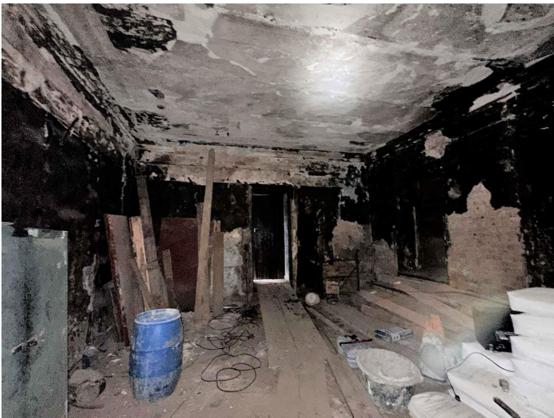
Фото 23. Пом. 1.1. Общий вид помещения с юго-востока. Дата съемки: 28.12.2022 г. Автор съемки: Глинская Н.Б.
