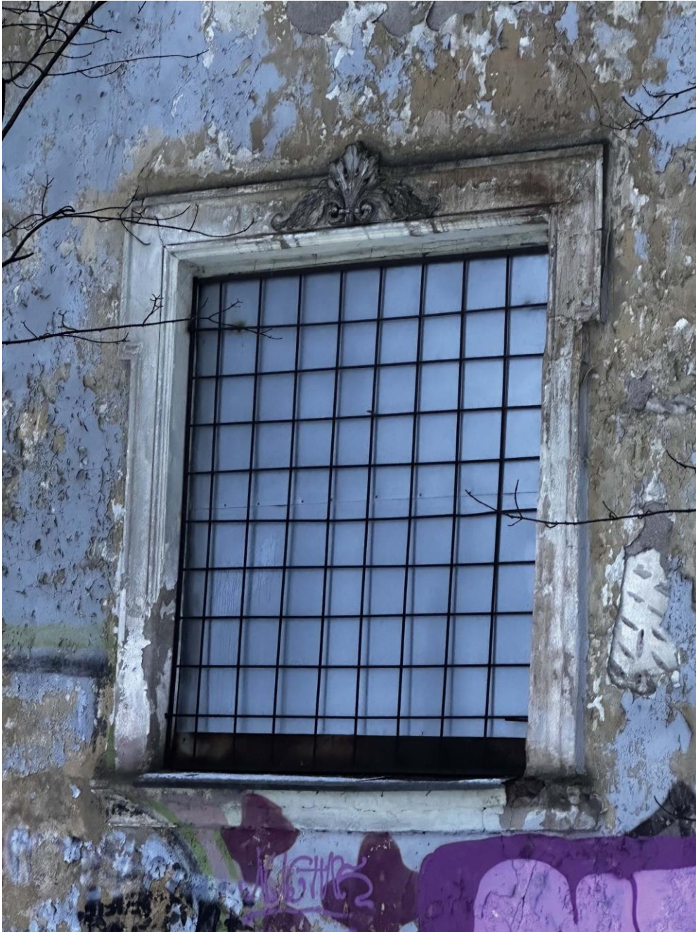
Фото 21. Фрагмент центральной части юго-восточного фасада юго-восточной исторической пристройки здания. Дата съемки: 28.12.2022 г. Автор съемки: Глинская Н.Б.
