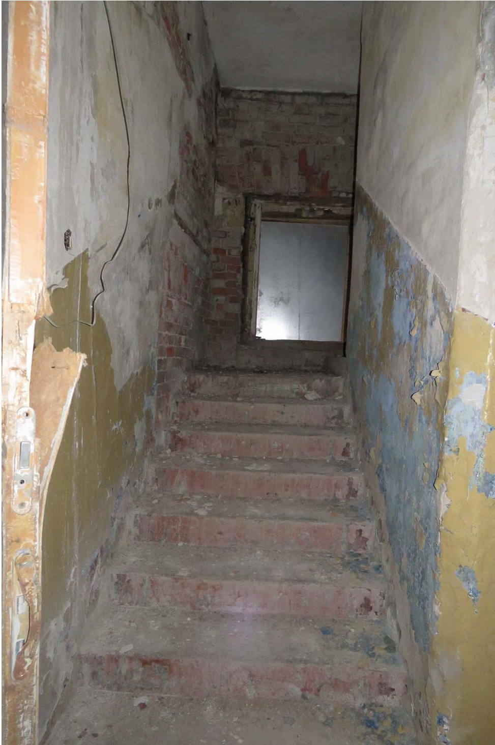
Фото 71. Промежуточный марш лестничной клетки ЛК-3. Дата съемки: 28.12.2022 г. Автор съемки: Глинская Н.Б.
