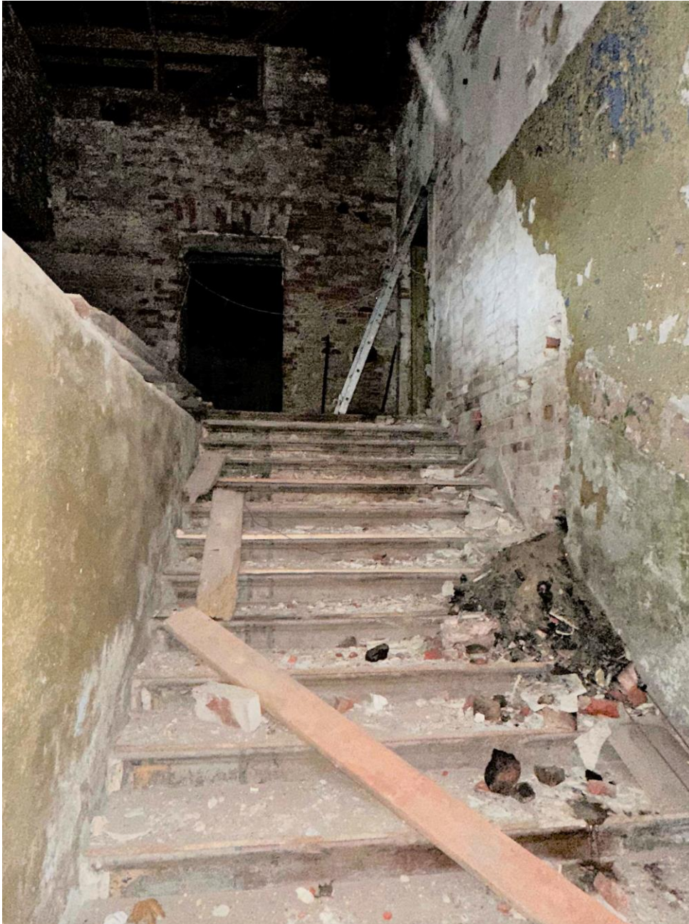
Фото 65. Верхний марш лестничной клетки ЛК-1. Дата съемки: 28.12.2022 г. Автор съемки: Глинская Н.Б.
