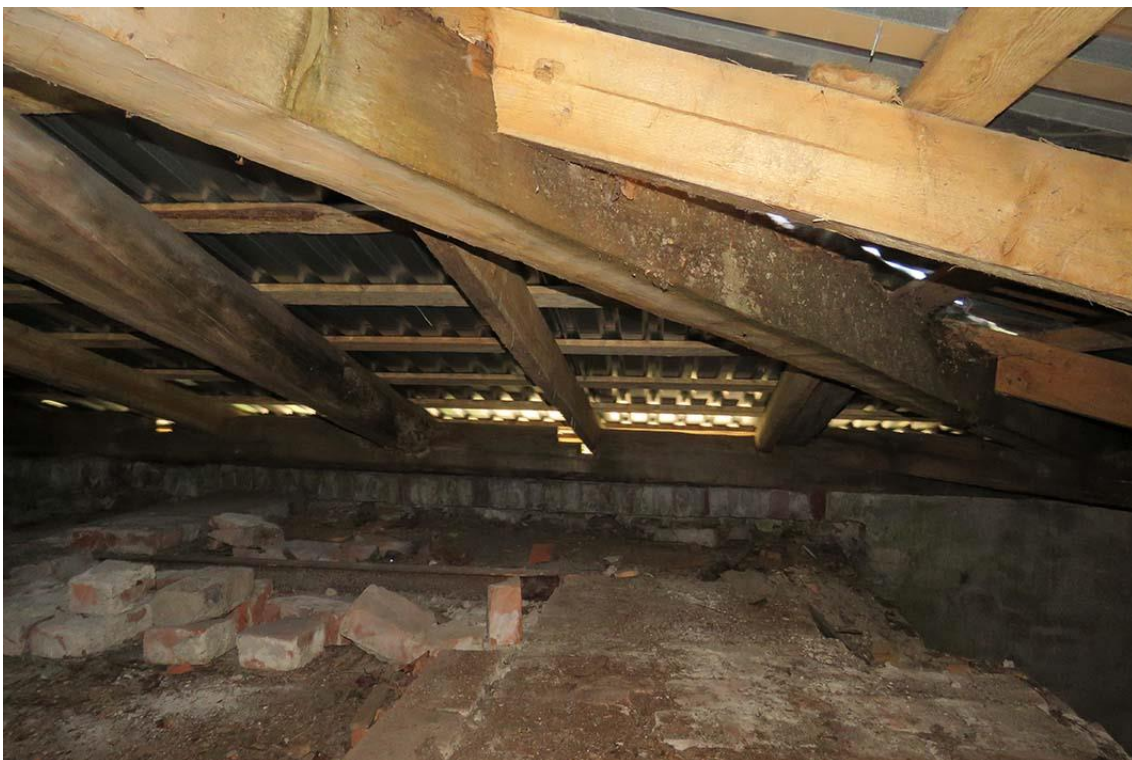
Фото 73. Фрагмент юго-западного ската крыши у лестничной клетки ЛК-3. Дата съемки: 28.12.2022 г. Автор съемки: Глинская Н.Б.
