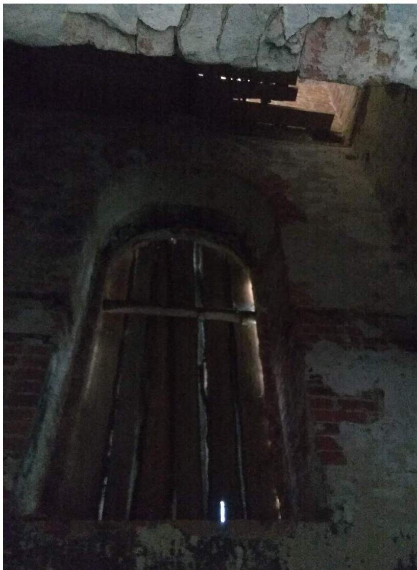
10. Объект культурного наследия регионального значения «Церковь Георгия «Суворовская» (деревянная), XVIII в.» по адресу: Ленинградская область, Волховский район, г. Новая Ладога, ул. Суворова, д. 14Б. Каменная часть церкви. Фрагмент интерьера. Оконный проем.
