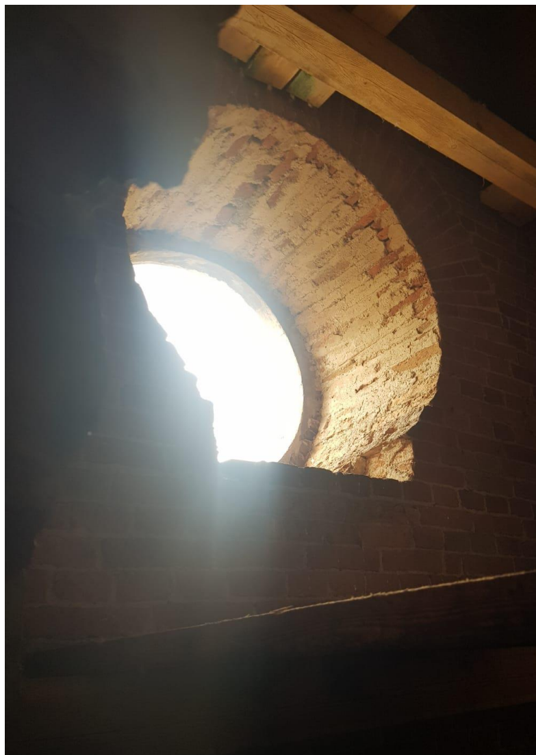
6. Объект культурного наследия регионального значения «Церковь Георгия «Суворовская» (деревянная), XVIII в.» по адресу: Ленинградская область, Волховский район, г. Новая Ладога, ул. Суворова, д. 14Б. Каменная часть храма. Колокольня. Оконный проем. Вид из интерьера.
