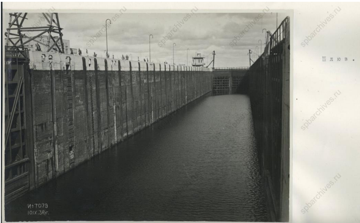
Илл. 9. Фотографии из акта комиссии СНК СССР по приему Нижне-Свирской ГЭС (Свирь-3) и шлюза в промышленную эксплуатацию. Шлюз Нижне-Свирской ГЭС (Свирь-3). 10 сентября 1936 г. // ЦГАИПД СПб. ф.Р-24. оп.2 в. д.1691. л.125.
