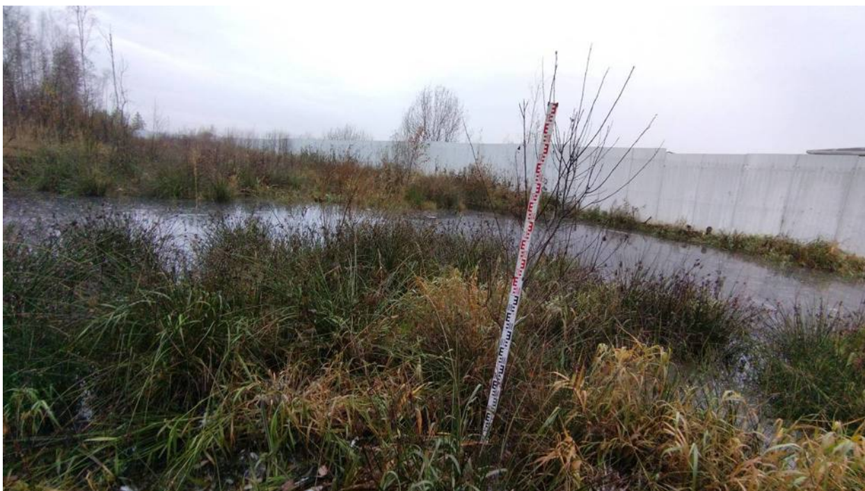
Рис. 24. Ленинградская обл., Всеволожский р-н, Щеглово-2023. Точка фотофиксации 3. Вид с северо-востока. Для масштаба использована рейка длиной 2 м.
