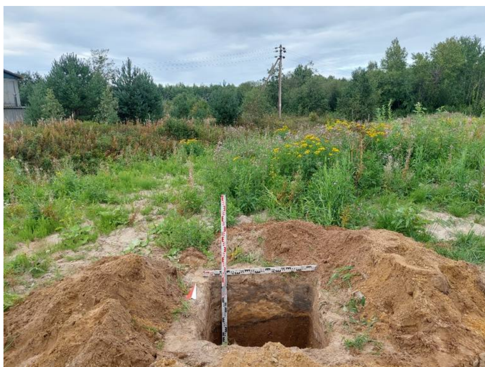
Илл. 81. Ленинградская обл., Кировский район, Газопровод межпоселковый к д. Кобона Кировского района Ленинградской области. Шурф №9. Вскрытый. Вид с Ю.
