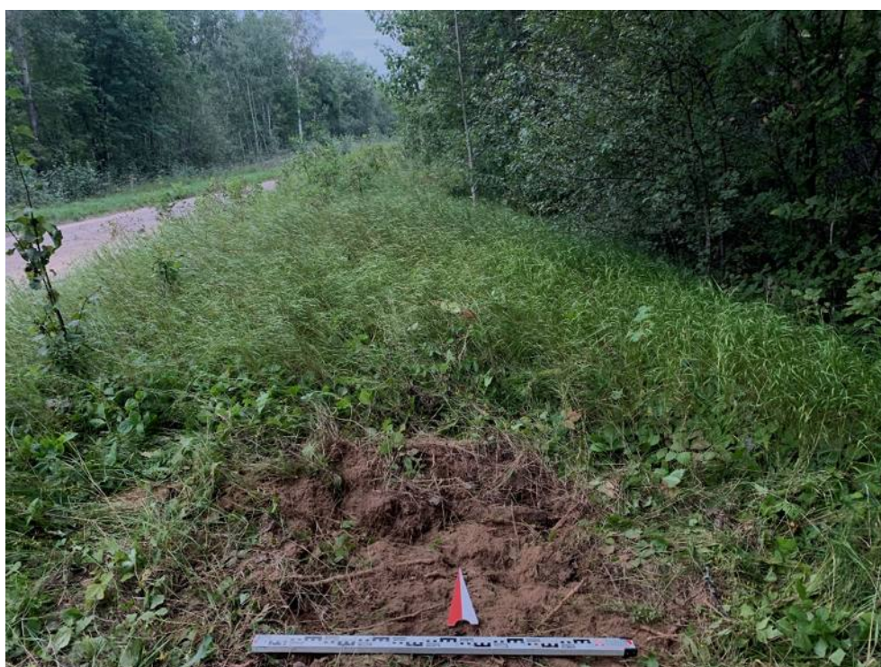
Илл. 153. Ленинградская обл., Кировский район, Газопровод межпоселковый к д. Кобона Кировского района Ленинградской области. Шурф №18. Засыпка. Вид с Ю.
