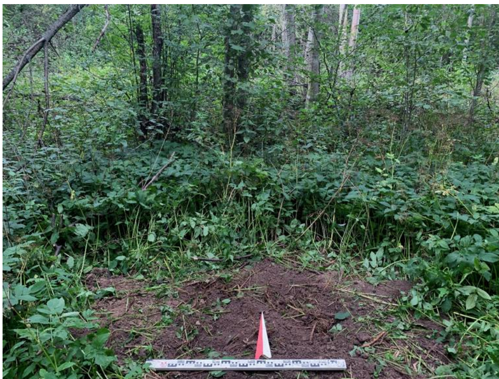
Илл. 104. Ленинградская обл., Кировский район, Газопровод межпоселковый к д. Кобона Кировского района Ленинградской области. Шурф №13. Засыпка. Вид с Ю.
