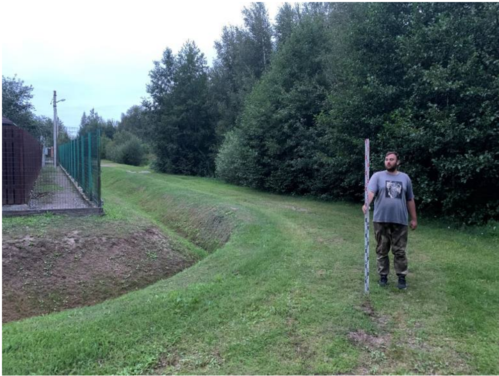
Илл. 138. Ленинградская обл., Кировский район, Газопровод межпоселковый к д. Кобона Кировского района Ленинградской области. Точка фотофиксации №18. Вид с Ю.
