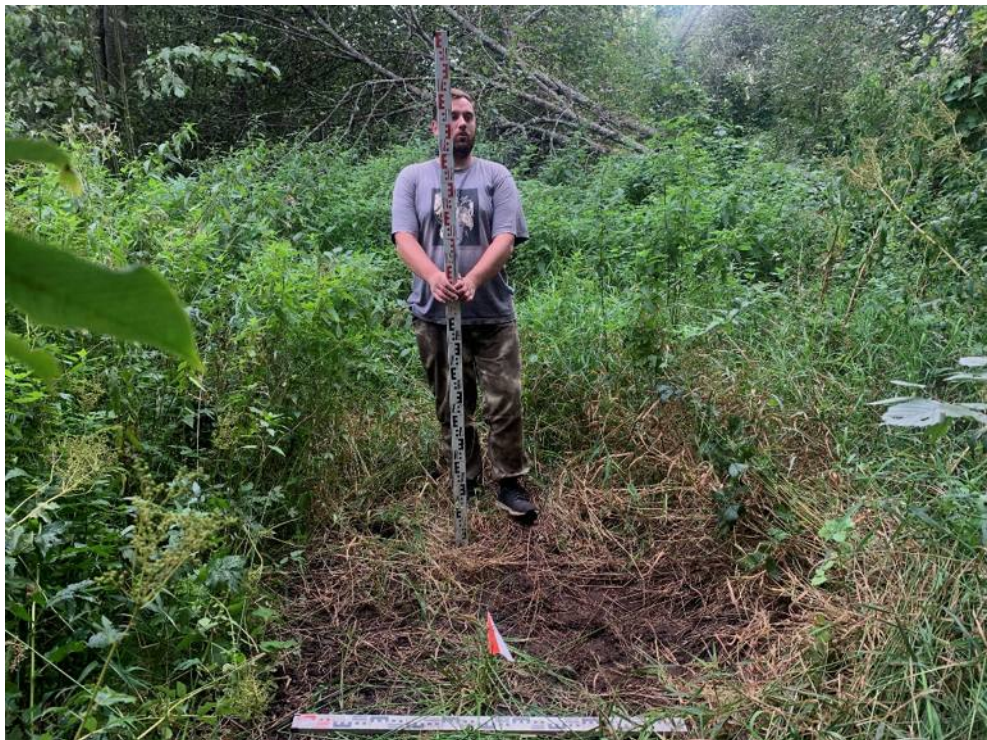
Илл. 95. Ленинградская обл., Кировский район, Газопровод межпоселковый к д. Кобона Кировского района Ленинградской области. Шурф №12. Местоположение. Вид с Ю.
