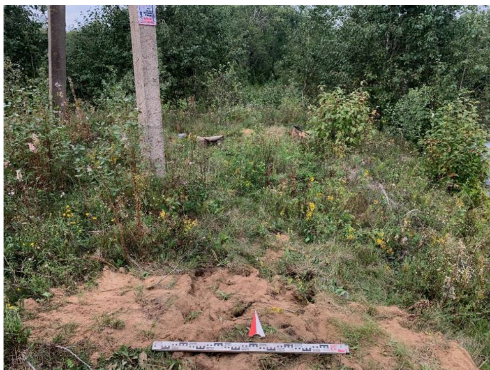
Илл. 89. Ленинградская обл., Кировский район, Газопровод межпоселковый к д. Кобона Кировского района Ленинградской области. Шурф №10. Засыпка. Вид с Ю.
