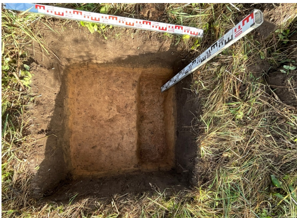
Рис. 17. Ленинградская область, Волховский район, «Распределительный газопровод и газопроводы-вводы в с. Старая Ладога». Участок 1. Шурф 1. Вид сверху и с Ю. Зачистка по материке и контрольный прокоп.
