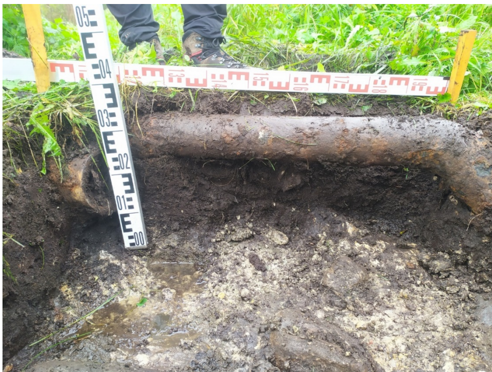
Рис. 54. Ленинградская область, Волховский район, «Распределительный газопровод и газопроводы-вводы в с. Старая Ладога». Участок 1. Шурф 6. Северная стенка. Вид с Ю.
