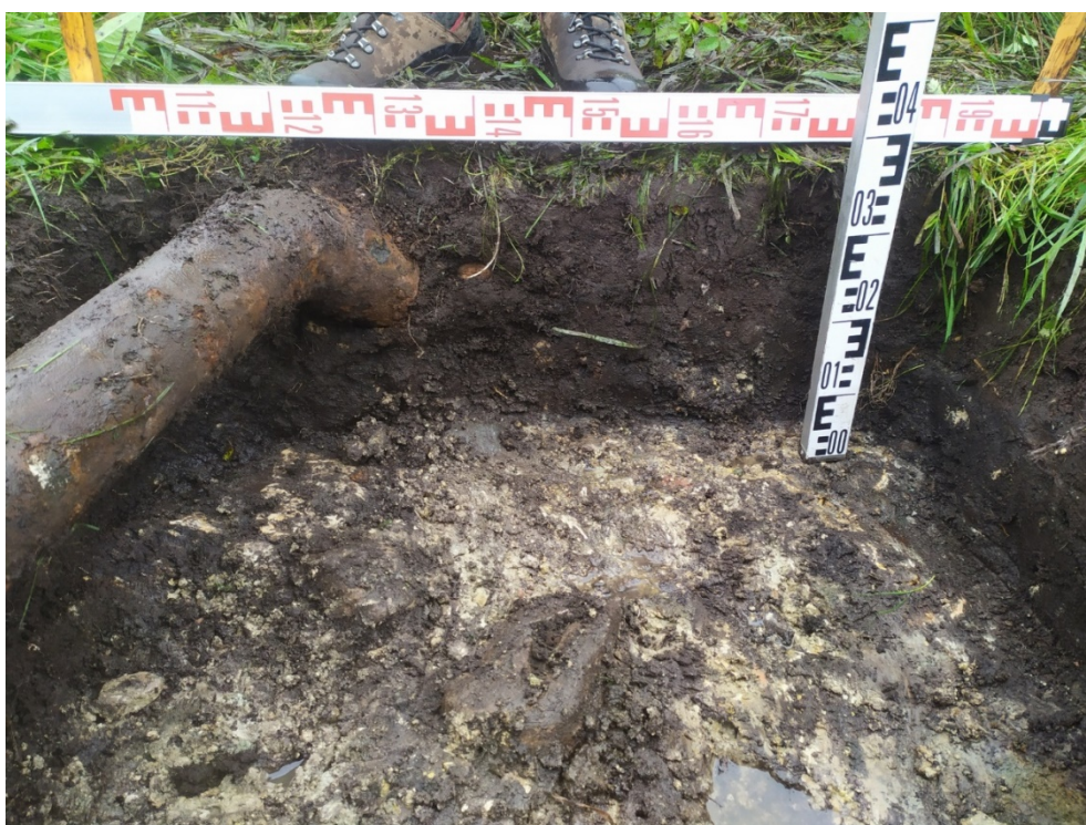
Рис. 55. Ленинградская область, Волховский район, «Распределительный газопровод и газопроводы-вводы в с. Старая Ладога». Участок 1. Шурф 6. Восточная стенка. Вид с З.
