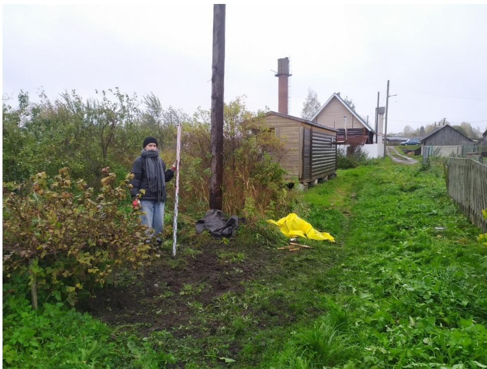
Рис. 59. Ленинградская область, Волховский район, «Распределительный газопровод и газопроводы-вводы в с. Старая Ладога». Участок 1. Шурф 6. Рекультивация. Вид с ЮЗ.
