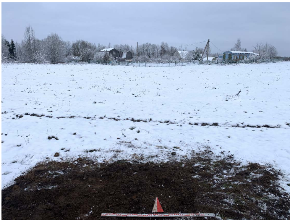
Илл. 36. Ленинградская область, Гатчинский район. 2023 г. «Межпоселковый газопровод от д. Алексеевка – д. Луйсовицы – д. Таровицы – д. Дубицы с отводом на д. Волгово Гатчинского района». Шурф №3. Рекультивация. Вид с Ю.
