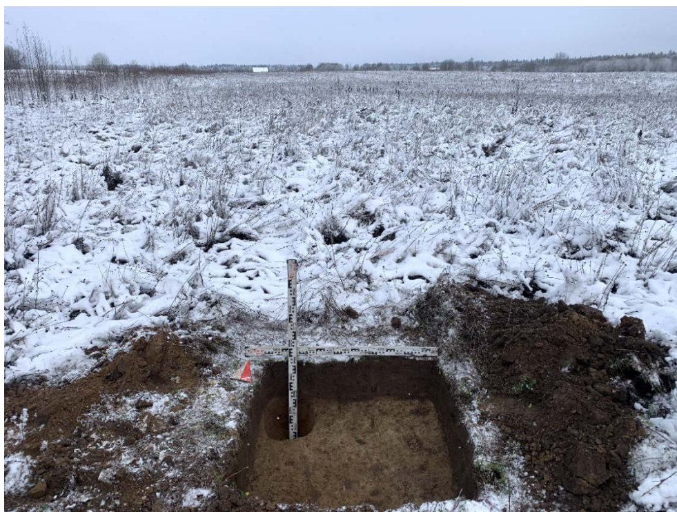
Илл. 19. Ленинградская область, Гатчинский район. 2023 г. «Межпоселковый газопровод от д. Алексеевка – д. Луйсковичи – д. Таровицы – д. Дубицы с отводом на д. Волгово Гатчинского района». Шурф №1. Зачистка по материке. Общий вид с Ю.
