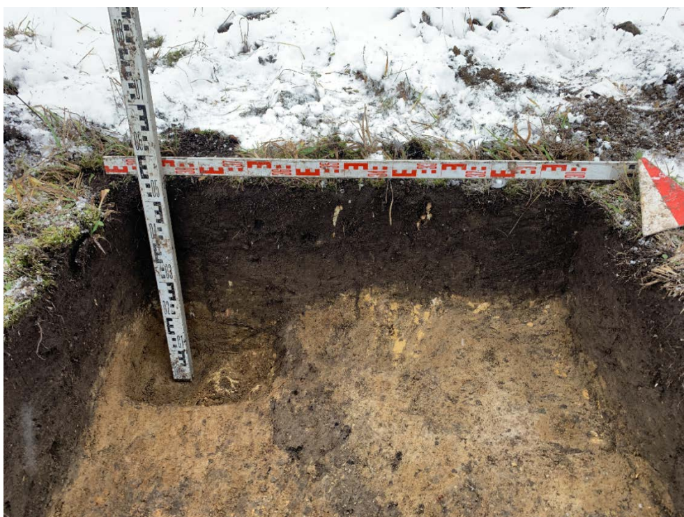
Илл. 55. Ленинградская область, Гатчинский район. 2023 г. «Межпоселковый газопровод от д. Алексеевка – д. Луйсовицы – д. Таровицы – д. Дубицы с отводом на д. Волгово Гатчинского района». Шурф №5. Северная стенка и контрольный прокоп. Вид с Ю.
