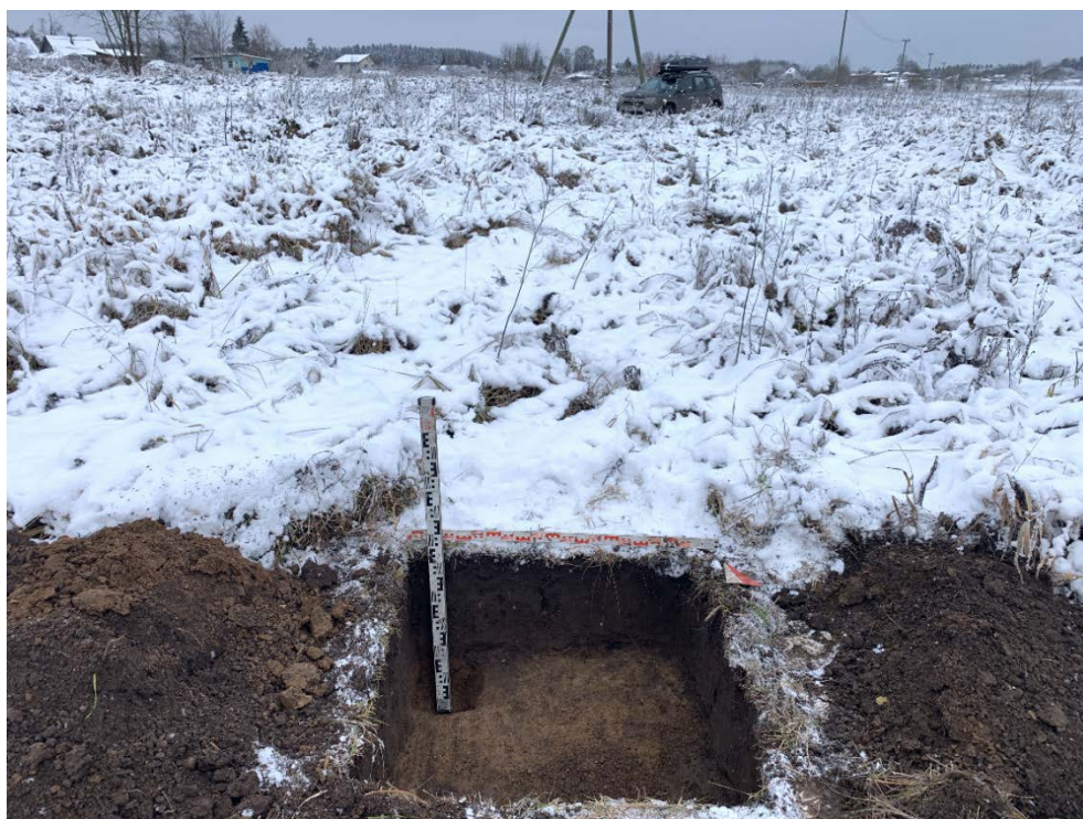
Илл. 61. Ленинградская область, Гатчинский район. 2023 г. «Межпоселковый газопровод от д. Алексеевка – д. Луйсовицы – д. Таровицы – д. Дубицы с отводом на д. Волгово Гатчинского района». Шурф №6. Зачистка по материке. Общий вид с Ю.
