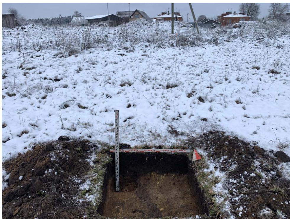
Илл. 53. Ленинградская область, Гатчинский район. 2023 г. «Межпоселковый газопровод от д. Алексеевка – д. Луйсковичи – д. Таровицы – д. Дубицы с отводом на д. Волгово Гатчинского района». Шурф №5. Зачистка по материке. Общий вид с Ю.
