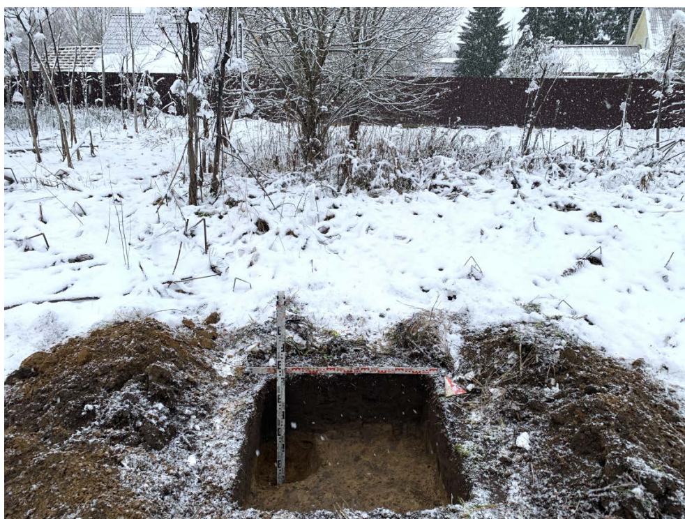
Илл. 29. Ленинградская область, Гатчинский район. 2023 г. «Межпоселковый газопровод до д. Авколево с отводом д. Вероланцы Гатчинского района». Шурф №2. Зачистка по матерiku. Общий вид с Ю.
