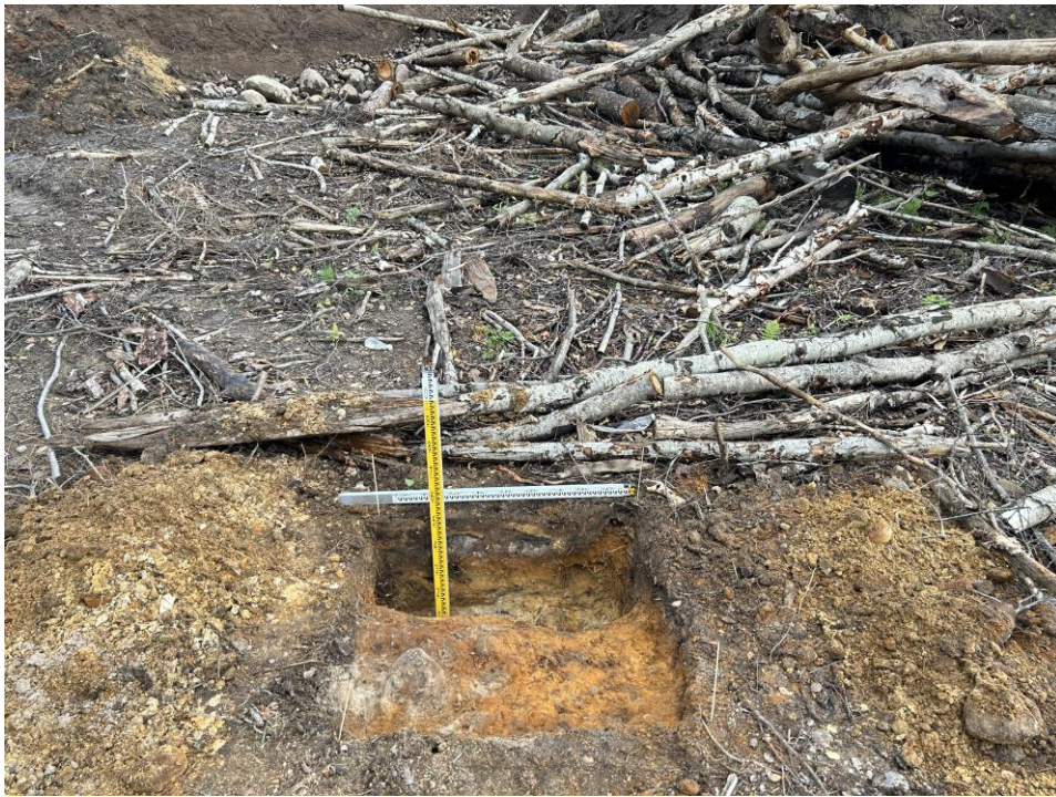
Илл. 17. Пос. им. Морозова. Земельный участок кад. номер 47:07:1703021:150. Шурф 1 в ходе земляных работ. Вид с юга.
