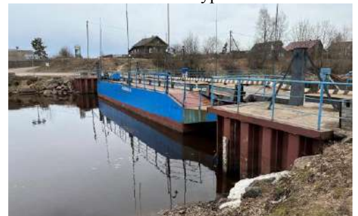
Вид на мост через Новолоджский канал с западной стороны в г. Новой Ладоге
