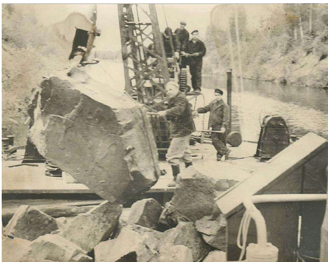
Илл. 60. Новолодожский канал («Работа крана №2 на Белом Камне»). 1960 г. Работы по ремонту откосов канала
