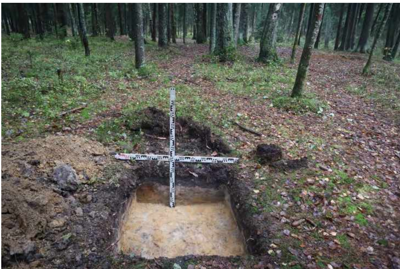
Рис. 124. Ленинградская область, Всеволожский район. «Рекреационно - досуговый парк, расположенный по адресу: Ленинградская область, Всеволожский муниципальный район, г.п. Токсово, ул. Некрасова». Шурф 19. Общий вид. Вид с юга
