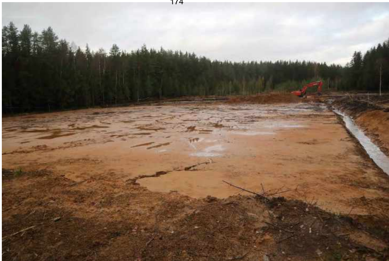
Рис. 47. Ленинградская область, Всеволожский район. «Рекреационно - досуговый парк, расположенный по адресу: Ленинградская область, Всеволожский муниципальный район, г.п. Токсово, ул. Некрасова». Земляные работы в западной части территории обследования. Вид с востока
