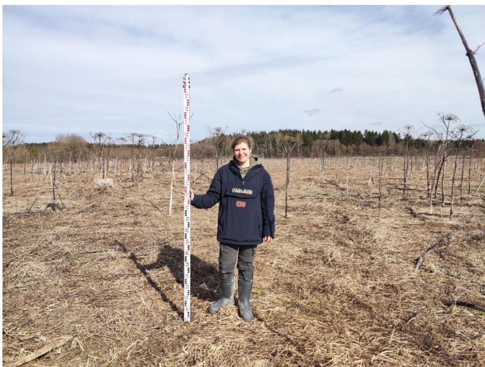
Илл. 52. Ленинградская область, Гатчинский район. 2024 г. «Межпоселковый газопровод до д. Эду – д. Ижора Гатчинского района». Шурф №3. Местоположение. Вид с Ю.
