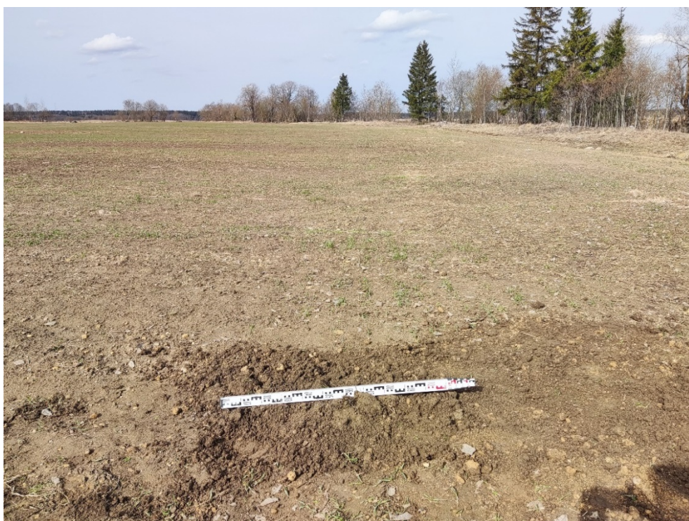
Илл. 36. Ленинградская область, Гатчинский район. 2024 г. «Межпоселковый газопровод до д. Эду – д. Ижора Гатчинского района». Шурф №2. Рекультивация. Вид с Ю.
