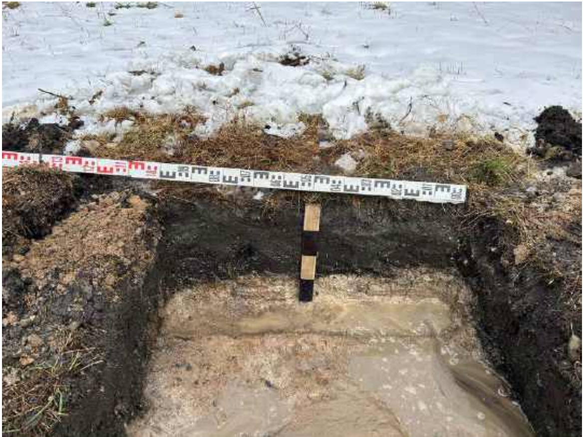
Рис.105. Земельный участок с кадастровым номером 47:07:0957004:2587 по адресу: Российская Федерация, Ленинградская область, Всеволожский муниципальный район, поселок Романовка. Северная стенка шурфа № 9 после прокопки, вид с юга.
