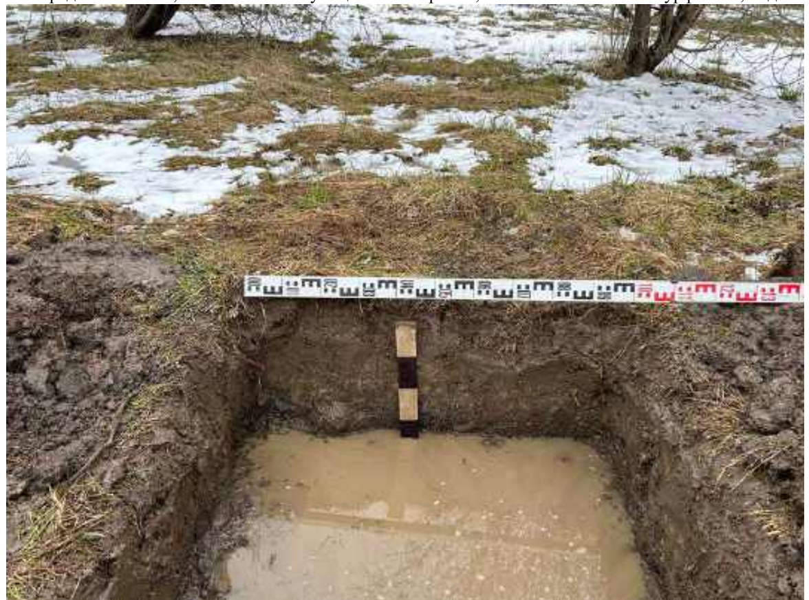
Рис.119. Земельный участок с кадастровым номером 47:07:0957004:2590 по адресу: Российская Федерация, Ленинградская область, Всеволожский муниципальный район, поселок Романовка. Северная стенка шурфа № 12, вид с юга.
