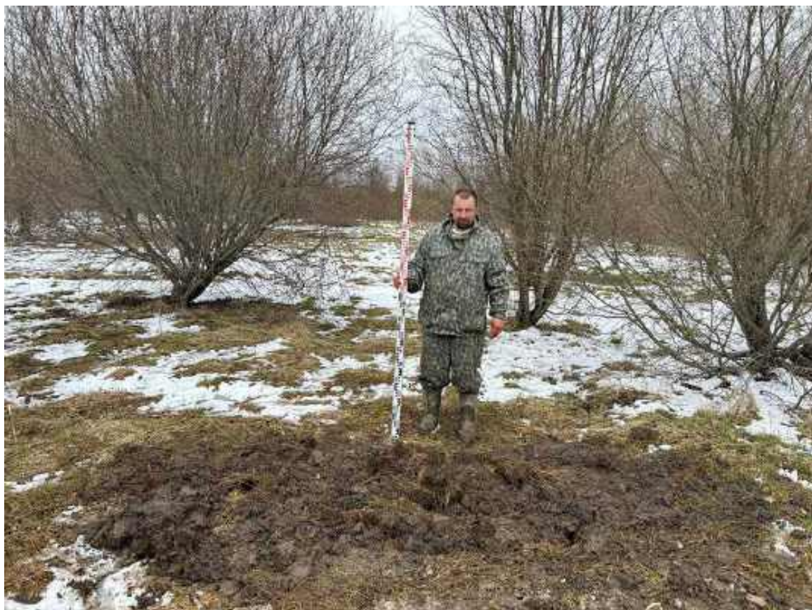
Рис.121. Земельный участок с кадастровым номером 47:07:0957004:2590 по адресу: Российская Федерация, Ленинградская область, Всеволожский муниципальный район, поселок Романовка. Шурф № 12 после рекультивации, вид с юга.
