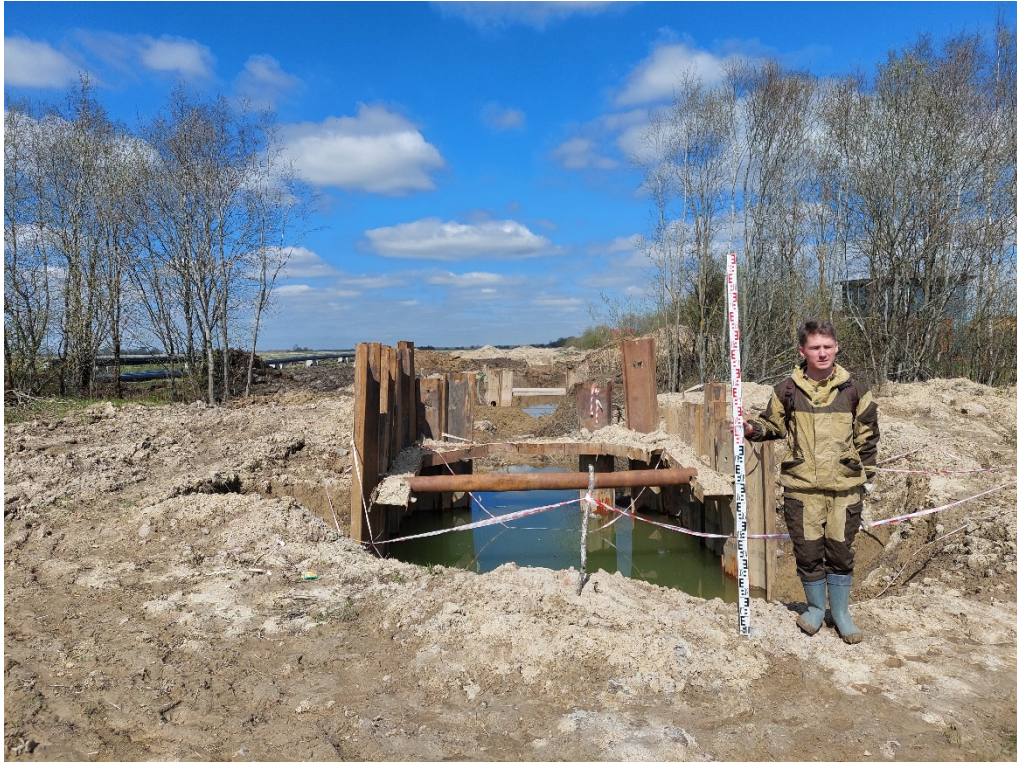
Илл. 41. Ленинградская область, Гатчинский район, Пудомягское сельское поселение – 2024 г. Точка фотофиксации №5. Вид с Ю.
