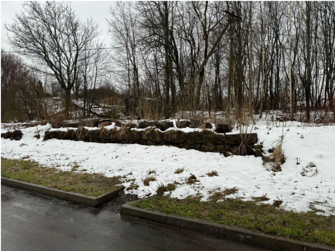
Фото 10. Фрагмент сохранившихся фундаментов дворового строения «Службы», входящего в имущественный состав комплекса "Дома жилые офицерские. Комплекс», 19 в. по данным госоргана охраны ОКН как «Службы», расположенного позади здания по ул. Островной, 4. Фото с северо-востока. Дата съемки: 25.04.2024 г. Автор съемки: Куваева Ю.П.
