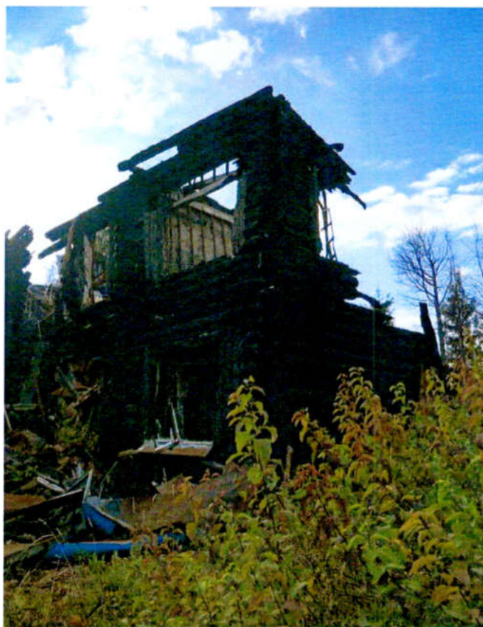
Фото 4. «Главный дом» деревянная часть здания после пожара.
