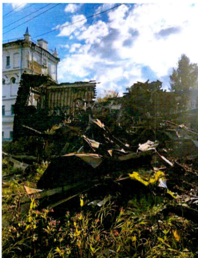
Фото 6. «Главный дом» деревянная часть здания после пожара.
