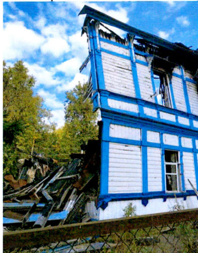
Фото 13. «Главный дом» сохранившаяся часть здания после пожара южный фасад.
