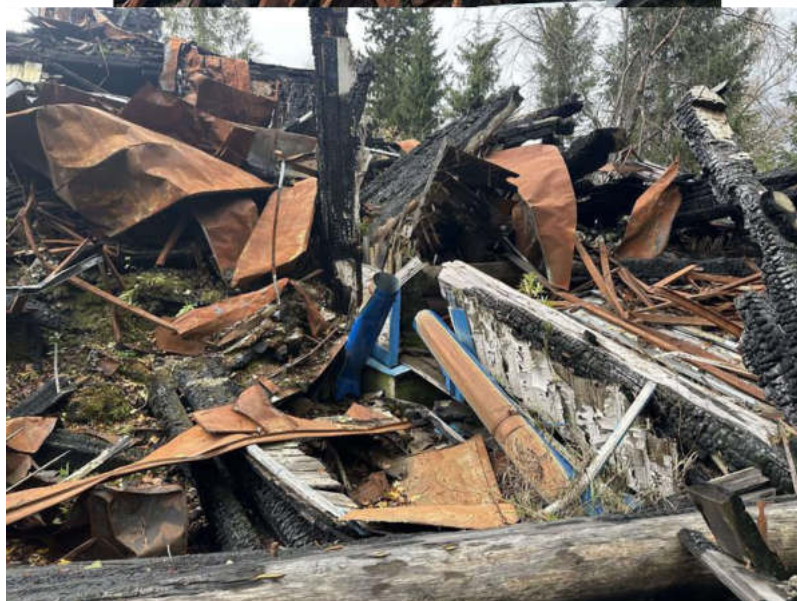
Фото 9. Главный дом. Следы пожара.
