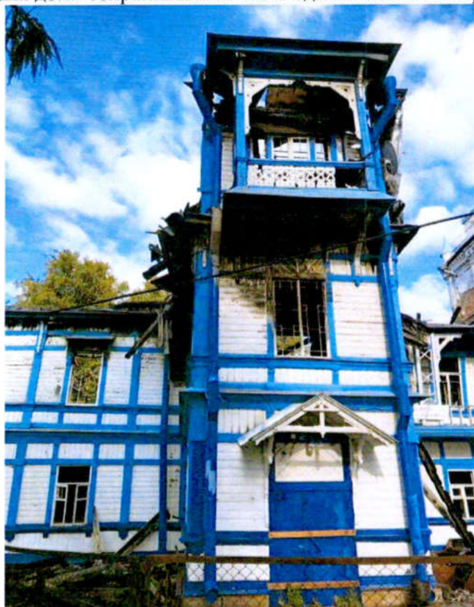
Фото 11. «Главный дом» сохранившаяся часть здания после пожара южный фасад.
