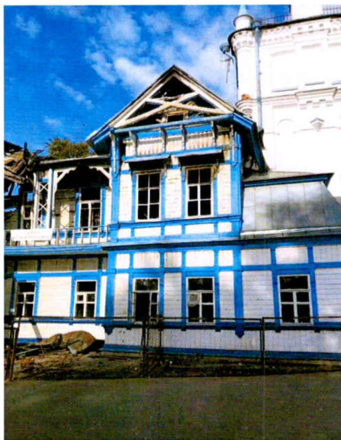
Фото 10. «Главный дом» сохранившаяся часть здания после пожара южный фасад.
