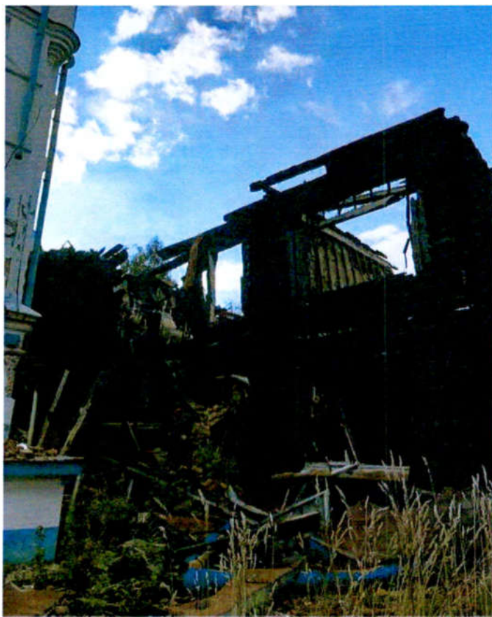
Фото 3. «Главный дом» часть здания после пожара.
