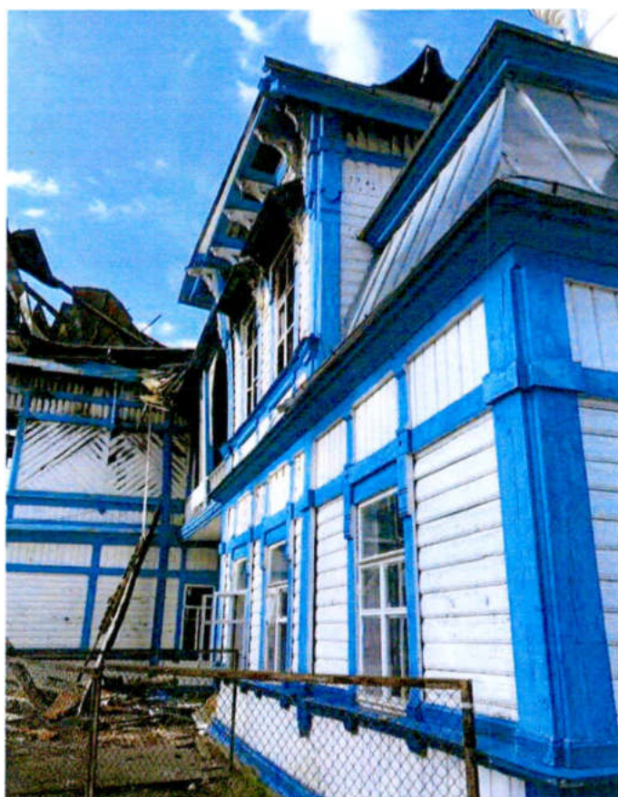
Фото 9. «Главный дом» сохранившаяся часть здания после пожара южный фасад.
