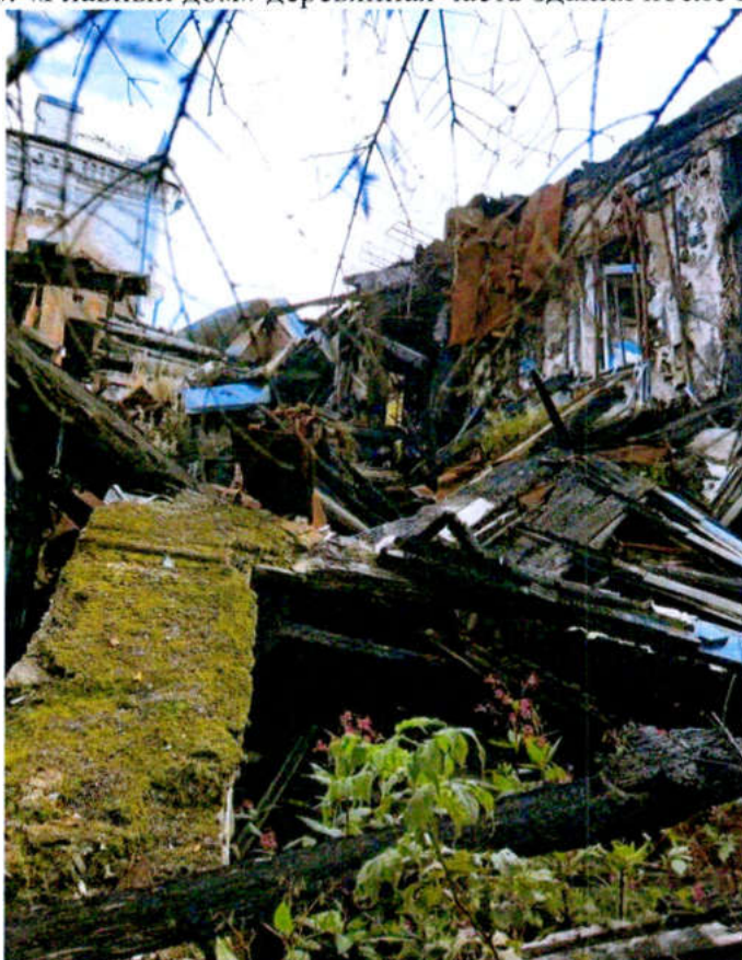
Фото 7. «Главный дом» деревянная часть здания после пожара.
