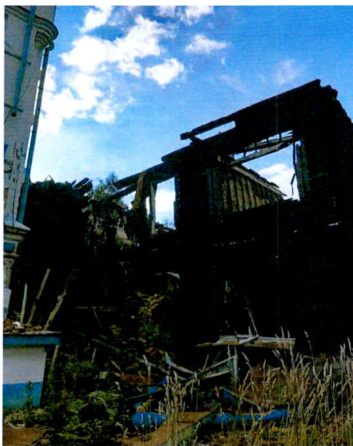
Фото 3. «Главный дом» часть здания после пожара.
