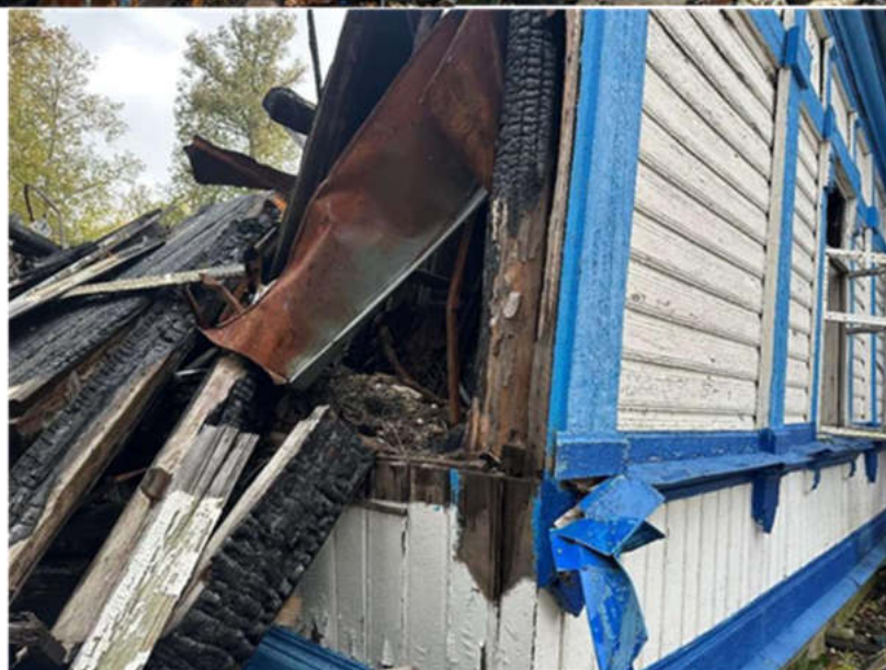
Фото 8. Главный дом. Следы пожара.
