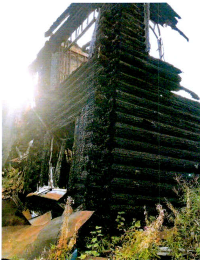
Фото 5. «Главный дом» деревянная часть здания после пожара.
