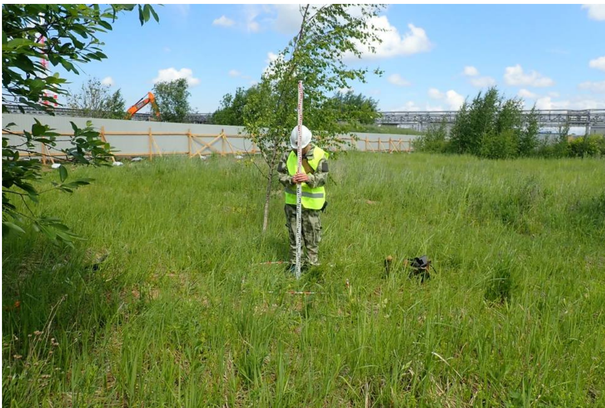
Рис. 17. Земельный участок с кадастровым номером 47:20:0752003:1224, расположенный по адресу: Ленинградская область, Кингисеппский муниципальный район, Большелуцкое сельское поселение, производственная площадка Фосфорит, участок 1 Место закладки шурфа № 1, вид с юга.
