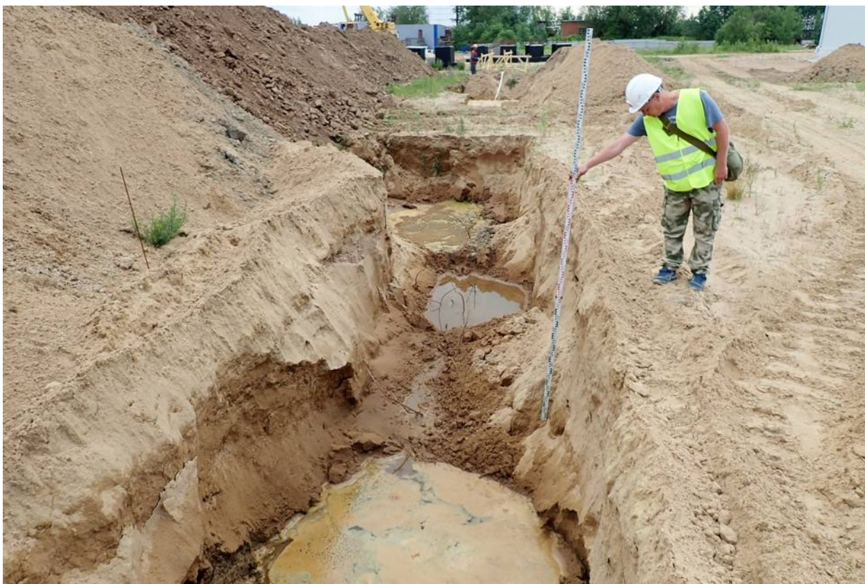
Рис. 13. Земельный участок с кадастровым номером 47:20:0752003:1224, расположенный по адресу: Ленинградская область, Кингисеппский муниципальный район, Большелуцкое сельское поселение, производственная площадка Фосфорит. Точка фотофиксации 3. Траншея с остатками фундамента в северной части участка. Вид с севера северо-востока.
