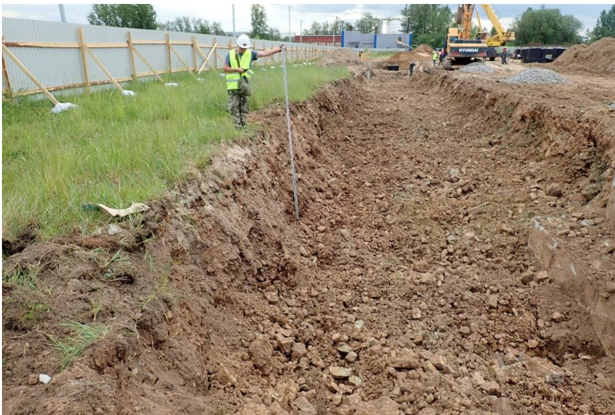
Рис. 15. Земельный участок с кадастровым номером 47:20:0752003:1224, расположенный по адресу: Ленинградская область, Кингисеппский муниципальный район, Большелуцкое сельское поселение, производственная площадка Фосфорит. Точка фотофиксации 5. Фундаментная траншея с откачанными грунтовыми водами в восточной части участка. Состав материкового грунта. Вид с севера северо-востока.
