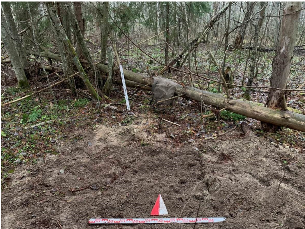
Илл. 68. Ленинградская область, Волховский район. 2024 г. «Газопровод межпоселковый от д. Самушкино – д. Шахново – д. Вороново Волховского района Ленинградской области». Шурф 5. Рекультивация. Вид с Ю.
