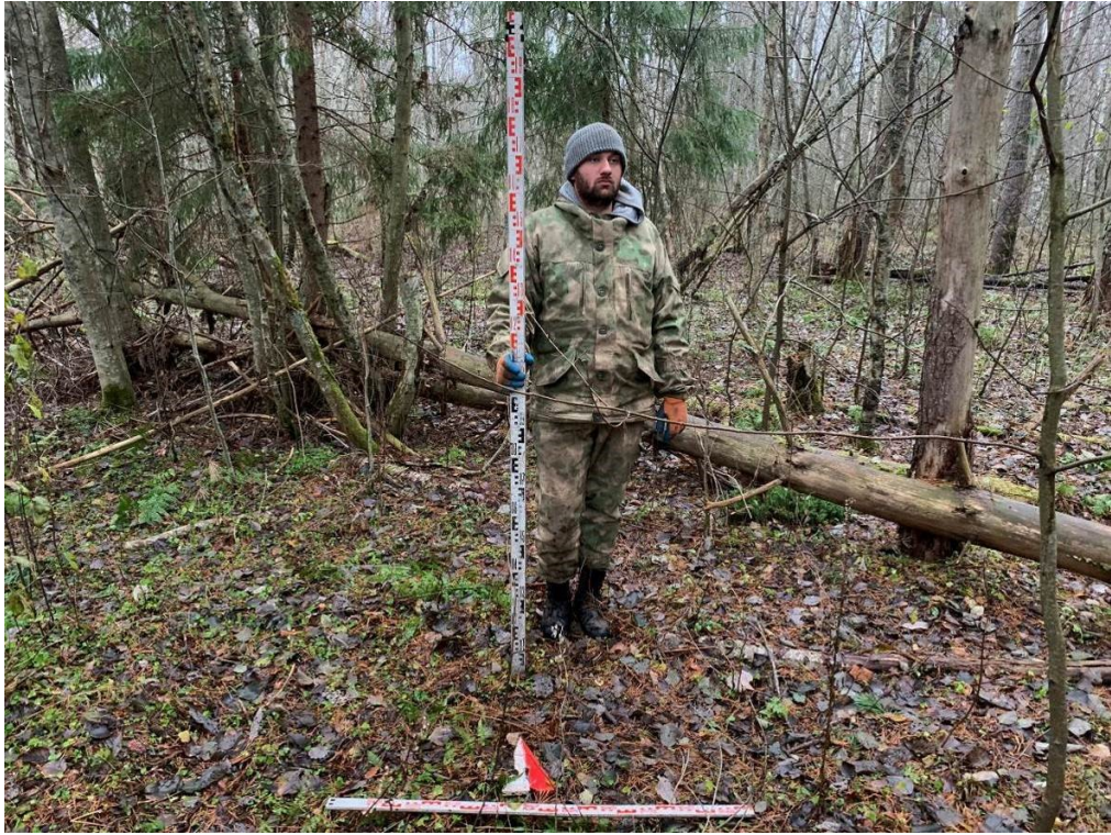
Илл. 65. Ленинградская область, Волховский район. 2024 г. «Газопровод межпоселковый от д. Самушкино – д. Шахново – д. Вороново Волховского района Ленинградской области». Шурф 5. Местоположение. Вид с Ю.
