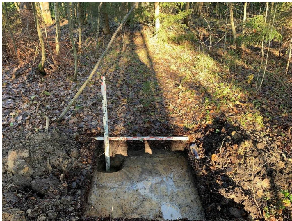
Илл. 31. Ленинградская область, Волховский район. 2024 г. «Газопровод межпоселковый от д. Самушкино – д. Шахново – д. Вороново Волховского района Ленинградской области». Шурф 3. Зачистка по материку. Общий вид с Ю.
