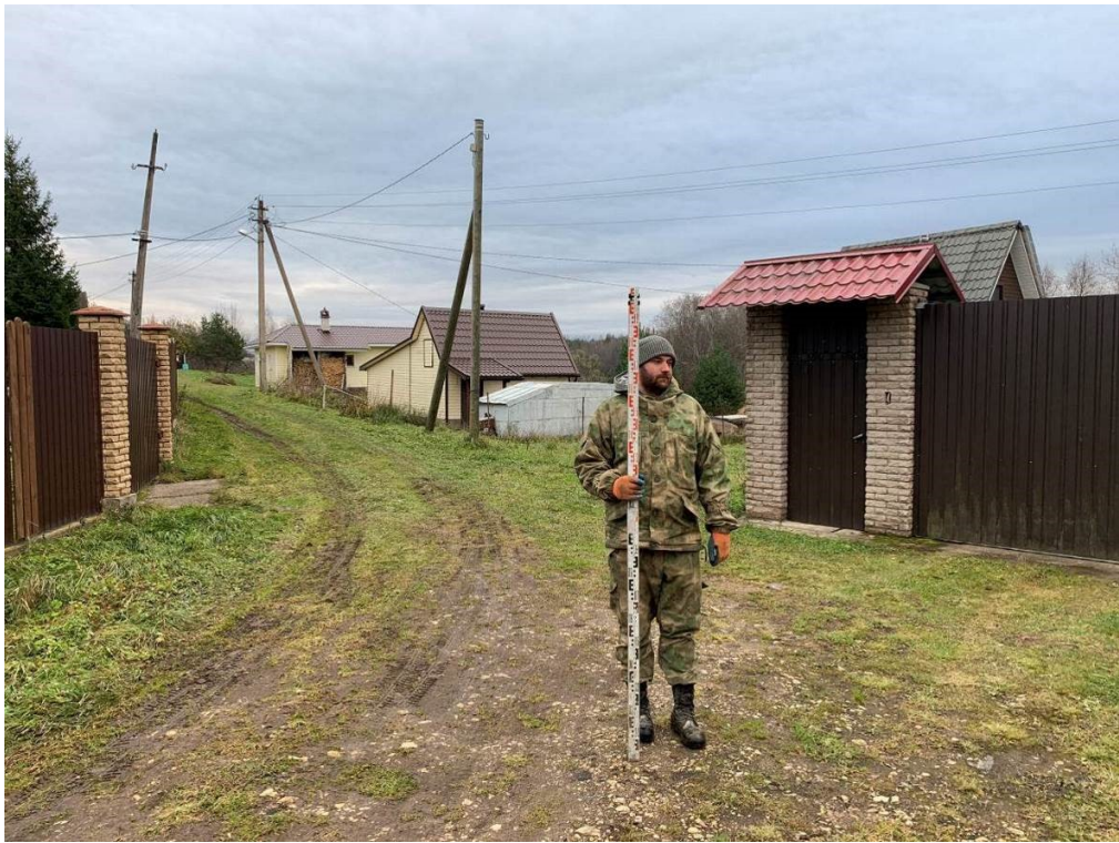
Илл. 49. Ленинградская область, Волховский район. 2024 г. «Газопровод межпоселковый от д. Самушкино – д. Шахново – д. Вороново Волховского района Ленинградской области». Точка фотофиксации 13. Вид с СЗ.
