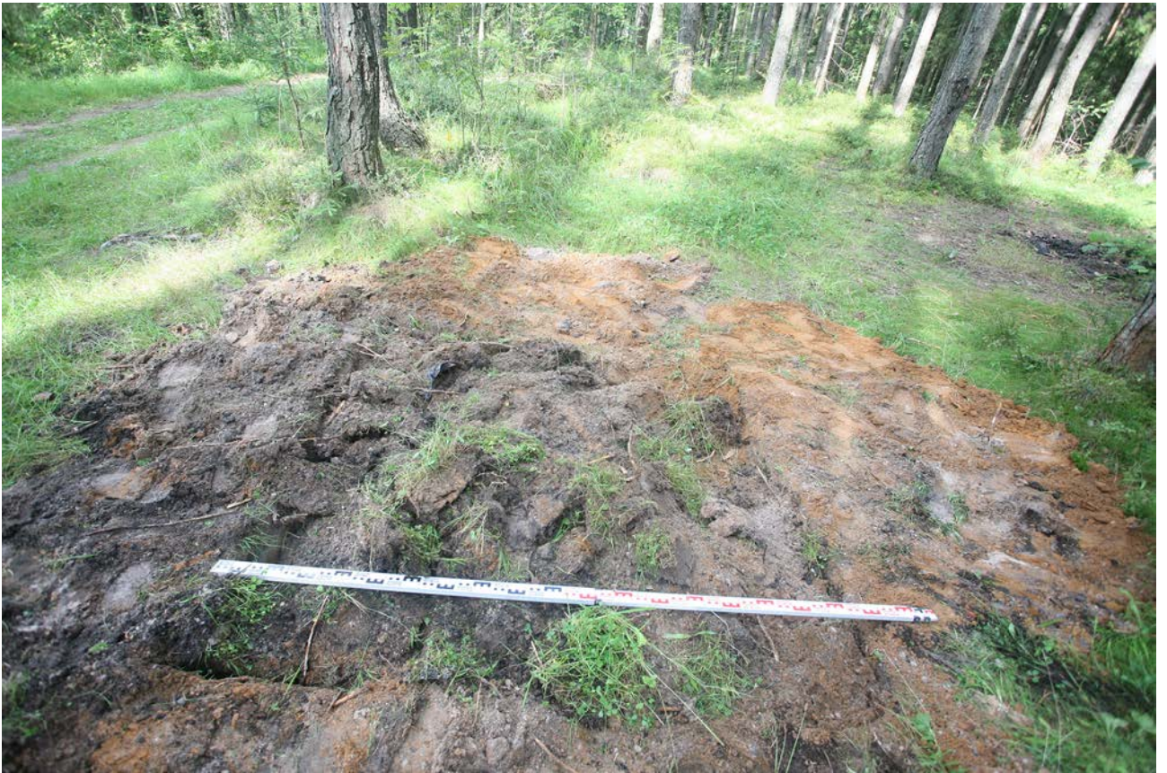
Рис. 126. Ленинградская область, Бокситогорский район. «Межпоселковый газопровод от ГРС Пикалево до д. Анисимово Бокситогорского района Ленинградской области». Шурф 25. Рекультивация. Вид с юга
