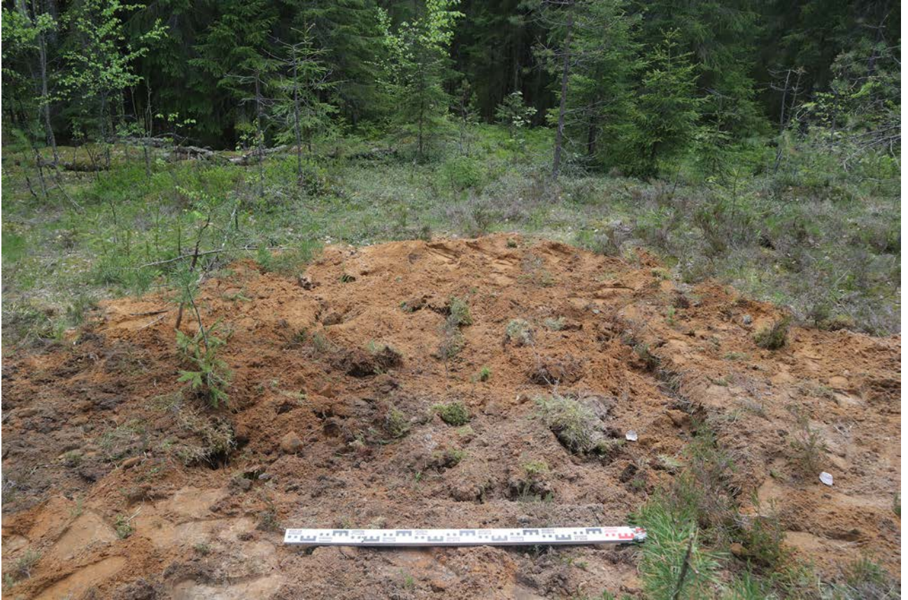
Рис. 90. Ленинградская область, Бокситогорский район. «Межпоселковый газопровод от ГРС Пикалево до д. Анисимово Бокситогорского района Ленинградской области». Шурф 17. Рекультивация. Вид с юга
