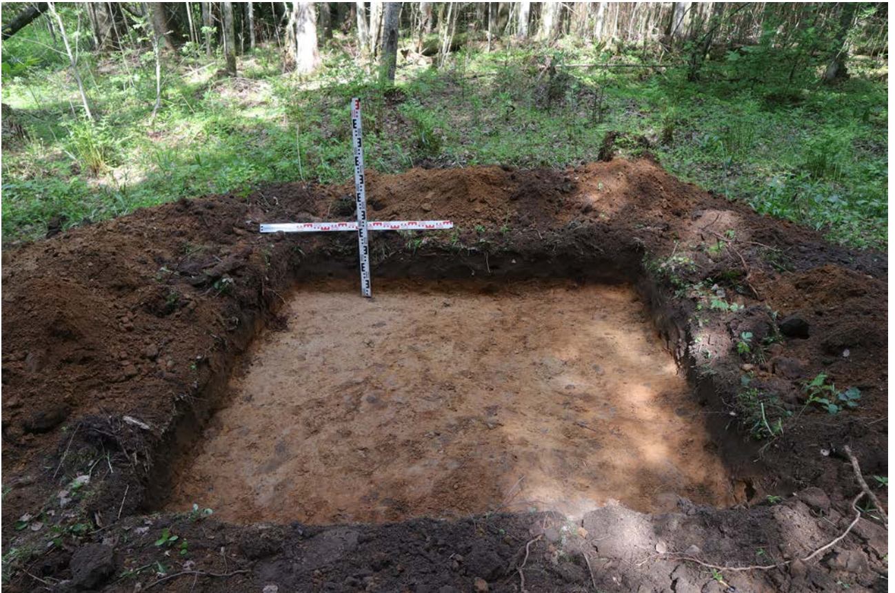
Рис. 104. Ленинградская область, Бокситогорский район. «Межпоселковый газопровод от ГРС Пикалево до д. Анисимово Бокситогорского района Ленинградской области». Шурф 21. Общий вид. Вид с юга
