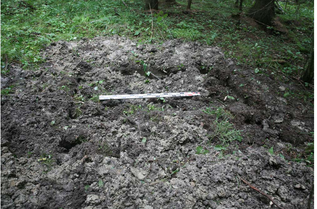
Рис. 114. Ленинградская область, Бокситогорский район. «Межпоселковый газопровод от ГРС Пикалево до д. Анисимова Бокситогорского района Ленинградской области». Шурф 22. Рекультивация. Вид с юга
