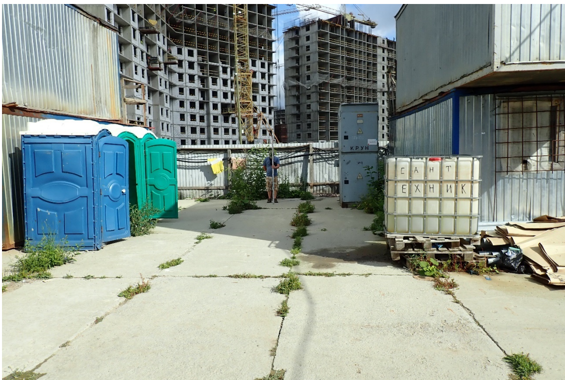
Рис. 17. Ленинградская область. Всеволожский район. Поселок Бугры. Земельный участок с кадастровым номером 47:07:0713003:913. Точка фотофиксации 2. Общий вид юго-восточной части участка. Вид с Ю.
