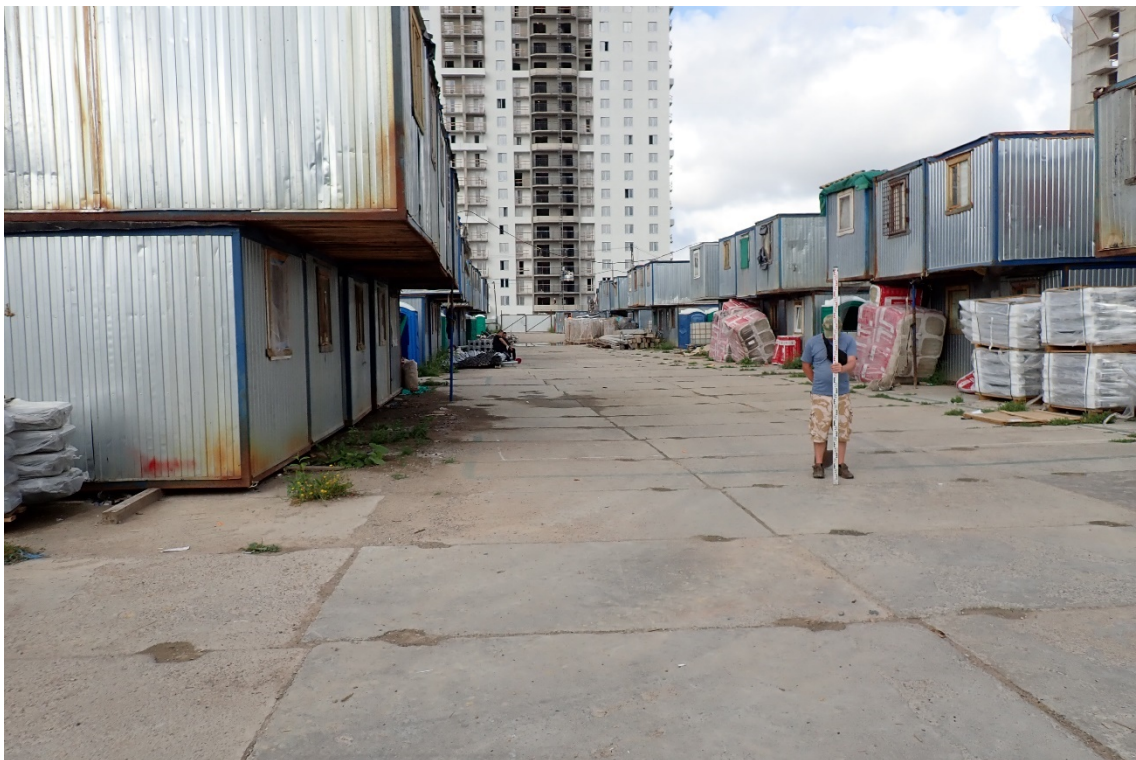
Рис. 22. Ленинградская область. Всеволожский район. Поселок Бугры. Земельный участок с кадастровым номером 47:07:0713003:913. Точка фотофиксации 4. Общий вид юго-восточной части участка. Вид с В.
