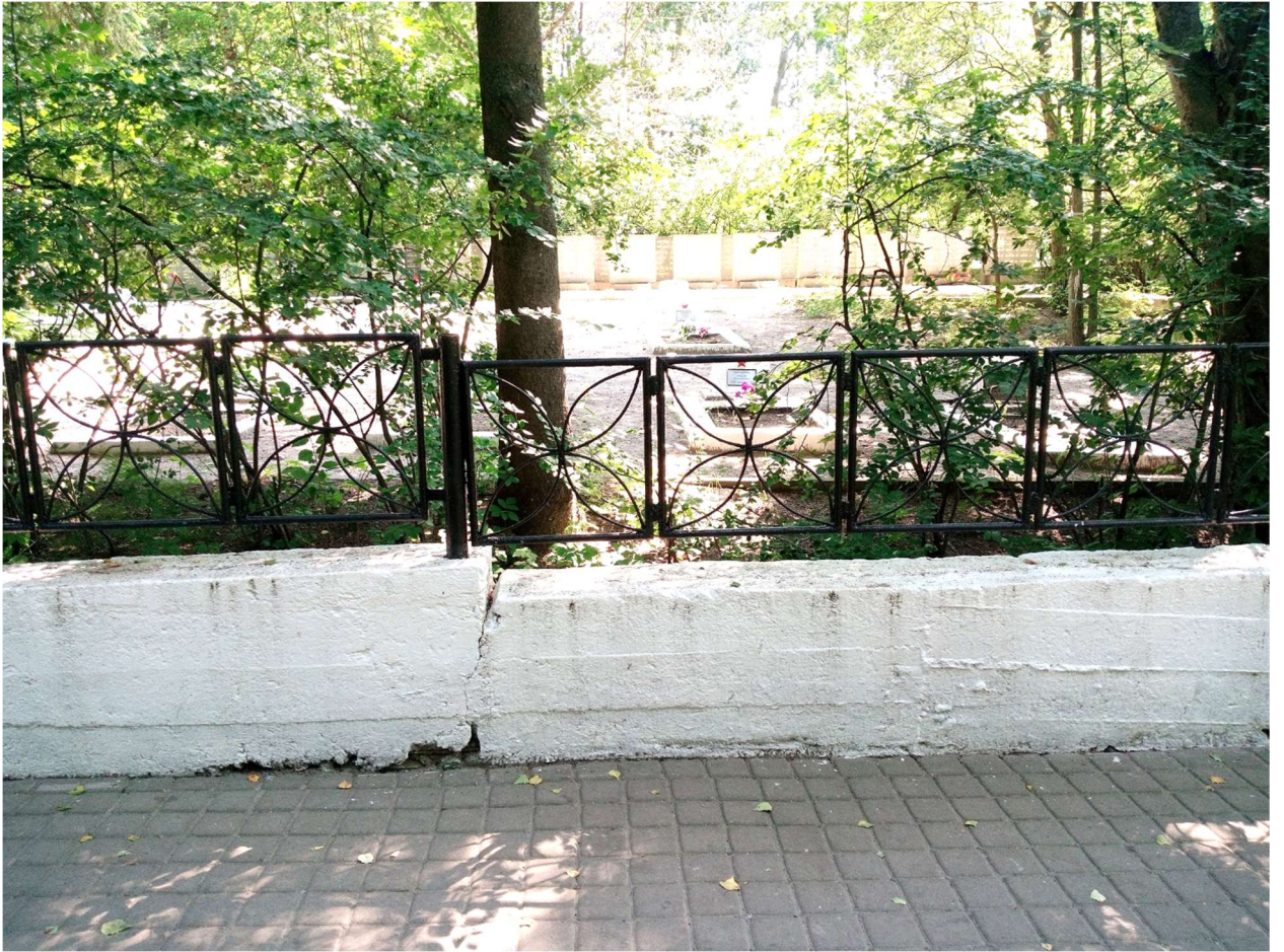
36. Сквозные трещины на цоколе ограды вдоль северо-западной границы территории.
