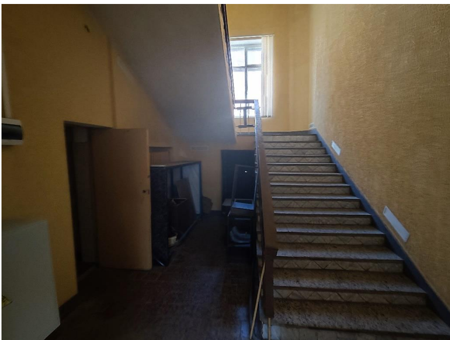
55. «Здание, где в июле-августе 1941 г. формировались Тосненские партизанские отряды для борьбы с фашистскими захватчиками. На здании установлена памятная доска», Ленинградская область, г. Тосно, пр. Ленина, д.50. Первый этаж. Помещение №23. Общий вид. Фото 31.05.2024г.
