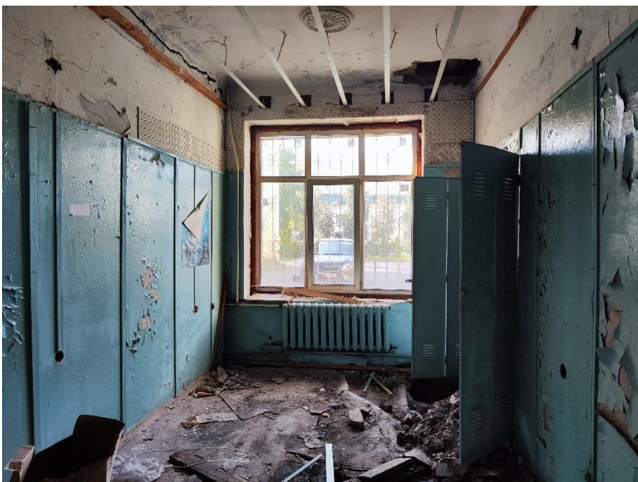
27. «Здание, где в июле-августе 1941 г. формировались Тосненские партизанские отряды для борьбы с фашистскими захватчиками. На здании установлена памятная доска», Ленинградская область, г. Тосно, пр. Ленина, д.50. Первый этаж. Помещение №40. Общий вид. Фото 31.05.2024г.
