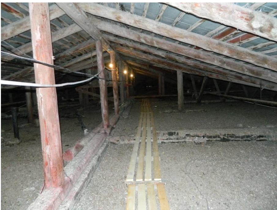
67. «Здание, где в июле-августе 1941 г. формировались Тосненские партизанские отряды для борьбы с фашистскими захватчиками. На здании установлена памятная доска», Ленинградская область, г. Тосно, пр. Ленина, д.50. Чердак. Общий вид. Фото 31.05.2024г.
