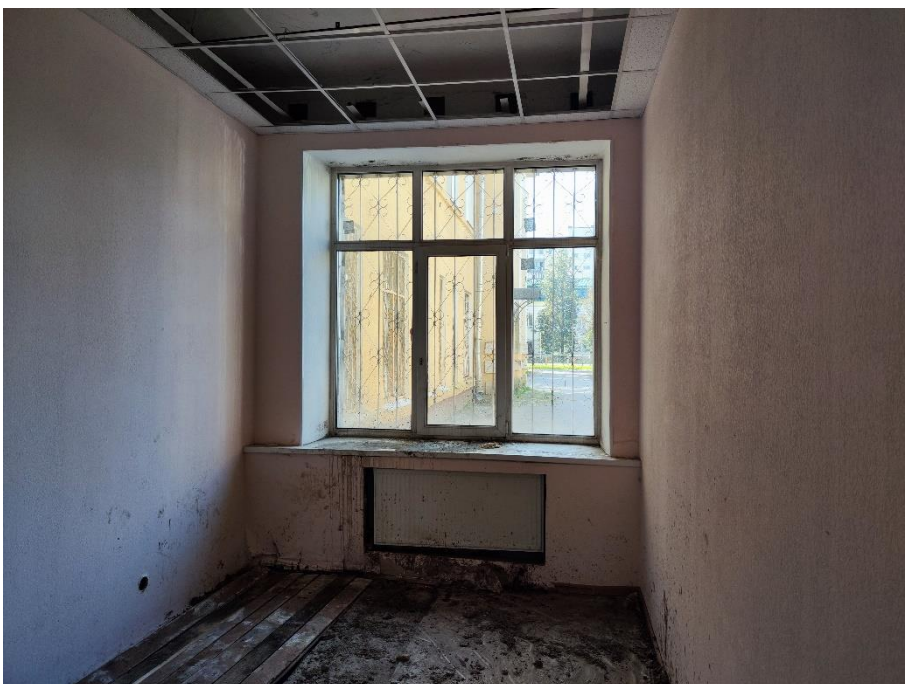
29. «Здание, где в июле-августе 1941 г. формировались Тосненские партизанские отряды для борьбы с фашистскими захватчиками. На здании установлена памятная доска», Ленинградская область, г. Тосно, пр. Ленина, д.50. Первый этаж. Помещение №39. Общий вид. Фото 31.05.2024г.
