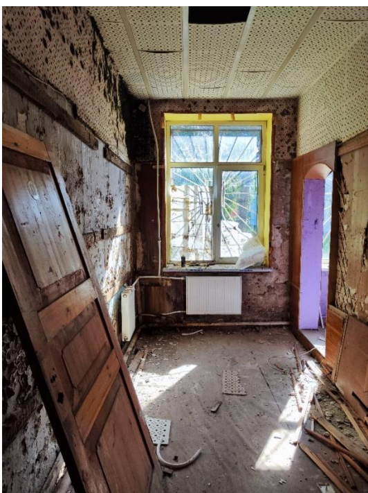
36. «Здание, где в июле-августе 1941 г. формировались Тосненские партизанские отряды для борьбы с фашистскими захватчиками. На здании установлена памятная доска», Ленинградская область, г. Тосно, пр. Ленина, д.50. Первый этаж. Помещение №30. Общий вид. Фото 31.05.2024г.
