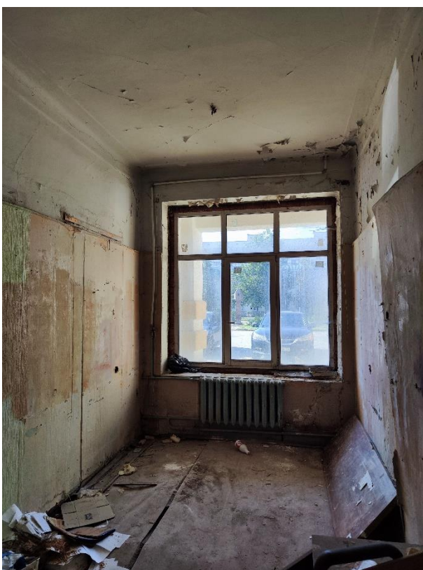
20. «Здание, где в июле-августе 1941 г. формировались Тосненские партизанские отряды для борьбы с фашистскими захватчиками. На здании установлена памятная доска», Ленинградская область, г. Тосно, пр. Ленина, д.50. Первый этаж. Помещение №46. Общий вид. Фото 31.05.2024г.
