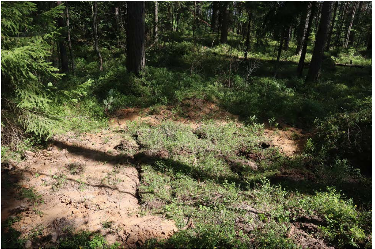
Рис. 74. Ленинградская область, Приозерский район. Газопровод межпоселковый от г. Приозерск к д. Бурнево, п. Кузнечное с отводом на п. Сторожевое Приозерского района Ленинградской области. Шурф 14. Рекультивация. Вид с юга.
