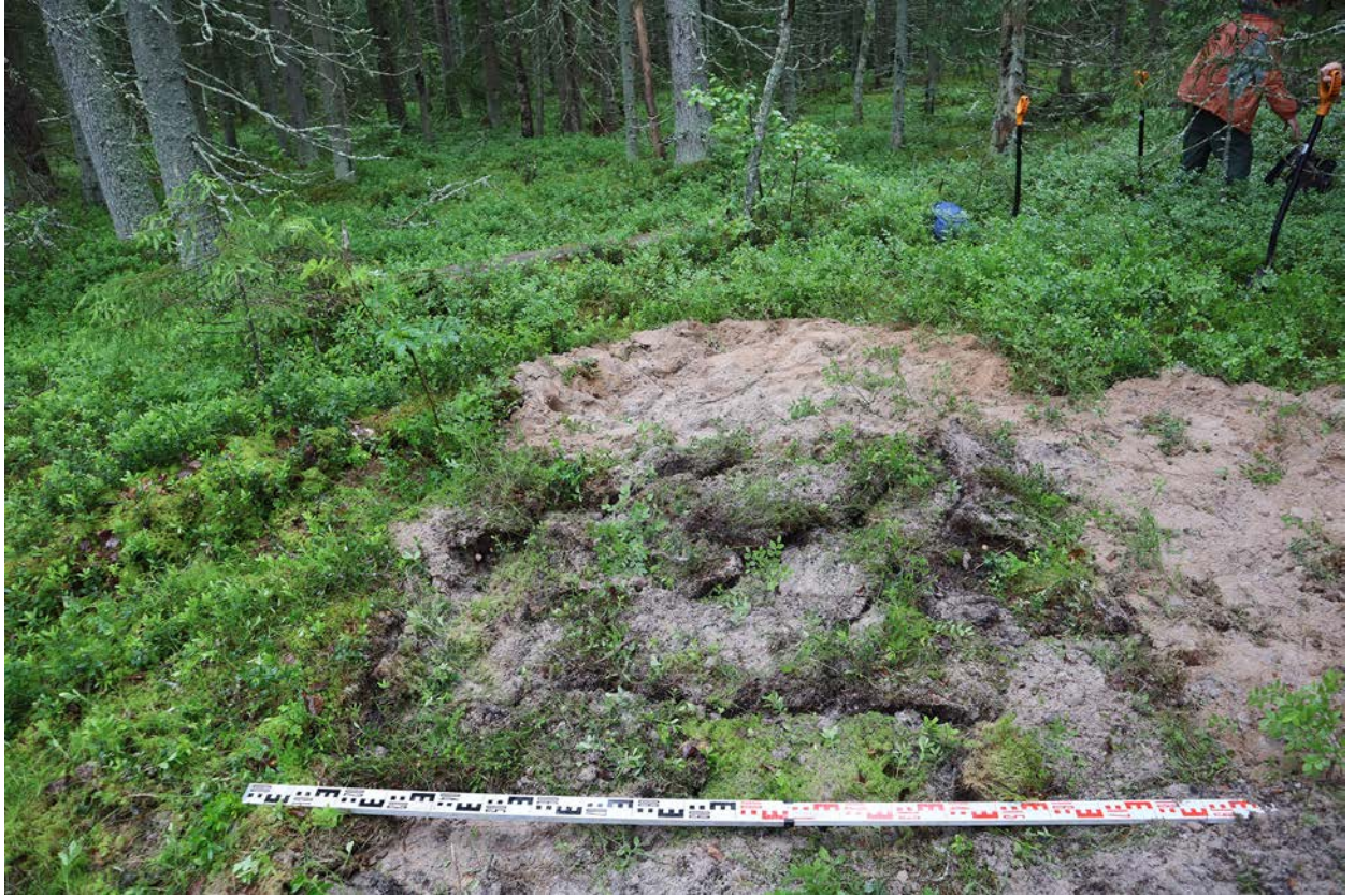
Рис. 62. Ленинградская область, Приозерский район. Газопровод межпоселковый от г. Приозерск к д. Бурнево, п. Кузнечное с отводом на п. Сторожевое Приозерского района Ленинградской области. Шурф 11. Рекультивация. Вид с юга.
