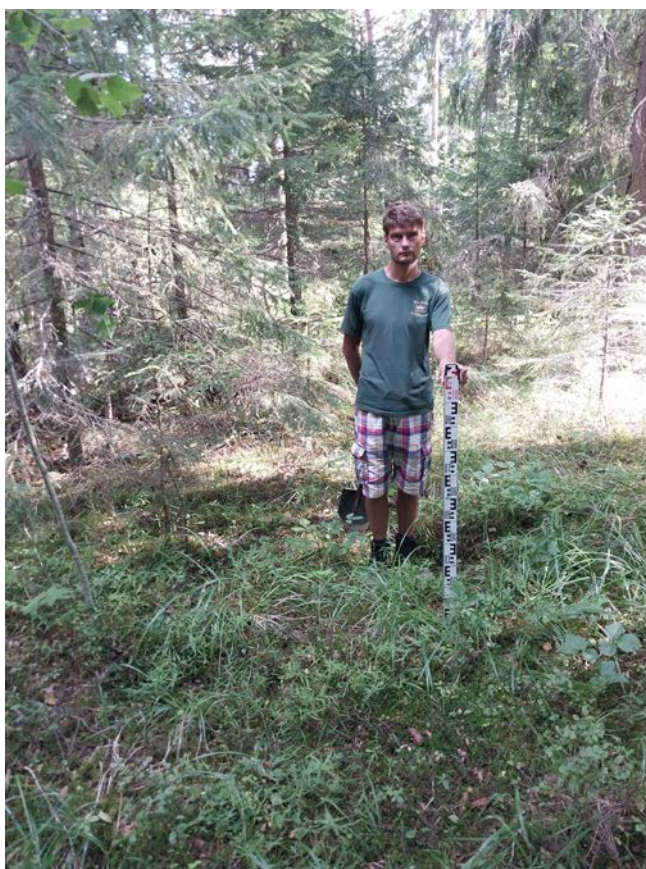
Рис. 23. Ленинградская область, Приозерский район. Газопровод межпоселковый от г. Приозерск к д. Бурнево, п. Кузнечное с отводом на п. Сторожевое Приозерского района Ленинградской области. Шурф 4. Общий вид до начала работ. Вид с юга.
