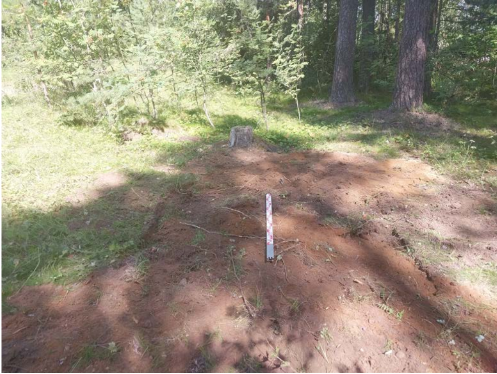
Рис. 102. Ленинградская область, Приозерский район. Газопровод межпоселковый от г. Приозерск к д. Бурнево, п. Кузнечное с отводом на п. Сторожевое Приозерского района Ленинградской области. Шурф 21. Рекультивация. Вид с юга
