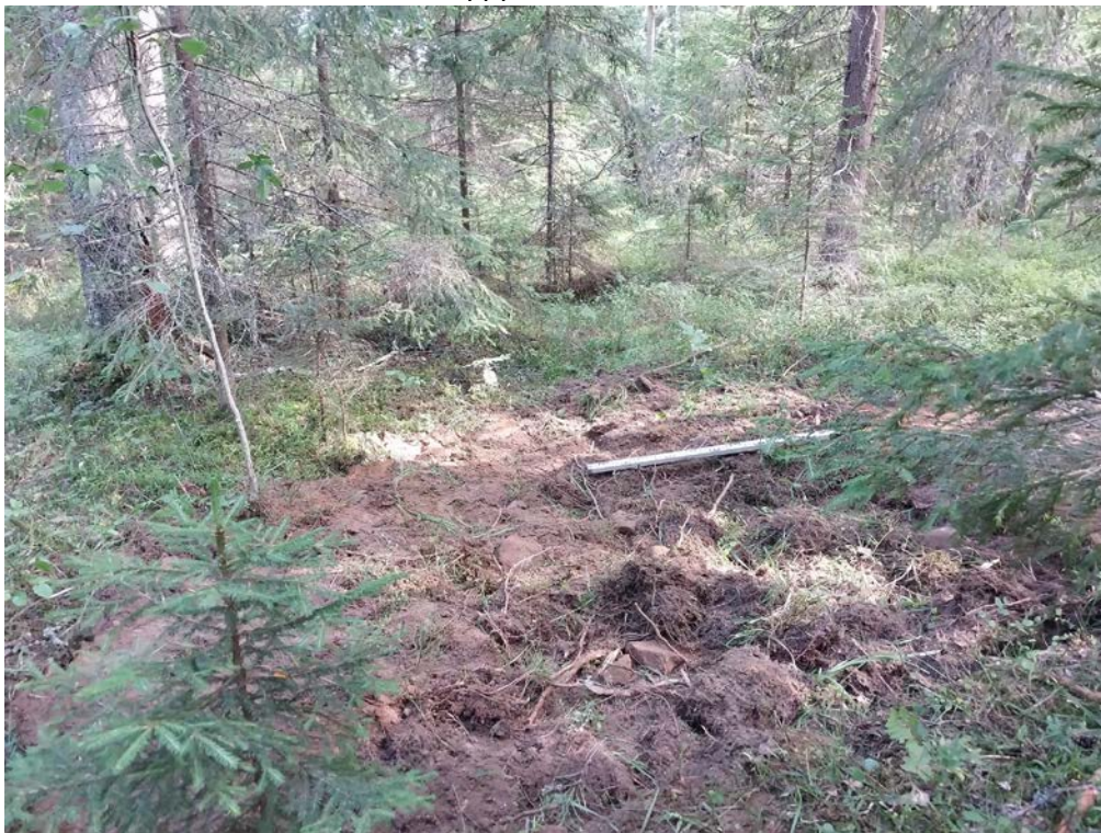
Рис. 26. Ленинградская область, Приозерский район. Газопровод межпоселковый от г. Приозерск к д. Бурнево, п. Кузнечное с отводом на п. Сторожевое Приозерского района Ленинградской области. Шурф 4. Рекультивация. Вид с юга.
