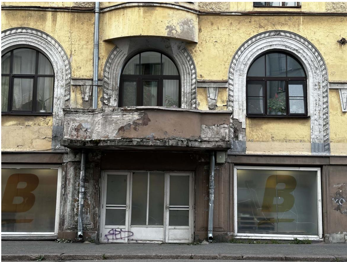
Фото 14. Фрагмент правой части западного лицевого фасада здания. Дата съемки: 21.05.2024 г. Автор съемки: Куваева Ю.П.
