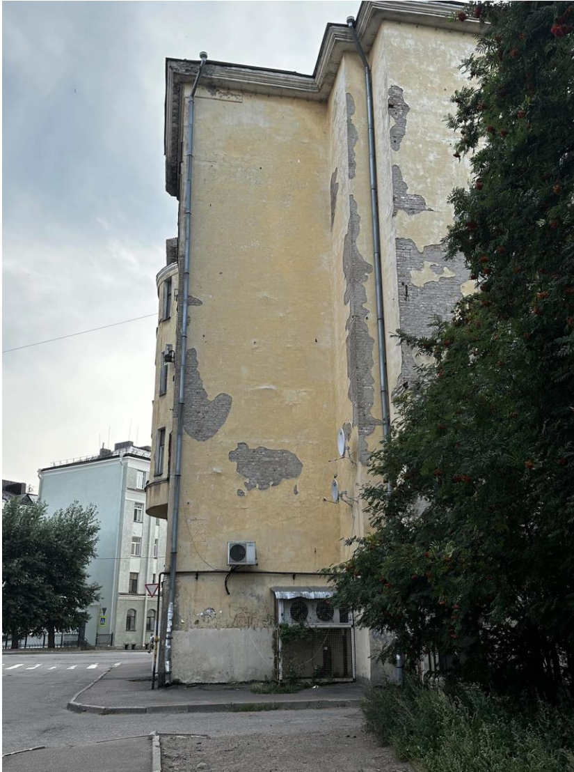
Фото 22. Общий вид левой части восточного фасада восточного ризалита уличного объема. Дата съемки: 21.05.2024 г. Автор съемки: Куваева Ю.П.
