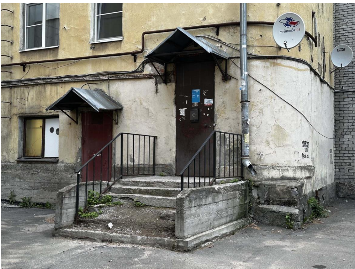
Фото 40. Фрагмент южного фасада северо-восточного дворового крыла здания. Крыльцо. Дата съемки: 21.05.2024 г. Автор съемки: Куваева Ю.П.
