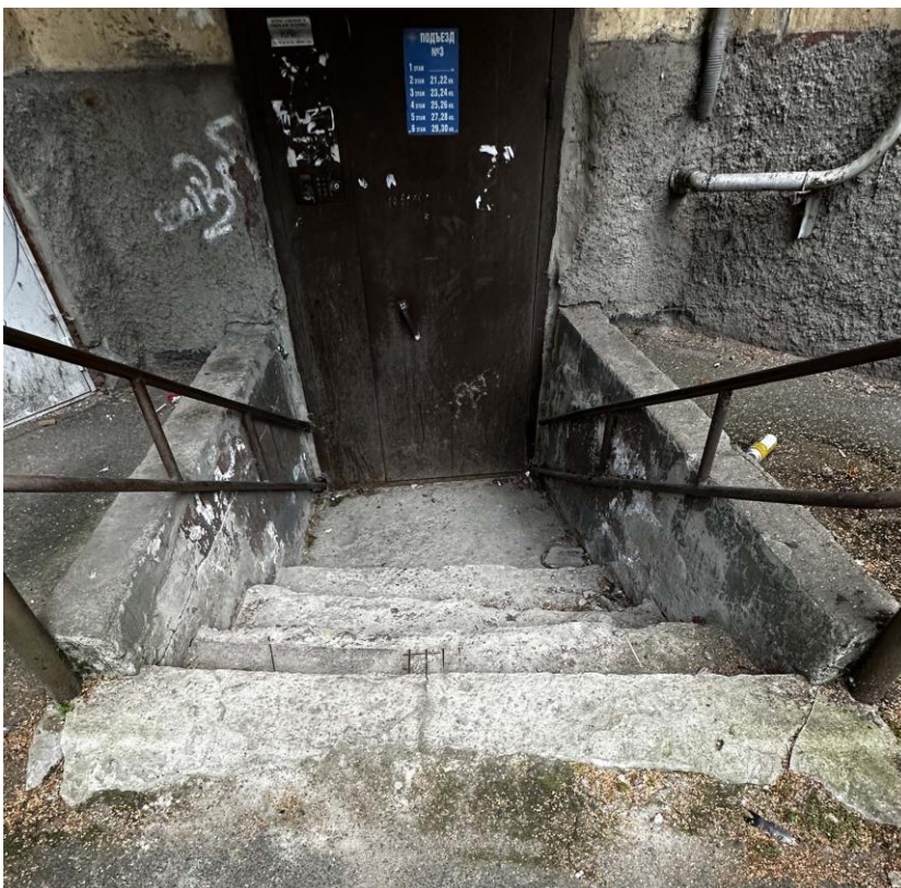
Фото 29. Фрагмент внутреннего северо-восточного угла дворовых фасадов здания. Спуск в подвал. Дата съемки: 21.05.2024 г. Автор съемки: Куваева Ю.П.
