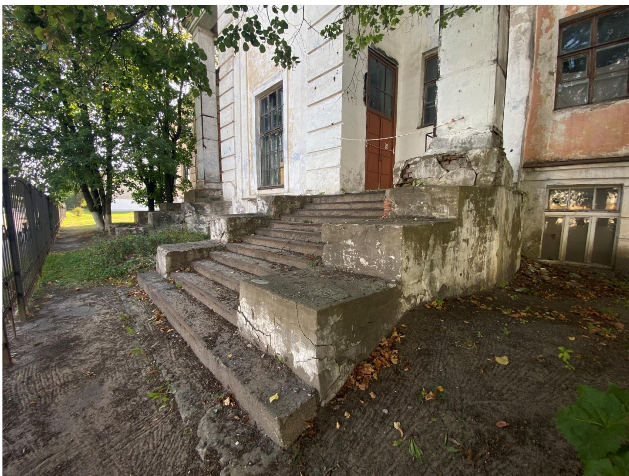
Фот. 7. Состояние входной группы, лестниц
