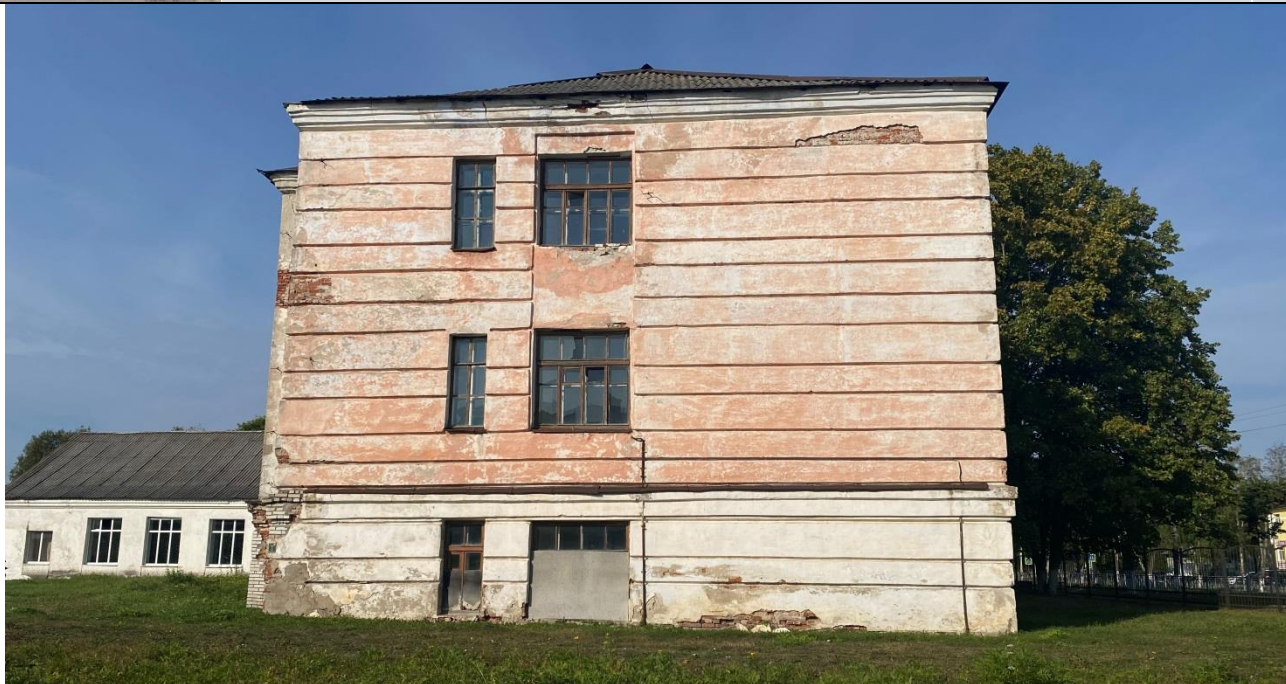
Фот. 6. Вид на южный торцевой фасад
