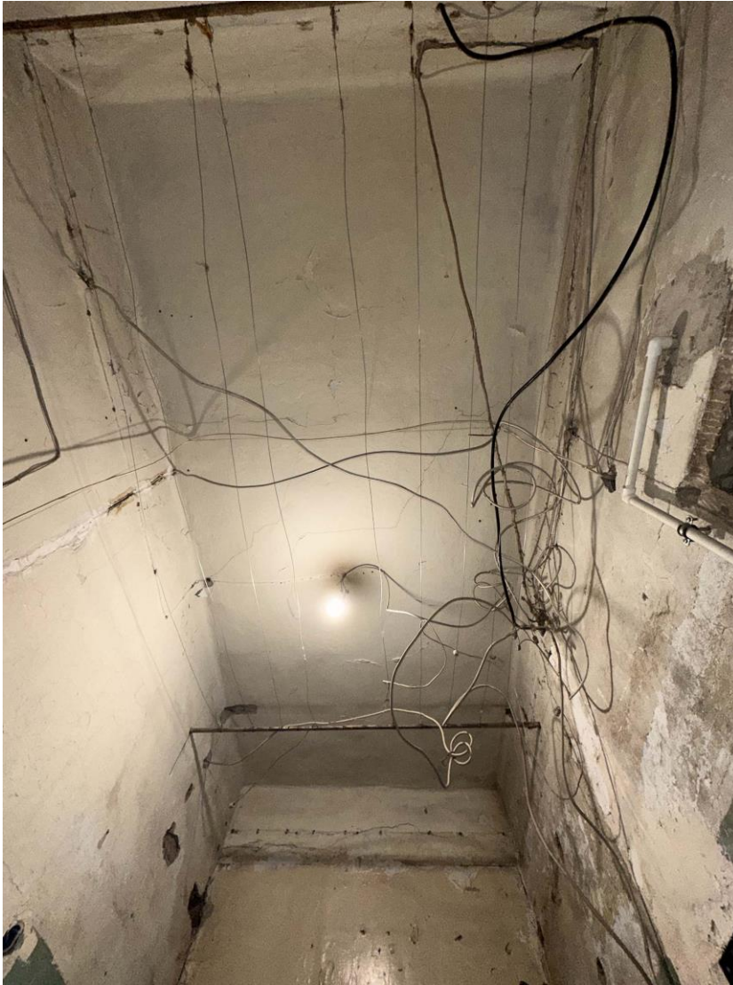
Фото 9. Квартира № 41 (2-ой этаж). Пом. 2.1. Перекрытие. Дата съемки: 01.11.2024 г. Автор съемки: Глинская Н.Б.
