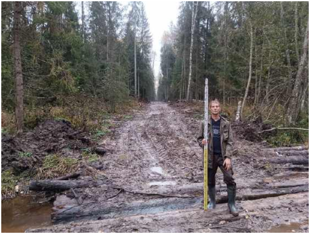
Илл. 176. Ленинградская область, Тосненский район. 2024 г. «Создание высокоскоростной железнодорожной магистрали Санкт-Петербург – Москва (участок Крюково (Алабушево) – Обухово)». «1 этап - Строительство участка Обухово-2 (искл.) - Великий Новгород ВСМ (вкл.)». Общий вид участка обследования. Пересечение р. Полисарка. Точка фотофиксации №ЛО-18. Вид с ССЗ.
