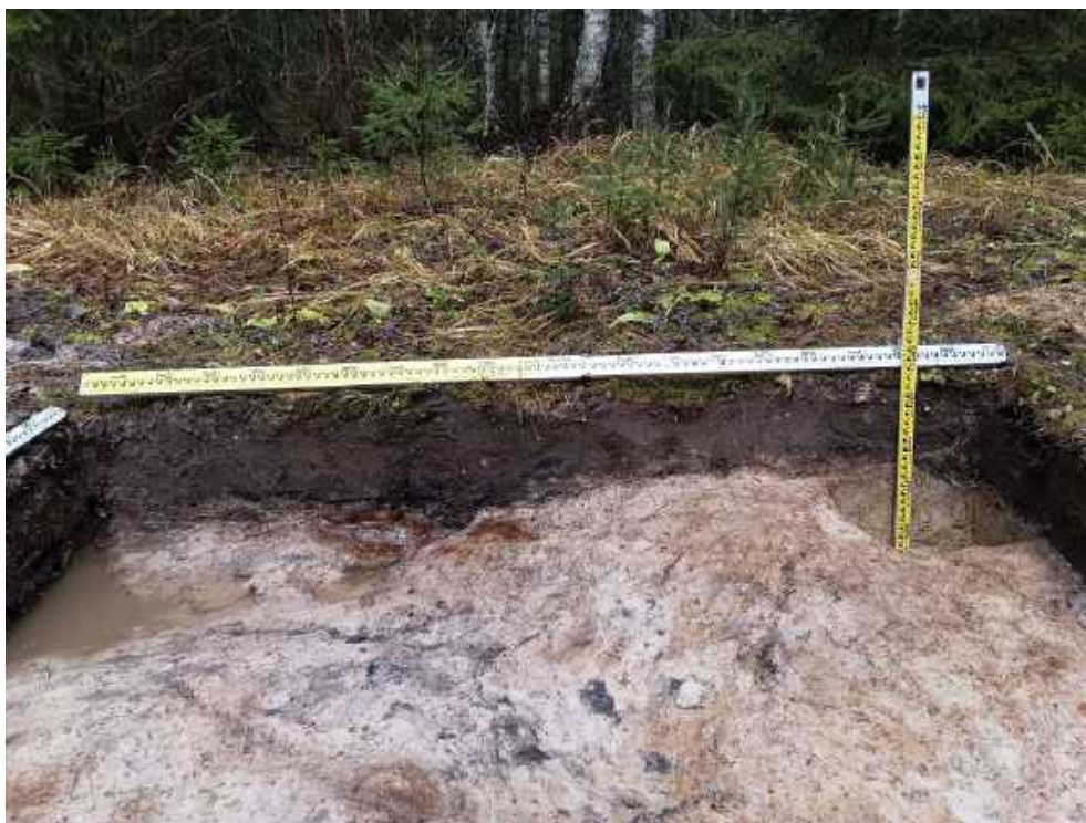
Илл. 275. Ленинградская область, Тосненский район. 2024 г. «Создание высокоскоростной железнодорожной магистрали Санкт-Петербург – Москва (участок Крюково (Алабушево) – Обухово)». «1 этап - Строительство участка Обухово-2 (искл.) - Великий Новгород ВСМ (вкл.)». Шурф №ЛО-29. Восточная стенка и контрольный прокоп. Вид с 3.
