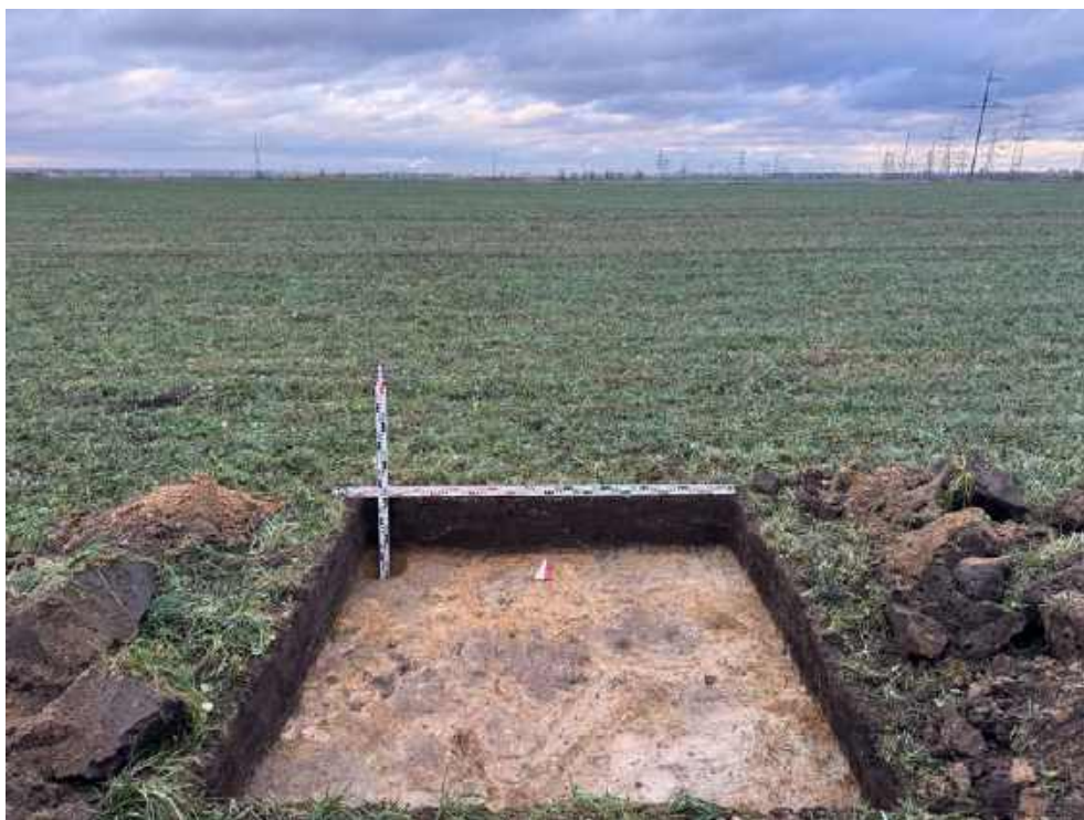
Илл. 16. Ленинградская область, Госненский район. 2024 г. «Создание высокоскоростной железнодорожной магистрали Санкт-Петербург – Москва (участок Крюково (Алабушево) – Обухово)». «1 этап - Строительство участка Обухово-2 (искл.) - Великий Новгород ВСМ (вкл.)». Шурф №ЛО-1. Зачистка по материку. Общий вид с Ю.
