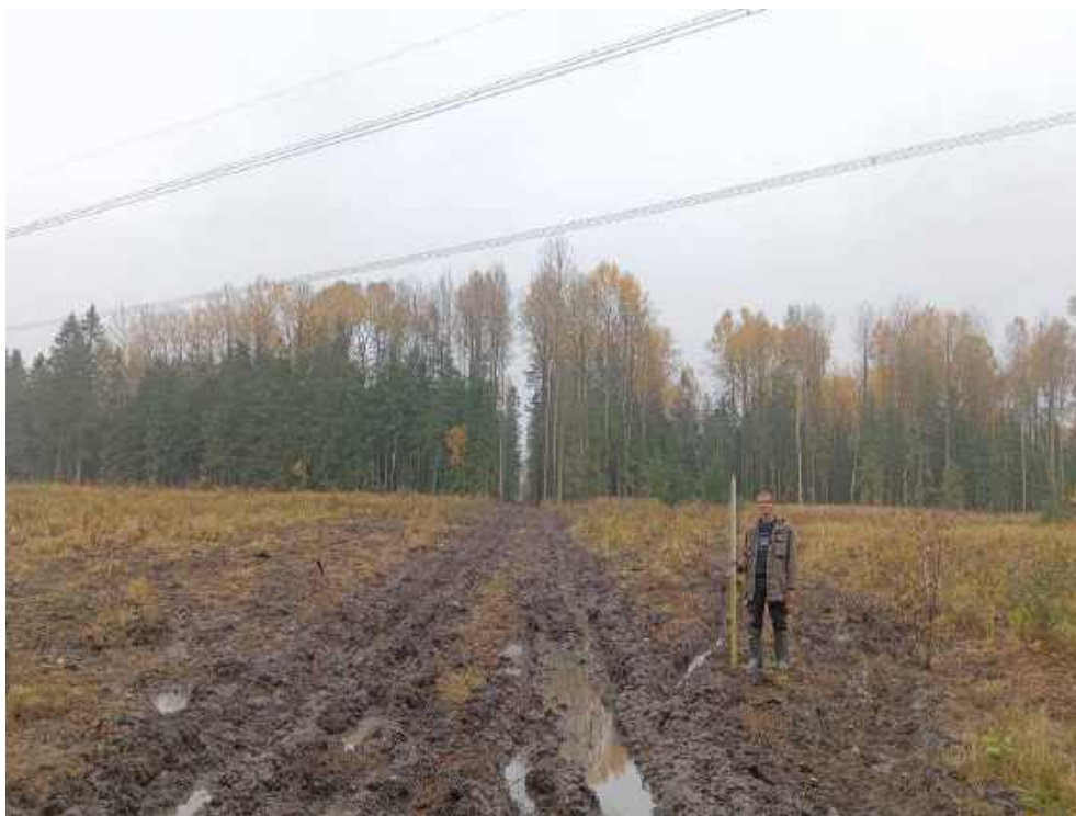
Илл. 198. Ленинградская область, Тосненский район. 2024 г. «Создание высокоскоростной железнодорожной магистрали Санкт-Петербург – Москва (участок Крюково (Алабушево) – Обухово)». «1 этап - Строительство участка Обухово-2 (искл.) - Великий Новгород ВСМ (вкл.)». Общий вид участка обследования. Переход ВЛ 750 кВ «Калининская АЭС – Ленинградская». Точка фотофиксации №ЛО-22. Вид с ССЗ.
