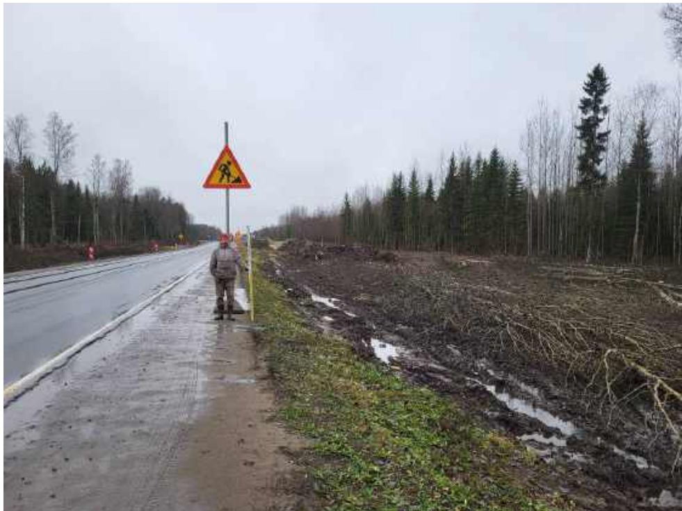
Илл. 201. Ленинградская область, Тосненский район. 2024 г. «Создание высокоскоростной железнодорожной магистрали Санкт-Петербург – Москва (участок Крюково (Алабушево) – Обухово)». «1 этап - Строительство участка Обухово-2 (искл.) - Великий Новгород ВСМ (вкл.)». Общий вид участка обследования. Переход а/д А-120 «Санкт-Петербургское Южное полукольцо». Точка фотофиксации №ЛО-23. Вид с СВ.
