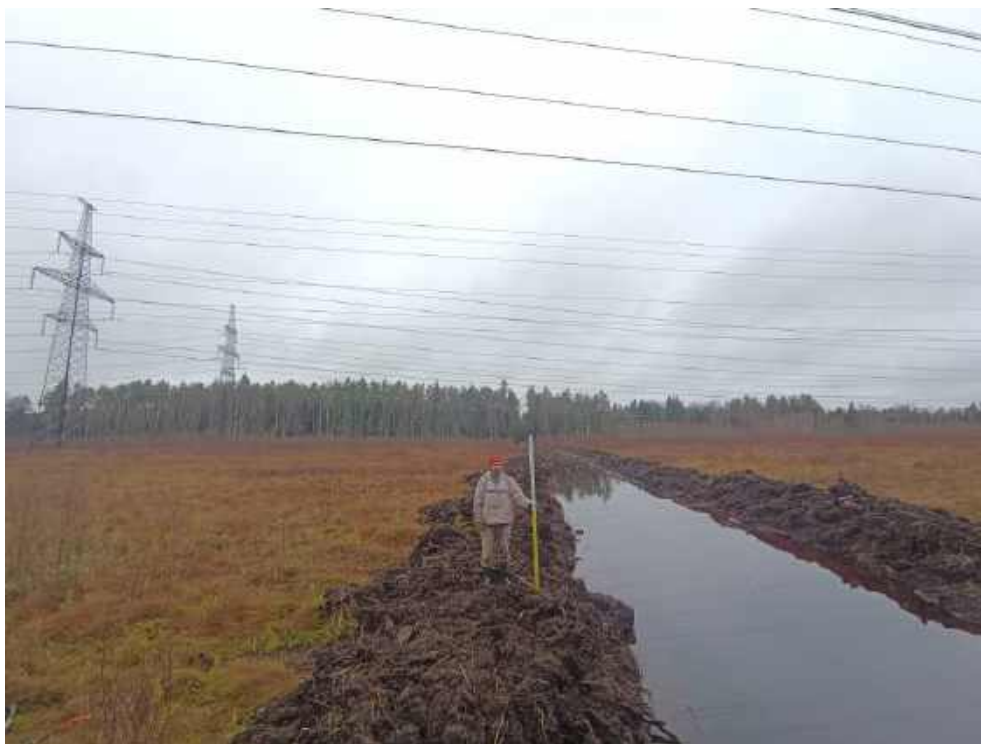
Илл. 164. Ленинградская область, Тосненский район. 2024 г. «Создание высокоскоростной железнодорожной магистрали Санкт-Петербург – Москва (участок Крюково (Алабушево) – Обухово)». «1 этап - Строительство участка Обухово-2 (искл.) - Великий Новгород ВСМ (вкл.)». Общий вид участка обследования. Пересечение нескольких ВЛ идущих к ПС 750 кВ «Ленинградская». Точка фотофиксации №ЛО-17. Вид с ЮЮВ.
