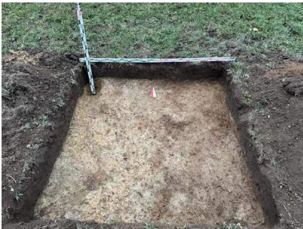
Илл. 34. Ленинградская область, Госненский район. 2024 г. «Создание высокоскоростной железнодорожной магистрали Санкт-Петербург – Москва (участок Крюково (Алабушево) – Обухово)». «1 этап - Строительство участка Обухово-2 (искл.) - Великий Новгород ВСМ (вкл.)». Шурф №ЛО-4. Материк. Предметный вид с Ю.
