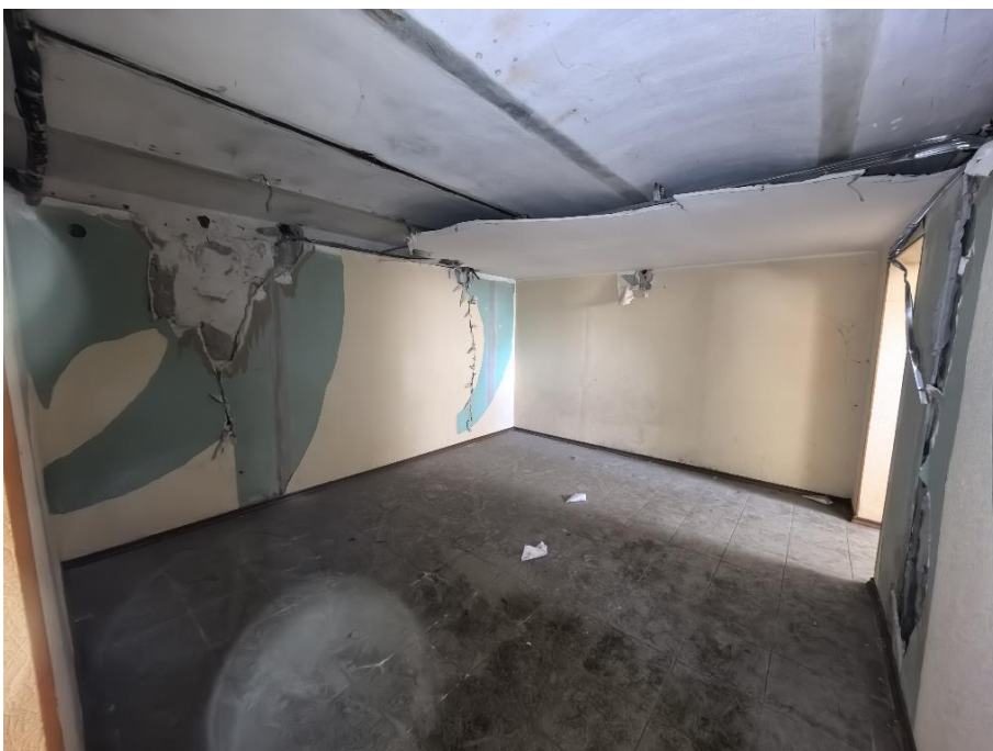
35. «Жилой дом», Ленинградская область, Выборгский муниципальный район, г. Выборг, ул. Сторожевой башни, д. 10А. Подвал. Общий вид. Фото 05.11.2024г.
