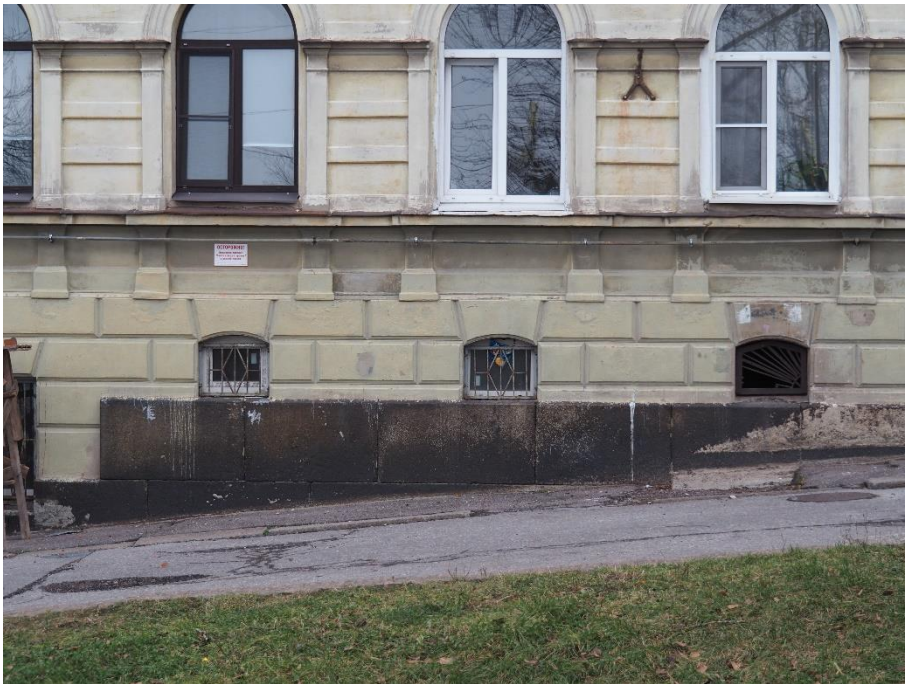
11. «Жилой дом», Ленинградская область, Выборгский муниципальный район, г. Выборг, ул. Сторожевой башни, д. 10А. Юго-западный фасад. Фрагмент. Фото 05.11.2024г.
