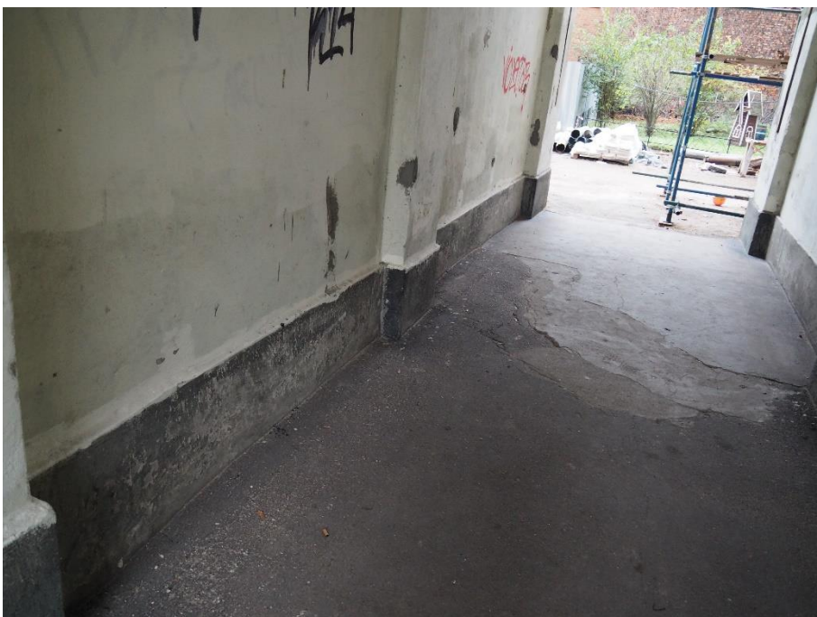
17. «Жилой дом», Ленинградская область, Выборгский муниципальный район, г. Выборг, ул. Сторожевой башни, д. 10А. Юго-западный фасад. Фрагмент. Фото 05.11.2024г.
