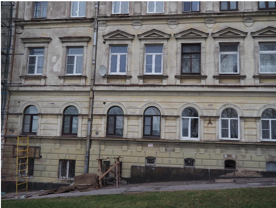
5. «Жилой дом», Ленинградская область, Выборгский муниципальный район, г. Выборг, ул. Сторожевой башни, д. 10А. Юго-западный фасад. Фрагмент. Фото 05.11.2024г.
