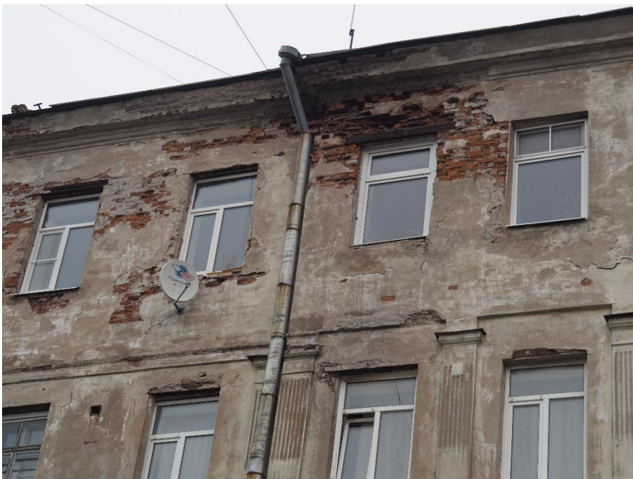
4. «Жилой дом», Ленинградская область, Выборгский муниципальный район, г. Выборг, ул. Сторожевой башни, д. 10А. Юго-западный фасад. Фрагмент. Фото 05.11.2024г.
