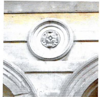
Розетка. Лицевой Ю-З фасад, верхняя часть простенка между архивольтами проемов входа и сквозного проезда
