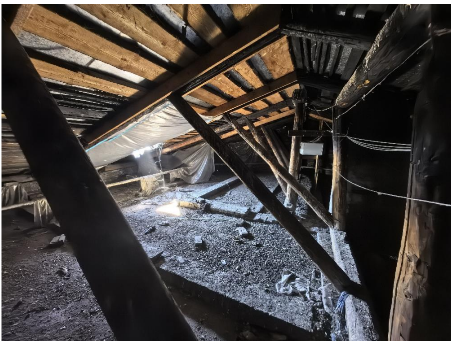
31. «Жилой дом», Ленинградская область, Выборгский муниципальный район, г. Выборг, ул. Сторожевой башни, д. 10А. Чердак. Общий вид. Фото 05.11.2024г.
