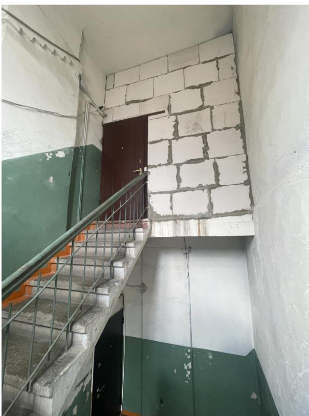
46. «Жилой дом», Ленинградская область, Выборгский муниципальный район, г. Выборг, ул. Сторожевой башни, д. 10А. Подъезд №2. Общий вид. Фото 05.11.2024г.
