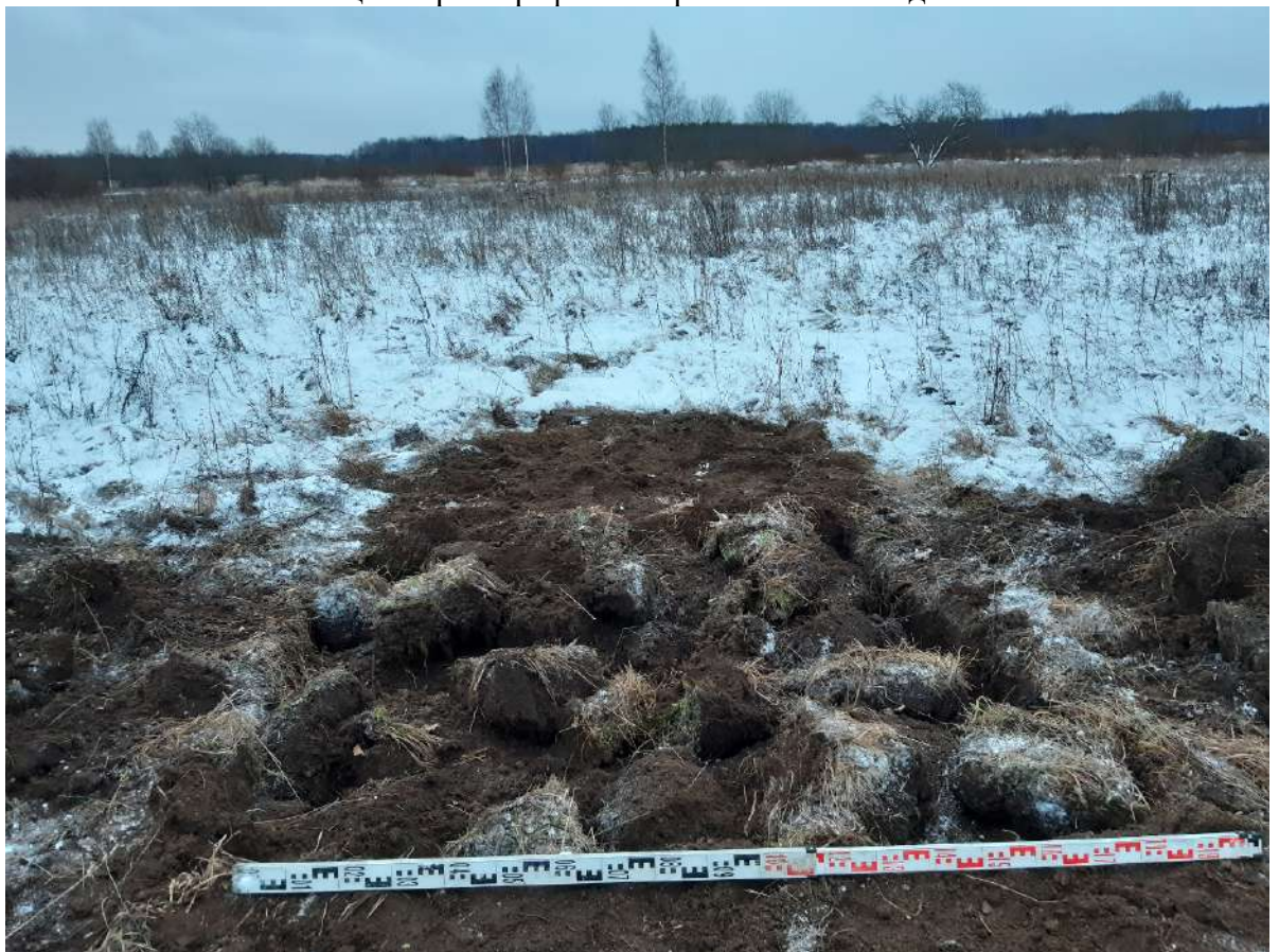
Рис. 147. ЛО-2024. Ломоносовский район. Низинское с.п., п. Троицкая Гора. Шурф 31. Общий вид. Рекультивация. Вид с юга
