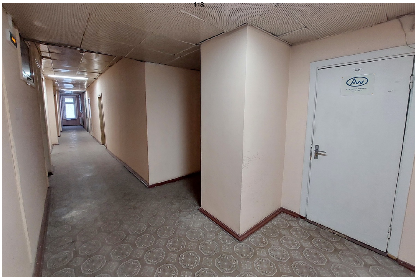
41 Выявленный ОКН «Здание Госбанка» г. Кингисепп, пр. Карла Маркса, д. 25/2 2 этаж. Помещение 95 (см. «Схема точки фотофиксации» на основе планов БТИ) Дата съемки: 10.01.2025 г.
