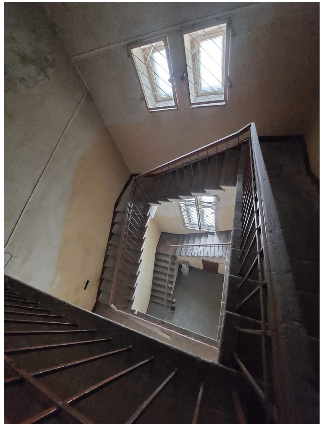
38 Выявленный ОКН «Здание Госбанка» г. Кингисепп, пр. Карла Маркса, д. 25/2. Помещение 82. Лестничная клетка. Чердак (см. «Схема точки фотофиксации» на основе планов БТИ) Дата съемки: 10.01.2025 г.
