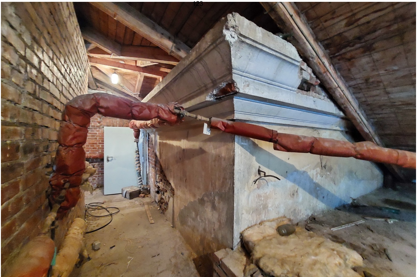
49 Выявленный ОКН «Здание Госбанка» г. Кингисепп, пр. Карла Маркса, д. 25/2 Чердак (см. «Схема точки фотофиксации» на основе планов БТИ) Дата съемки: 10.01.2025 г.
