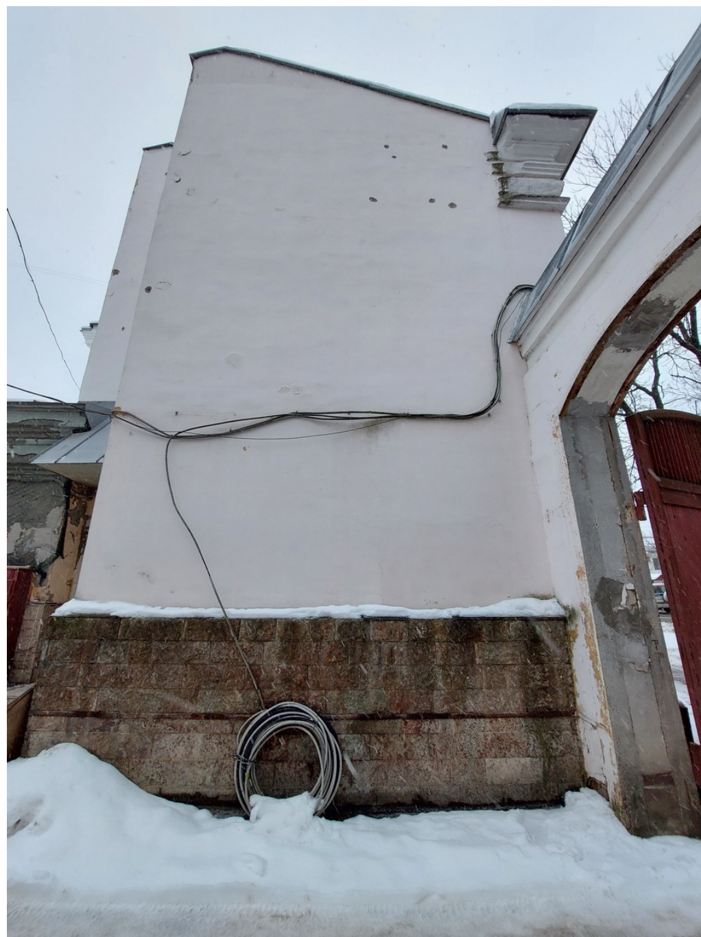
10 Выявленный ОКН «Здание Госбанка» г. Кингисепп, пр. Карла Маркса, д. 25/2 Северо-восточный дворовый фасад рассматриваемого строения Дата съемки: 10.01.2025 г.
