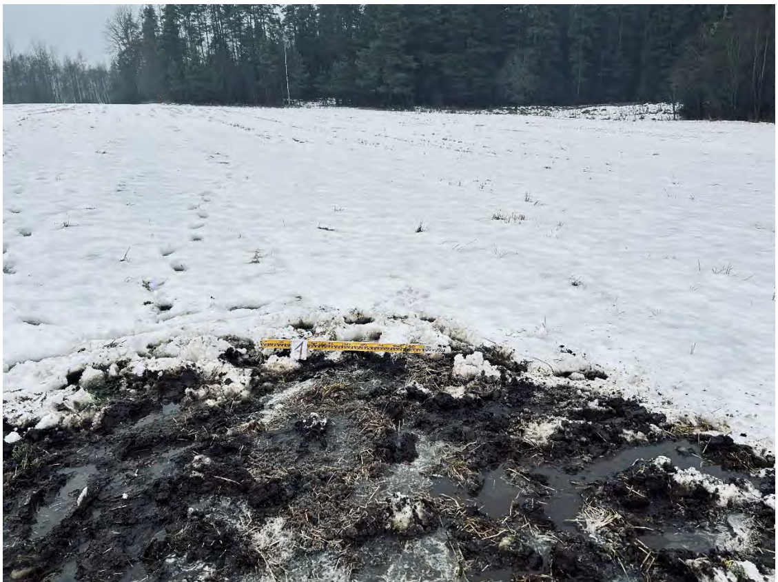
Рис. 59. Ленинградская область, Выборгский муниципальный район, Первомайское сельское поселение, уч. Сухочево. Шурф 1а после завершения работ и рекультивации. Вид с юга.
