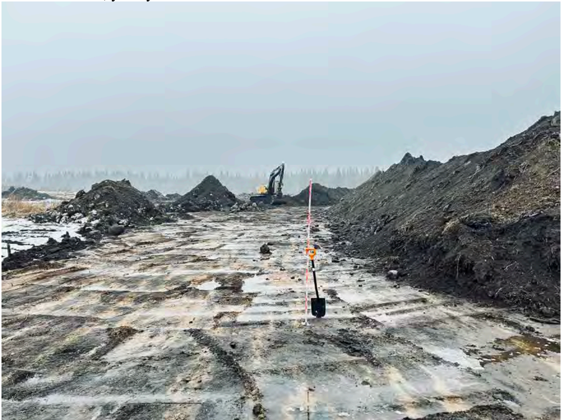
Рис. 31. Ленинградская область, Выборгский муниципальный район, Первомайское сельское поселение, уч. Сухочево. ТФ12. Вид с запада.
