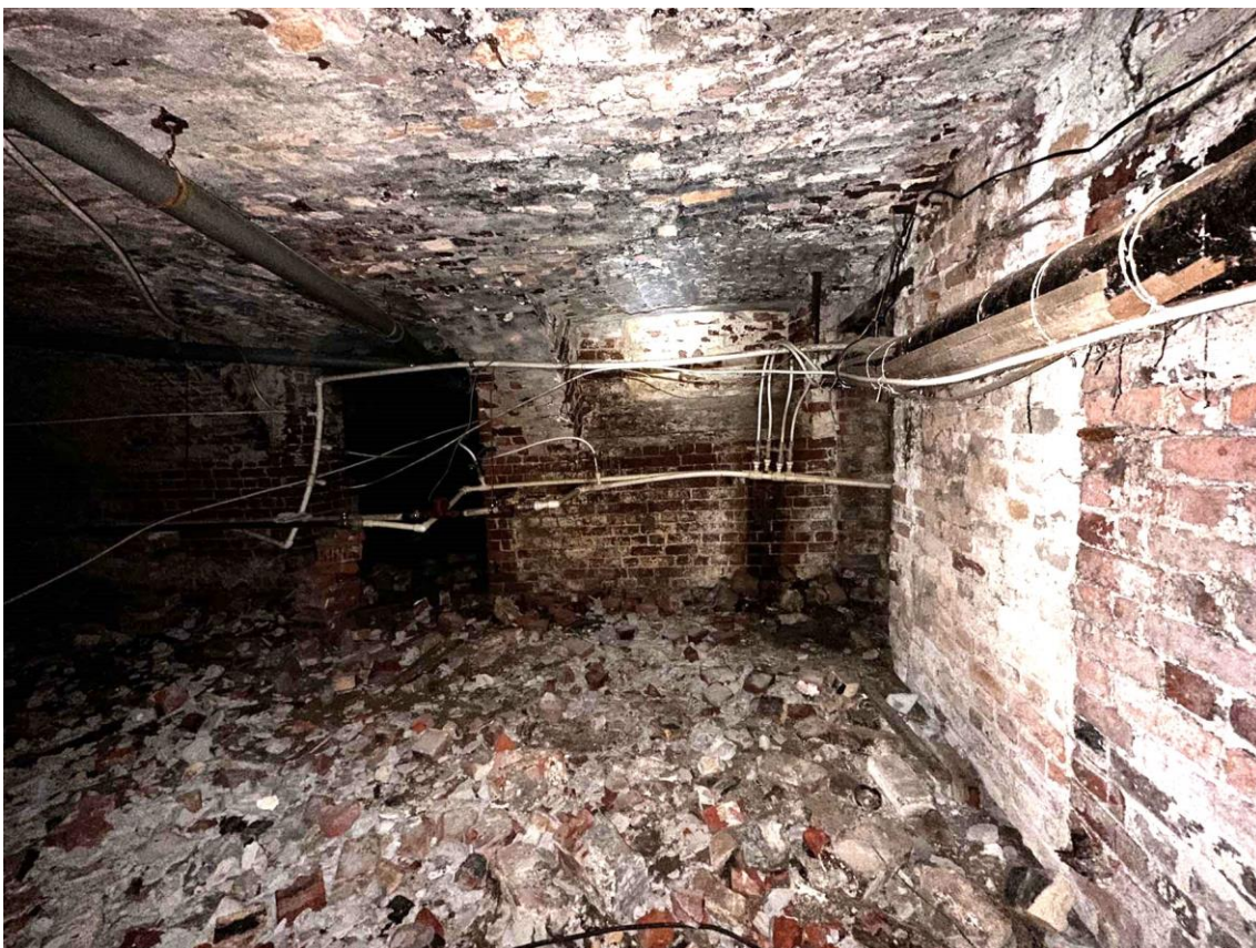
Фото 7. Пом.0.2. Вид на северо-западную часть помещения. Дата съемки: 23.01.2025 г. Автор съемки: Глинская Н.Б.
