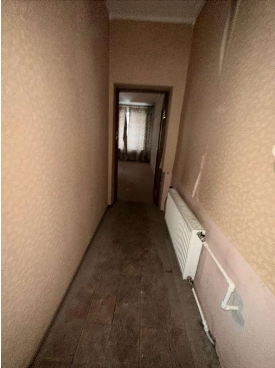
Фото 8. Общий вид коридора пом. 1 с юго-запада. Дата съемки: 10.04.2024 г. Автор съемки: Глинская Н.Б.
