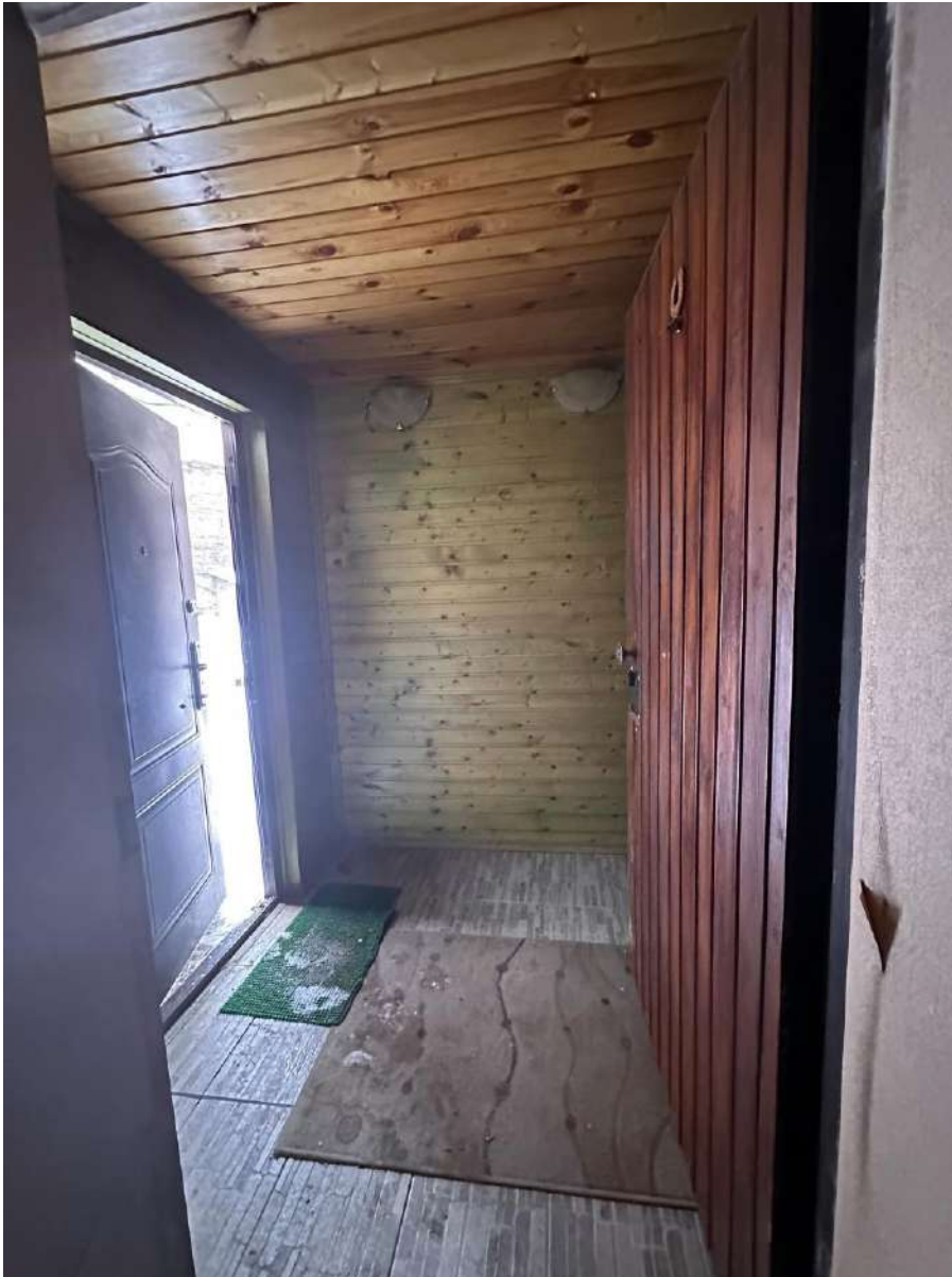
Фото 6. Общий вид помещения тамбура с северо-востока. Дата съемки: 10.04.2024 г. Автор съемки: Глинская Н.Б.
