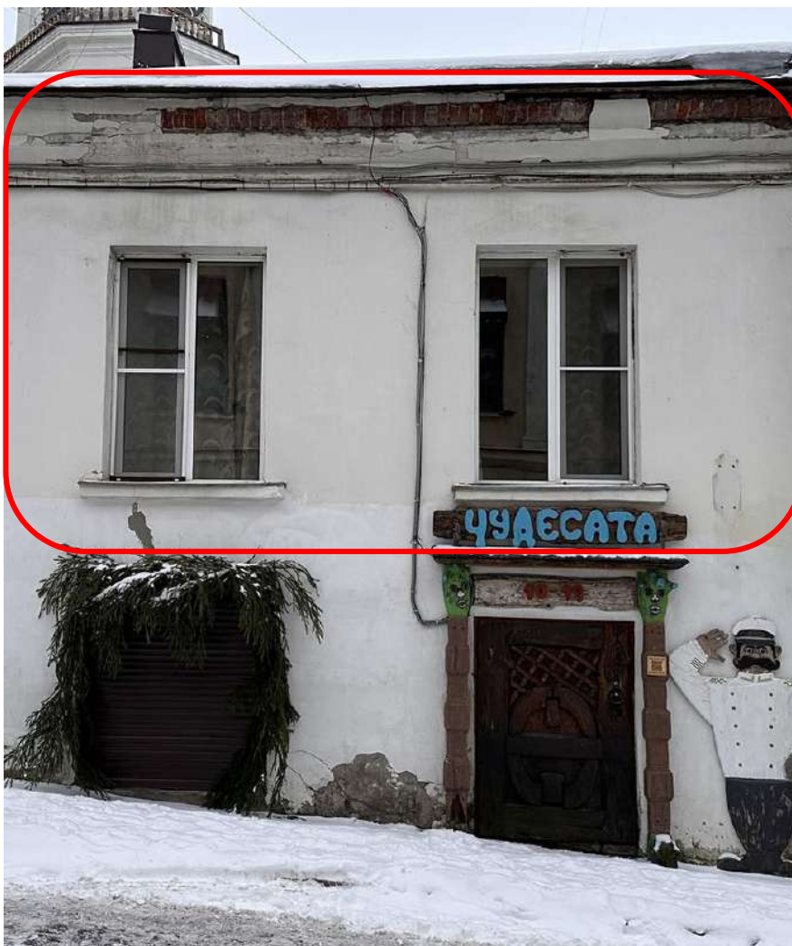
Фото 3. Фрагмент правой части лицевого северо-восточного фасада здания, соответствующий помещению собственника квартиры № 2. Дата съемки: 10.04.2024 г. Автор съемки: Глинская Н.Б.
