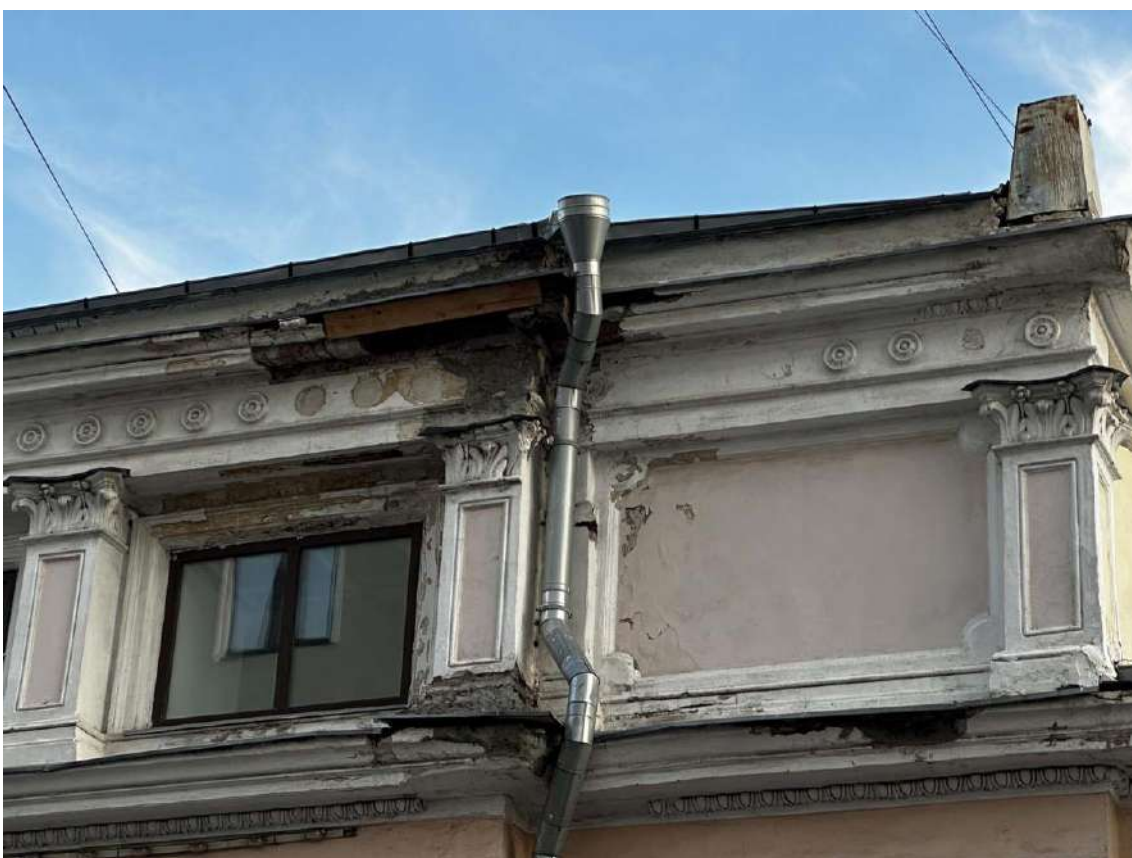
Фото 15. Фрагмент повышенной правой части уличного северо-восточного фасада здания. Дата съемки: 25.09.2024 г. Автор съемки: Куваева Ю.П.
