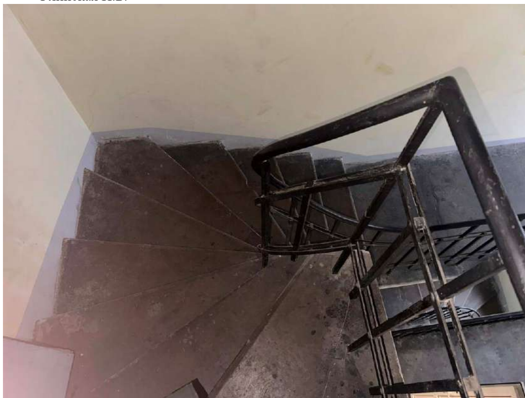
Фото 61. ЛК-2. Вид на верхние площадки. Фото с юго-востока. Дата съемки: 03.02.2025 г. Автор съемки: Глинская Н.Б.
