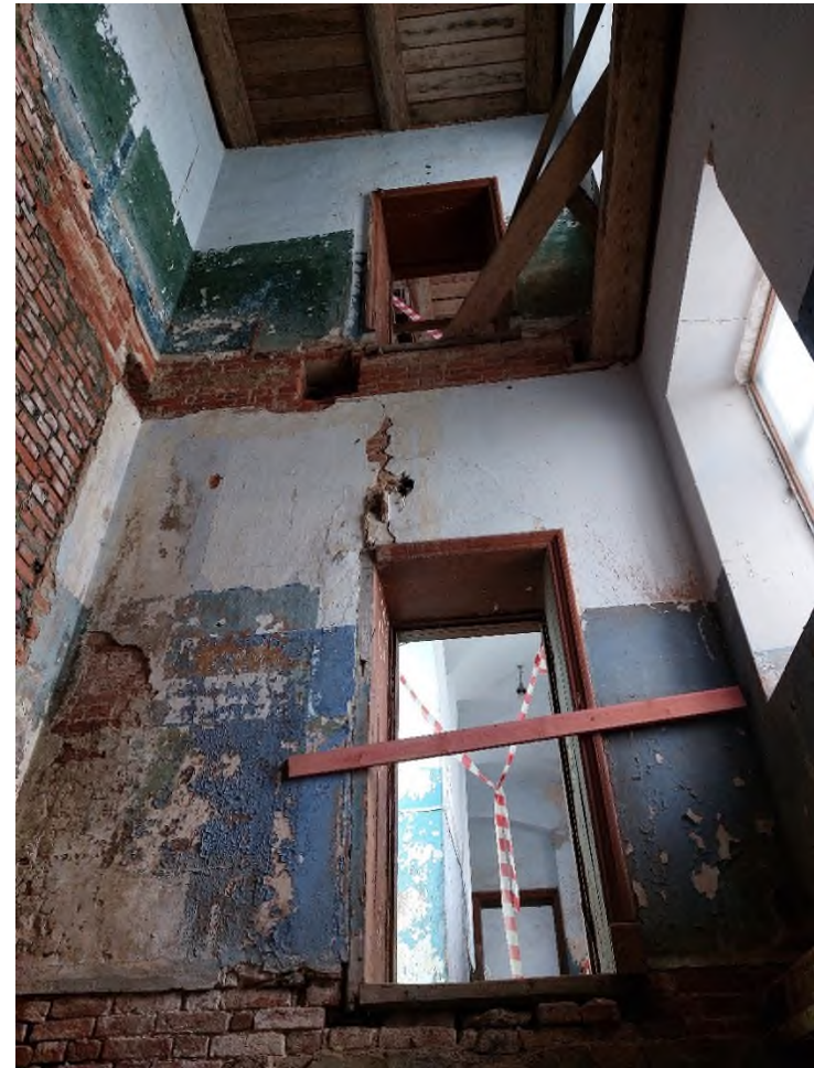
Фото 10. Первый этаж. Состояние кирпичной кладки стен, оконного и дверного проемов и их заполнений.
