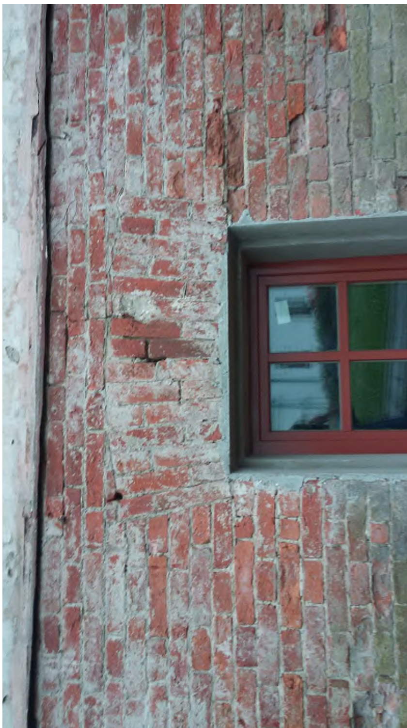
Илл.30. Северный фасад. Состояние кирпичной кладки - высолы, трещины, деструкция, биопоражения, отсутствие штукатурного слоя. Состояние линейных покрытий - коррозия. Фотофиксация. Акт отнесения/не отнесения объекта культурного наследия (памятника истории и культуры) народов Российской Федерации к объектам культурного наследия, находящимся в неудовлетворительном состоянии. 2017г
