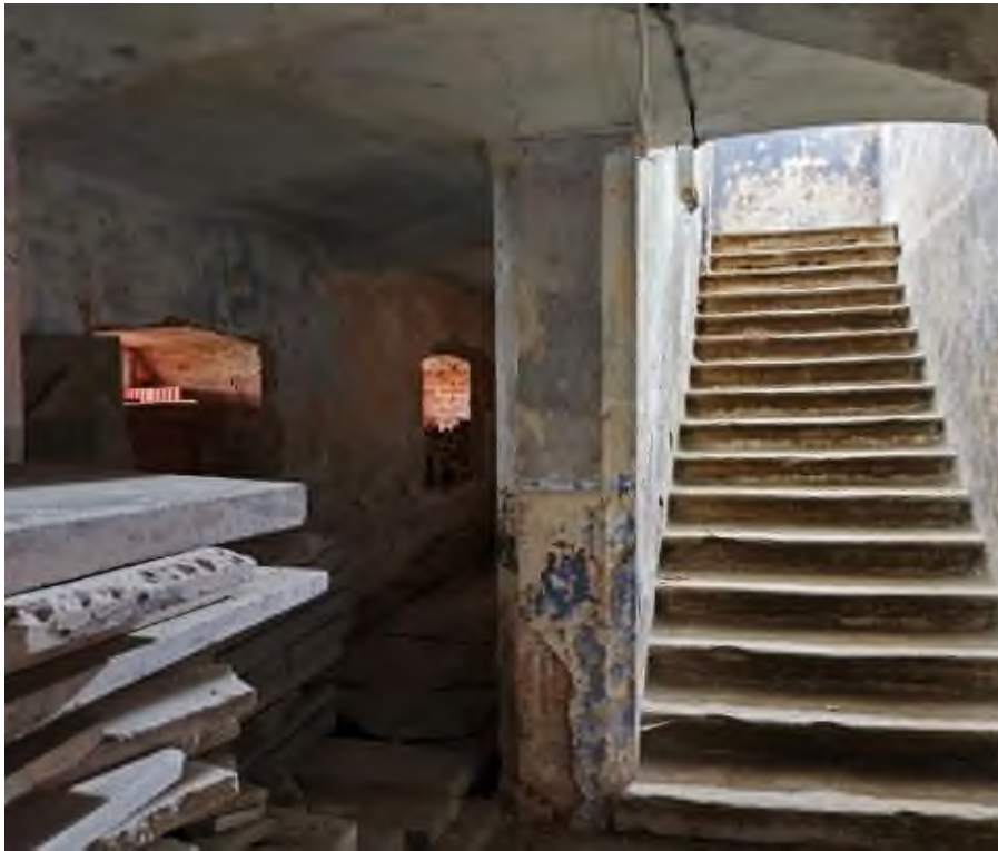
Фото 3. Цокольный этаж. Состояние стен, сводов и каменных ступеней лестницы.
