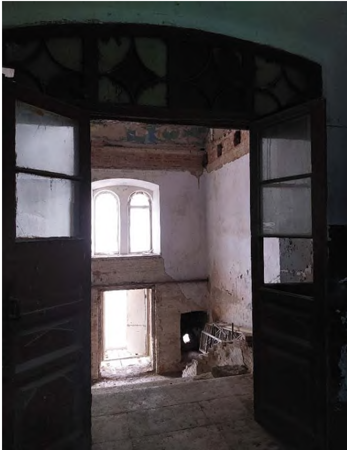
Фото 15. Первый этаж. Состояние оштукатуренных стен, сводов, полов из лещадных плит, оконных, дверных проемов и их заполнений.
