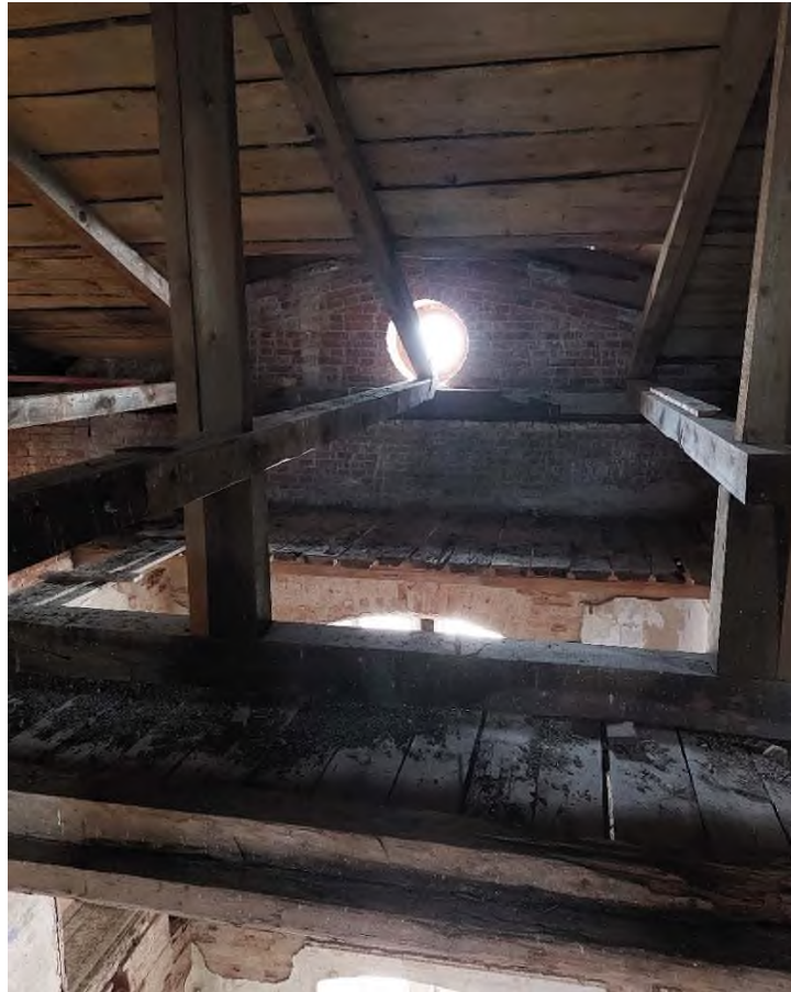
Фото 24. Чердак. Состояние стропильной системы, обрешетки, слухового окна, чердачное перекрытие частично утрачено
