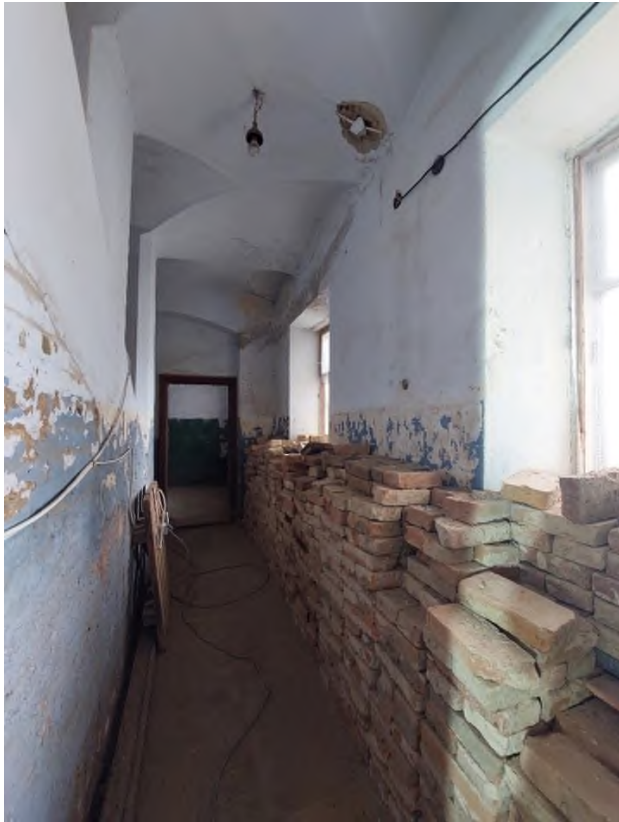
Фото 11. Первый этаж. Состояние оштукатуренных стен, сводов, полов, оконных и дверного проемов и их заполнений.
