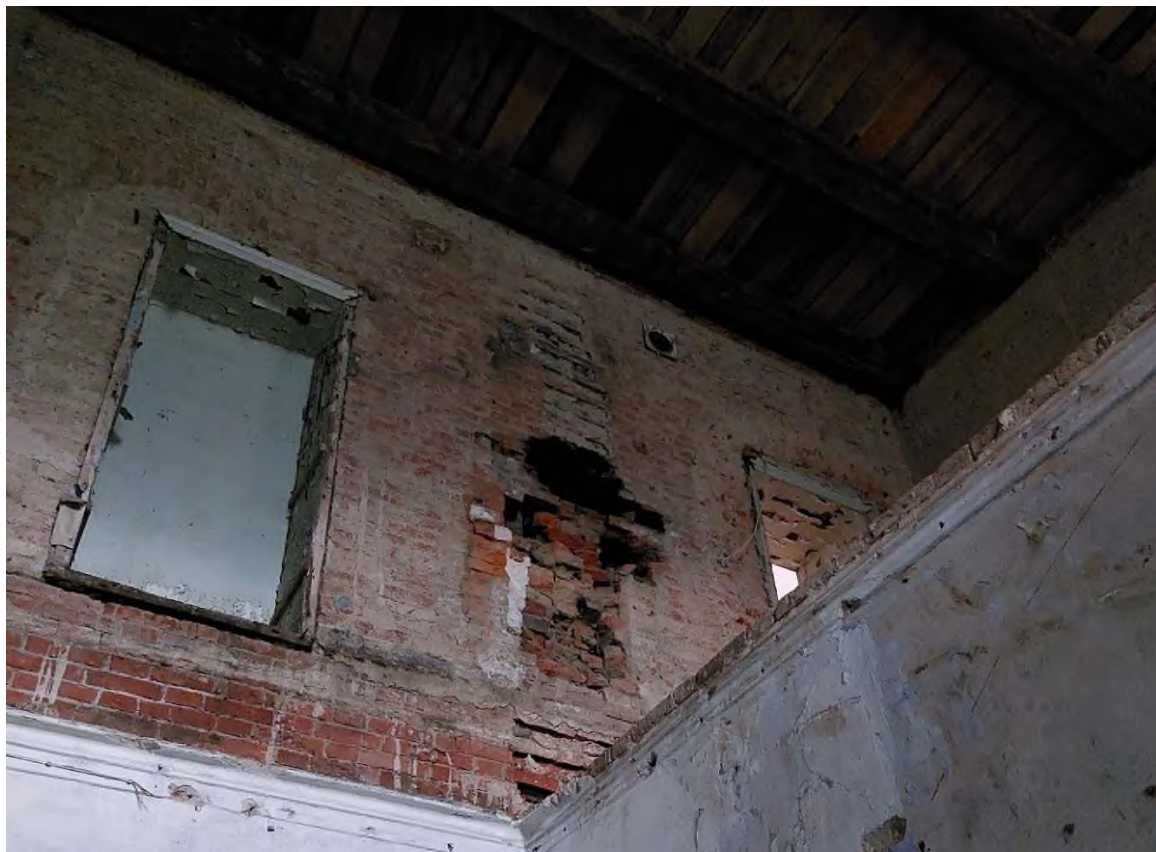
Фото 19. Второй этаж. Состояние кирпичной кладки стен, ниши, дверного проема и заполнения.
