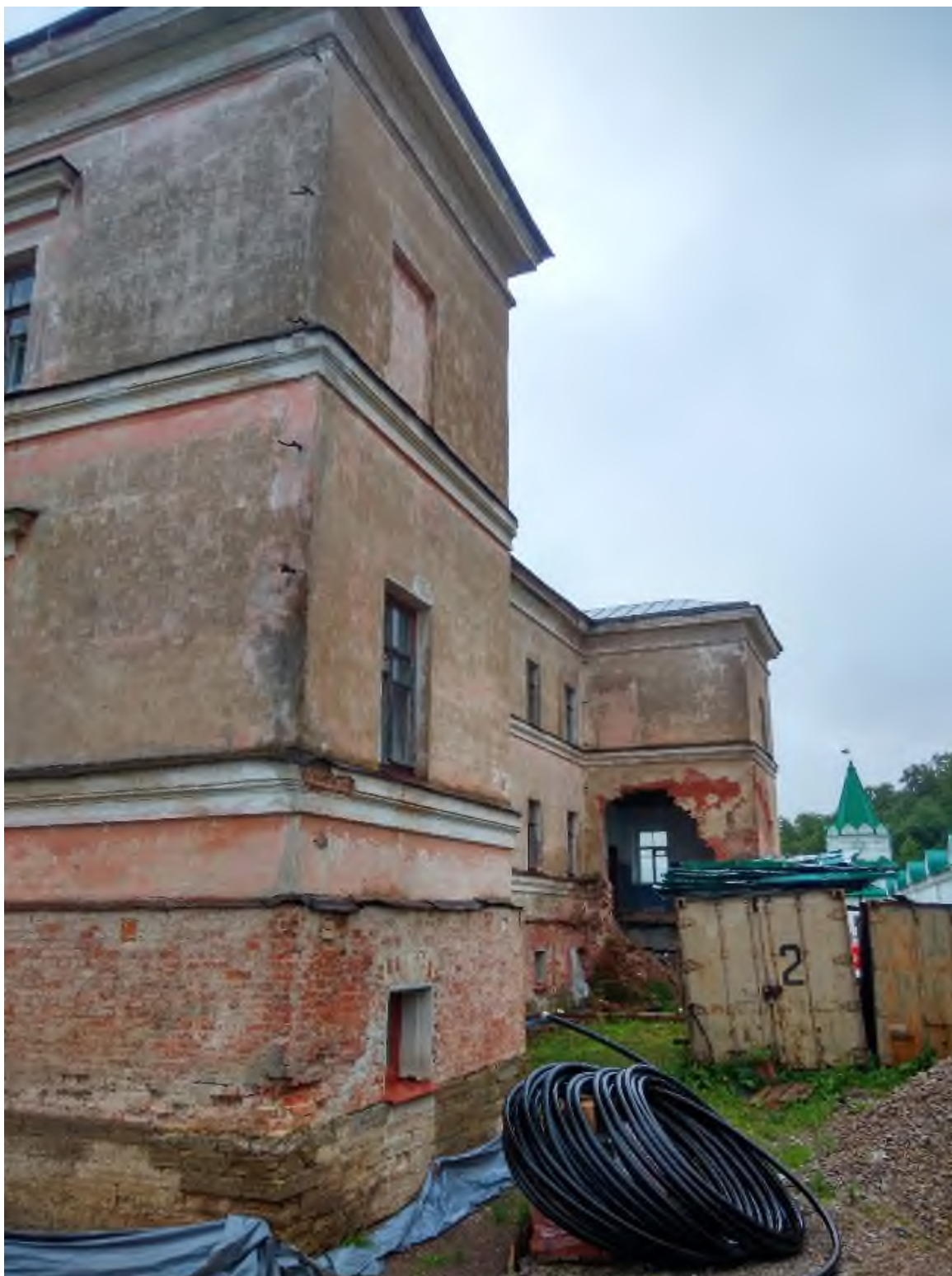
Илл.32. Западный фасад. Общий вид. Состояние штукатурного слоя - высолы, трещины, деструкция, биопоражения, отсутствие штукатурного слоя венчающего карниза. Состояние линейных покрытий - коррозия. Состояние каменного цоколя – деструкция отделки, биопоражения, вывалы отдельных участков известняка. Фотофиксация. Акт отнесения/не отнесения объекта культурного наследия (памятника истории и культуры) народов Российской Федерации к объектам культурного наследия, находящимся в неудовлетворительном состоянии. 2017г
