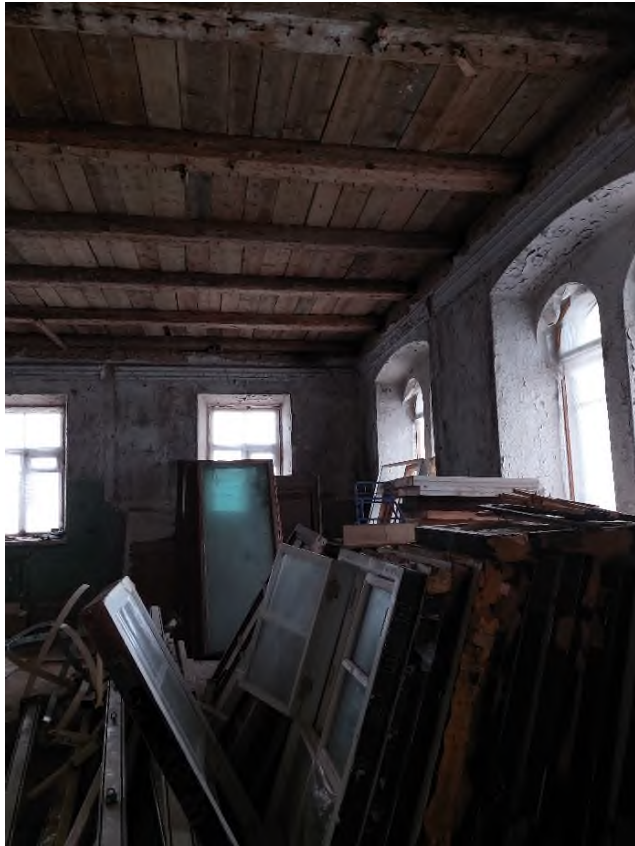
Фото 17. Первый этаж. Состояние оштукатуренных стен, потолка, полов, оконных проемов и их заполнений.
