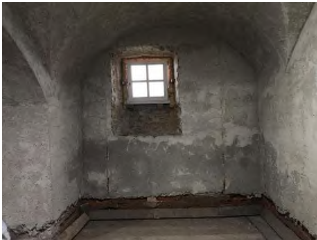
Фото 5. Цокольный этаж. Состояние стен, сводов, полов, окна и его заполнения.
