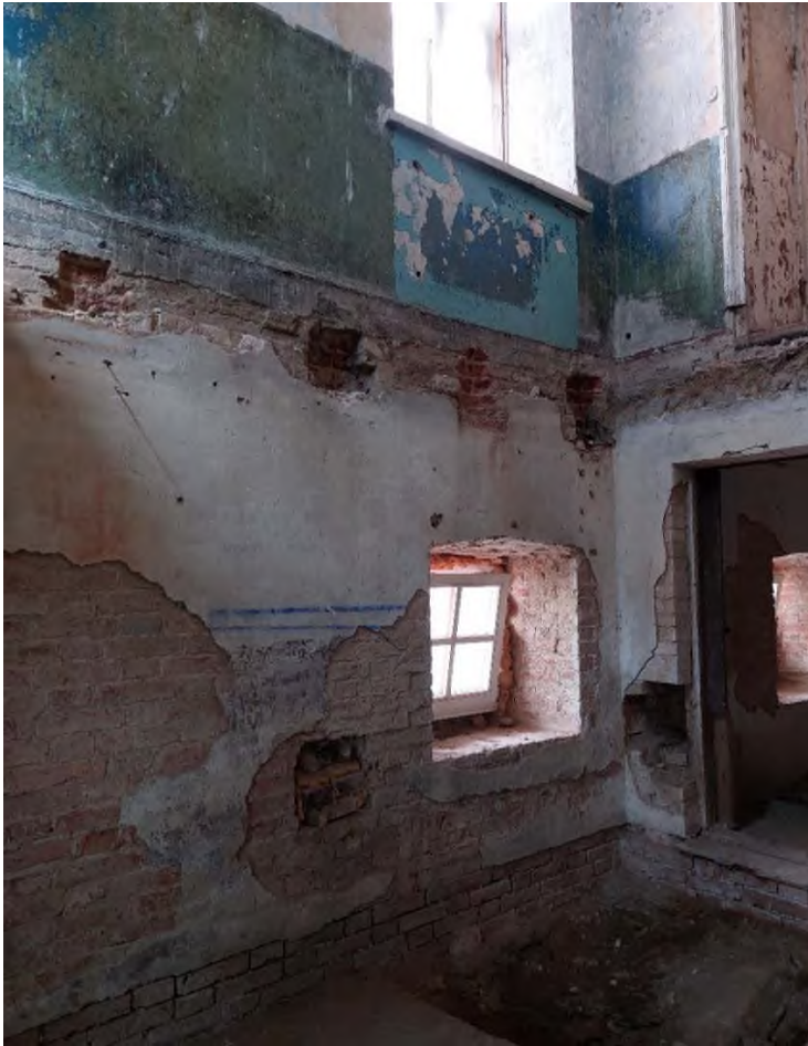
Фото 9. Цокольный этаж. Состояние кирпичной кладки стен, оконного и дверного проемов и их заполнений.
