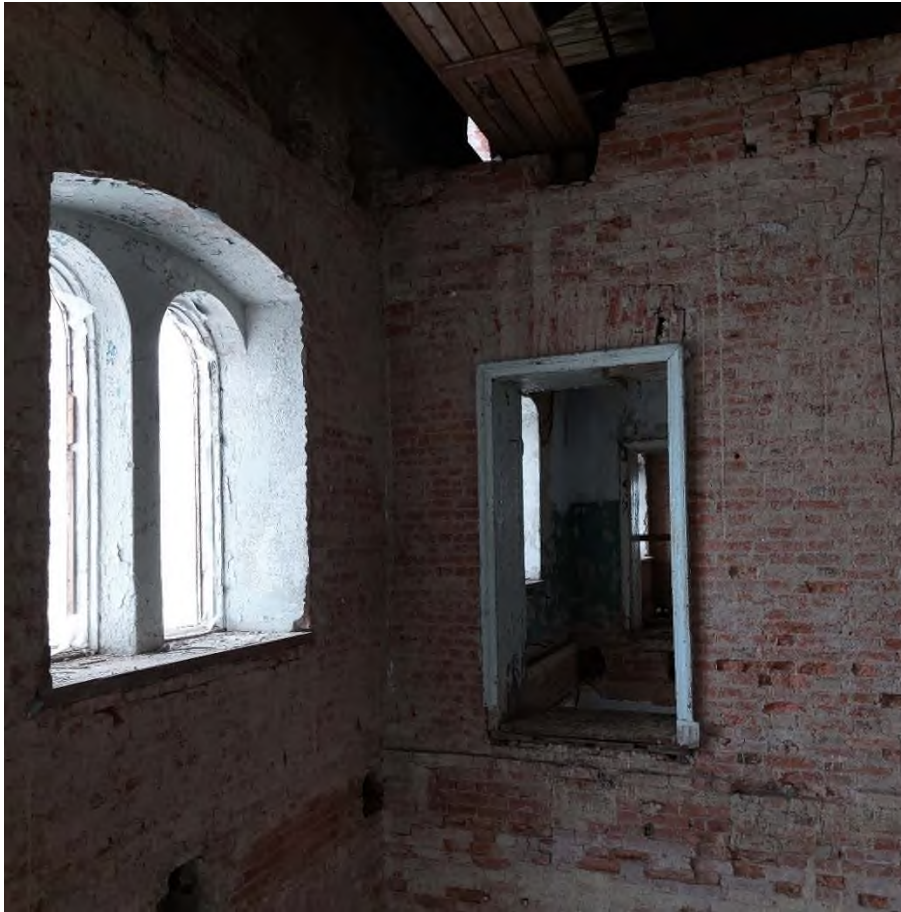
Фото 22. Второй этаж. Состояние кирпичных стен, оконных, дверных проемов и их заполнений, утрачены межэтажное и чердачное перекрытия.
