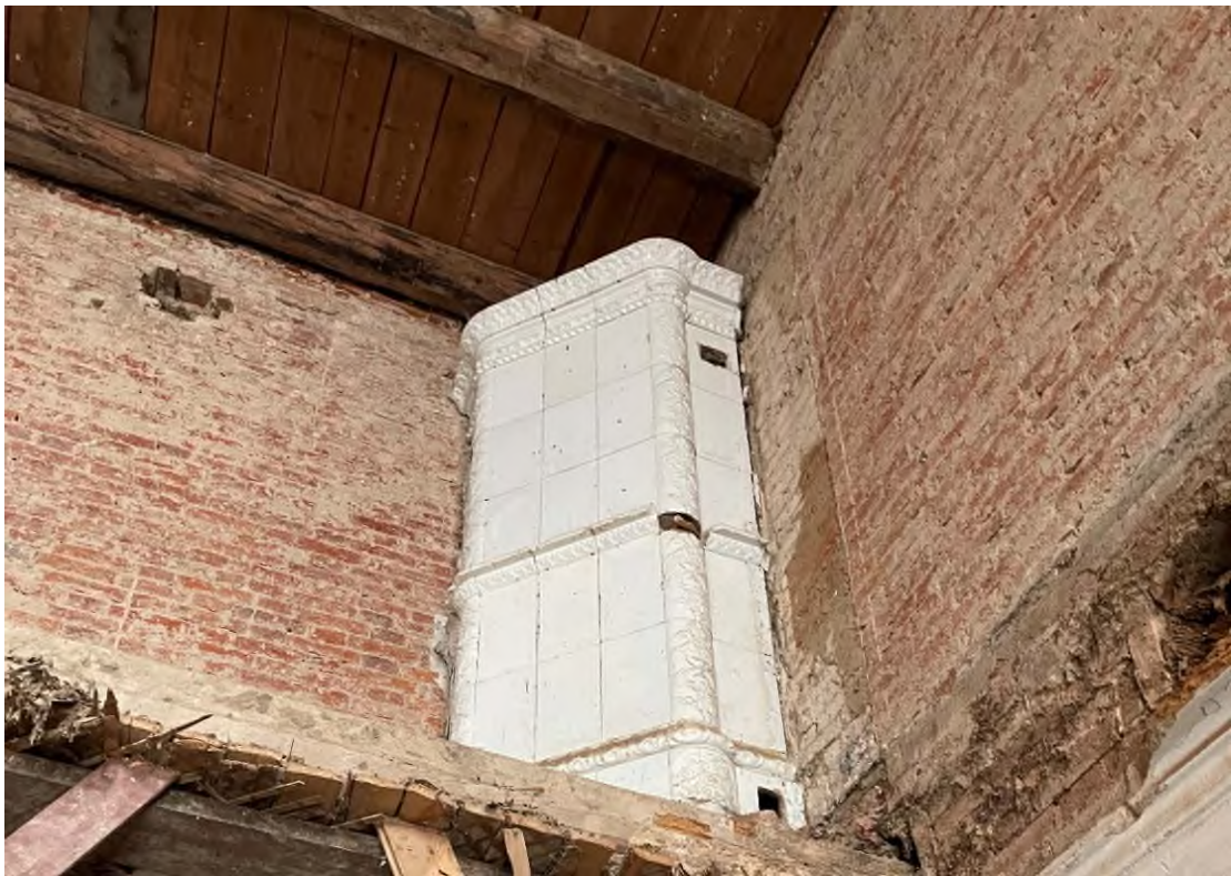
Фото 23. Второй этаж. Состояние кирпичной кладки стен, потолка, печи с израсцами, утрачено межэтажное перекрытие.
