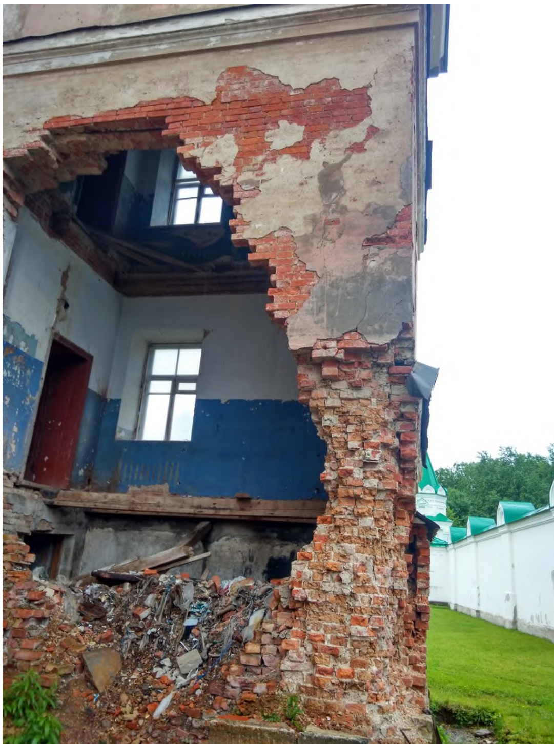
Илл.34. Западный фасад. Фрагмент. Состояние штукатурного слоя - высолы, трещины, деструкция, биопоражения, отсутствие штукатурного слоя венчающего карниза. Состояние линейных покрытий - коррозия. Состояние каменного цоколя – деструкция отделки, биопоражения, вывалы отдельных участков известняка. Состояние кирпичной кладки - высолы, трещины, деструкция, биопоражения, отсутствие штукатурного слоя. Обрушение участка стены. Обрушение перекрытий. Фотофиксация. Акт отнесения/не отнесения объекта культурного наследия (памятника истории и культуры) народов Российской Федерации к объектам культурного наследия, находящимся в неудовлетворительном состоянии. 2017г
