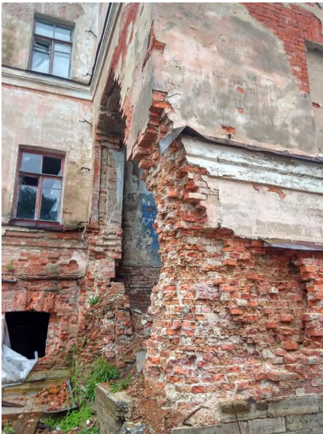
Илл.33. Западный фасад. Фрагмент. Состояние штукатурного слоя - высолы, трещины, деструкция, биопоражения, отсутствие штукатурного слоя венчающего карниза. Состояние линейных покрытий - коррозия. Состояние каменного цоколя – деструкция отделки, биопоражения, вывалы отдельных участков известняка. Состояние кирпичной кладки - высолы, трещины, деструкция, биопоражения, отсутствие штукатурного слоя. Обрушение участка стены. Фотофиксация. Акт отнесения/не отнесения объекта культурного наследия (памятника истории и культуры) народов Российской Федерации к объектам культурного наследия, находящимся в неудовлетворительном состоянии. 2017г
