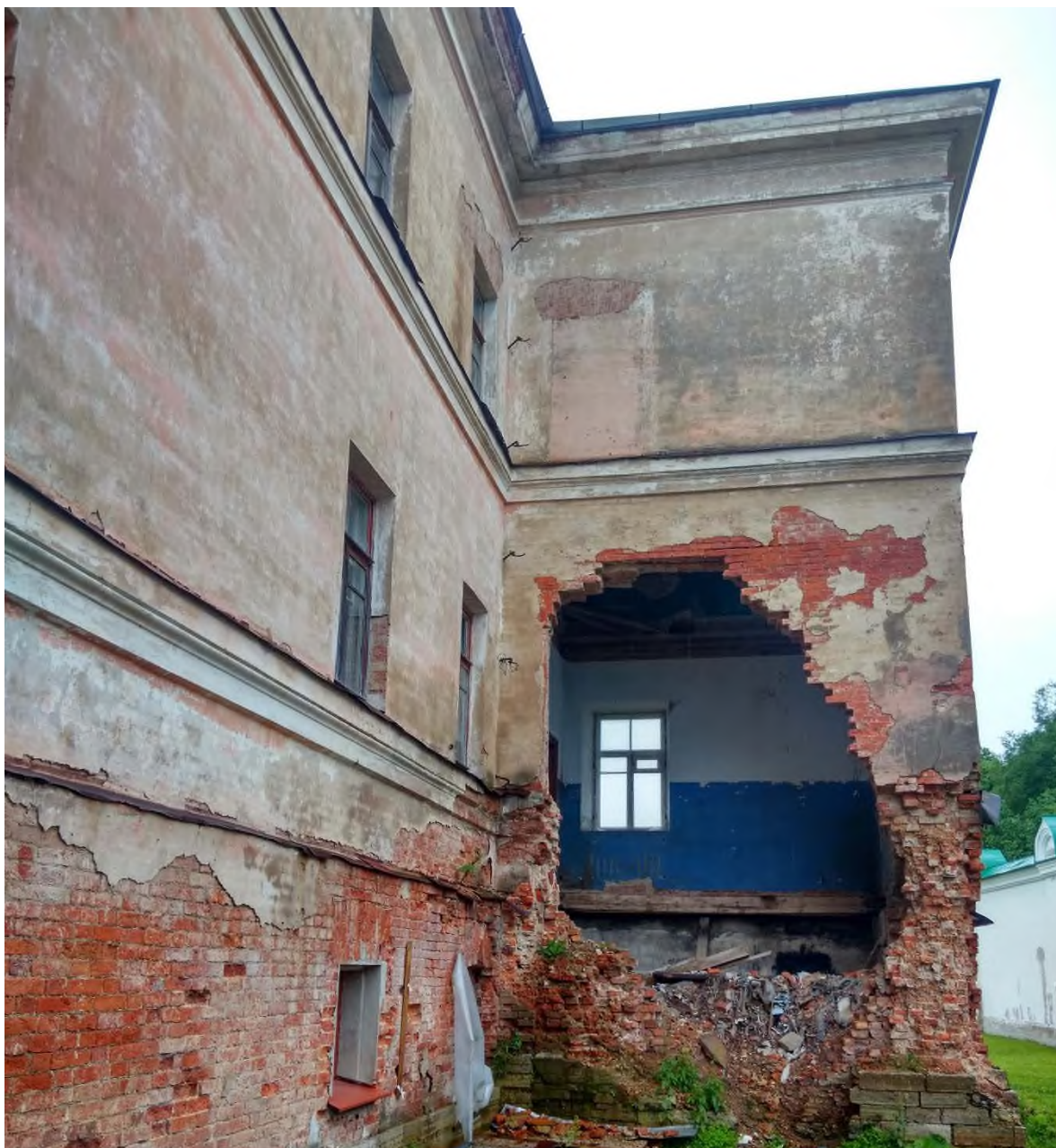
Илл.35. Западный фасад. Фрагмент. Состояние штукатурного слоя - высолы, трещины, деструкция, биопоражения, отсутствие штукатурного слоя венчающего карниза. Состояние линейных покрытий - коррозия. Состояние каменного цоколя – деструкция отделки, биопоражения, вывалы отдельных участков известняка. Состояние кирпичной кладки - высолы, трещины, деструкция, биопоражения, отсутствие штукатурного слоя. Обрушение участка стены. Обрушение перекрытий. Отклонение стен от вертикали – «пузо». Фотофиксация. Акт отнесения/не отнесения объекта культурного наследия (памятника истории и культуры) народов Российской Федерации к объектам культурного наследия, находящимся в неудовлетворительном состоянии. 2017г
