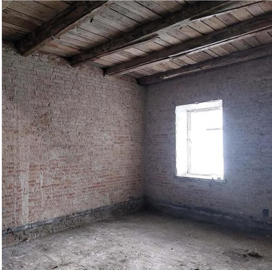
Фото 168. Второй этаж. Состояние кирпичной кладки стен, потолка, пола, ниши.
