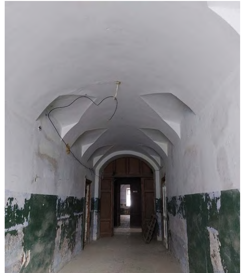
Фото 14. Первый этаж. Состояние оштукатуренных стен, сводов, полов из лещадных плит, дверных проемов и их заполнений.
