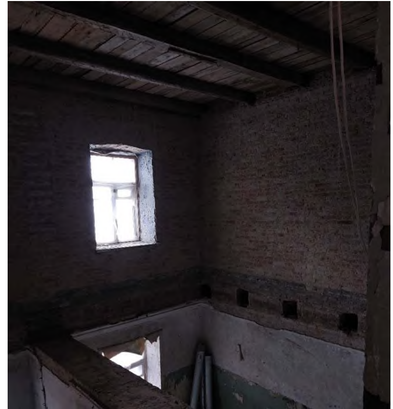
Фото 18. Второй этаж. Состояние кирпичных стен, оконных проемов и их заполнений
