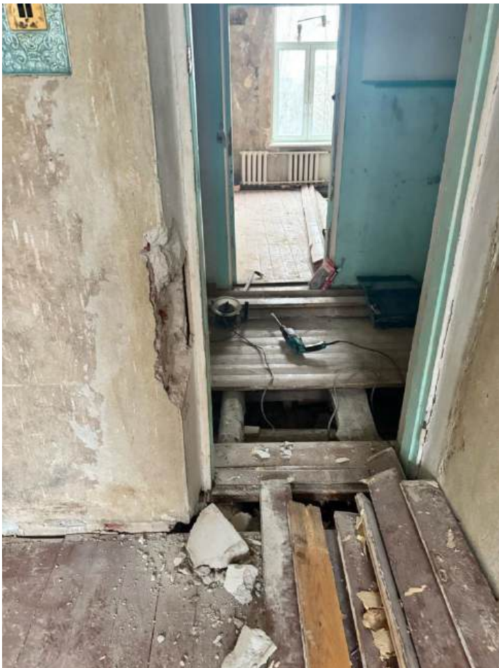
Фото 8. Пол между пом. 1 и 6. Дата съемки: 19.11.2025 г. Автор съемки: Хватова Ж.А.
