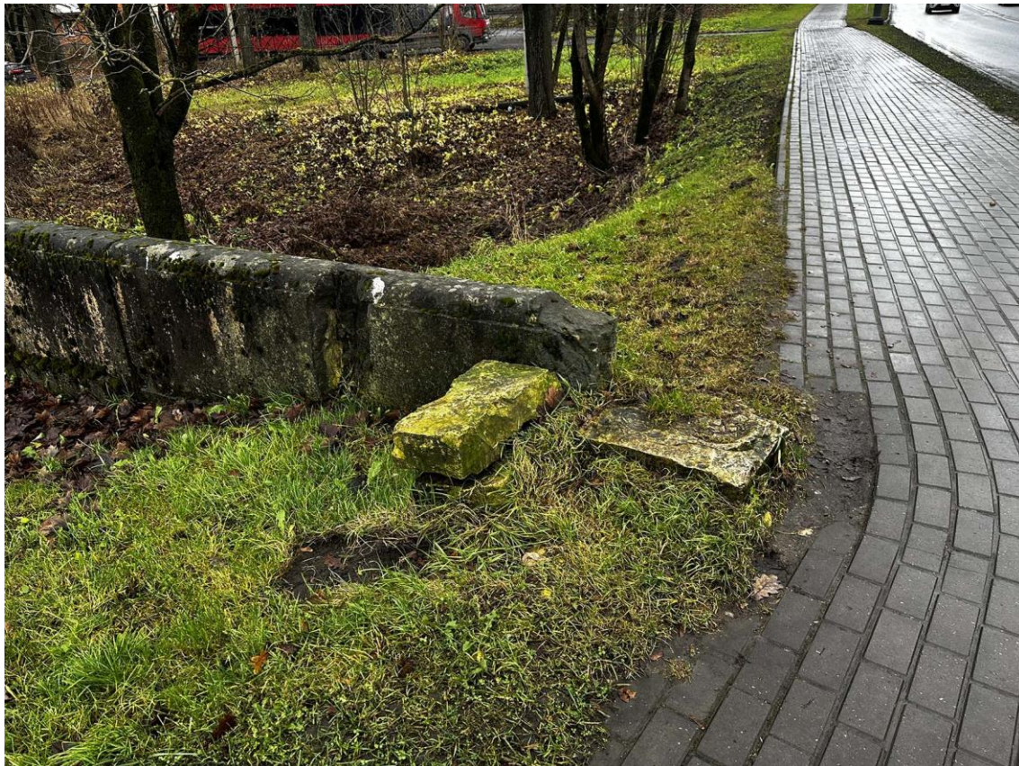
Фото 98. Юго-восточная часть подпорных (парапетных) стен. Правая часть внутренней стороны стены на участке 18-19 с разрушенной завершающей тумбой. Фото с севера. Дата съемки: 15.11.2025 г. Автор съемки: Куваева Ю.П.
