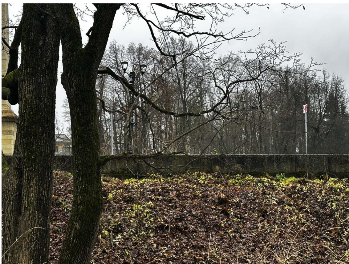
Фото 112. Юго-восточная часть подпорных (парапетных) стен. Левая часть наружной стороны стены на участке 17-1. Фото с юго-востока. Дата съемки: 15.11.2025 г. Автор съемки: Куваева Ю.П.
