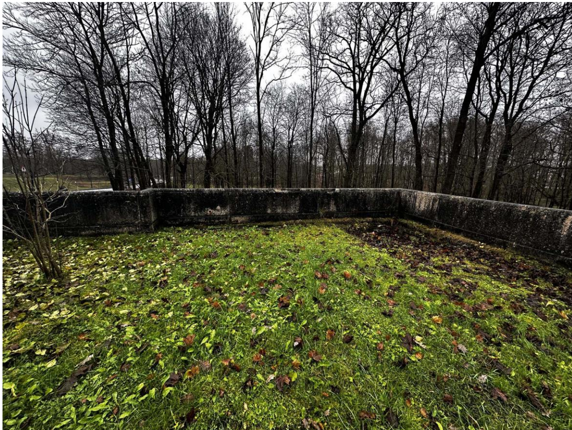
Фото 84. Юго-восточная часть подпорных (парапетных) стен. Правая часть внутренней стороны стены на участке 15-16. Фото с юго-запада. Дата съемки: 15.11.2025 г. Автор съемки: Куваева Ю.П.
