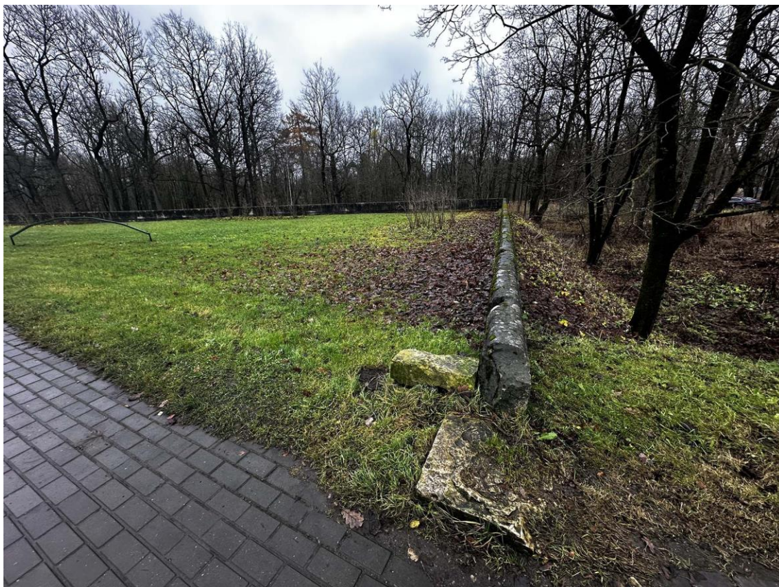
Фото 99. Юго-восточная часть подпорных (парапетных) стен. Общий вид стены на участке 19-18 с разрушенной завершающей тумбой. Фото с северо-запада. Дата съемки: 15.11.2025 г. Автор съемки: Куваева Ю.П.
