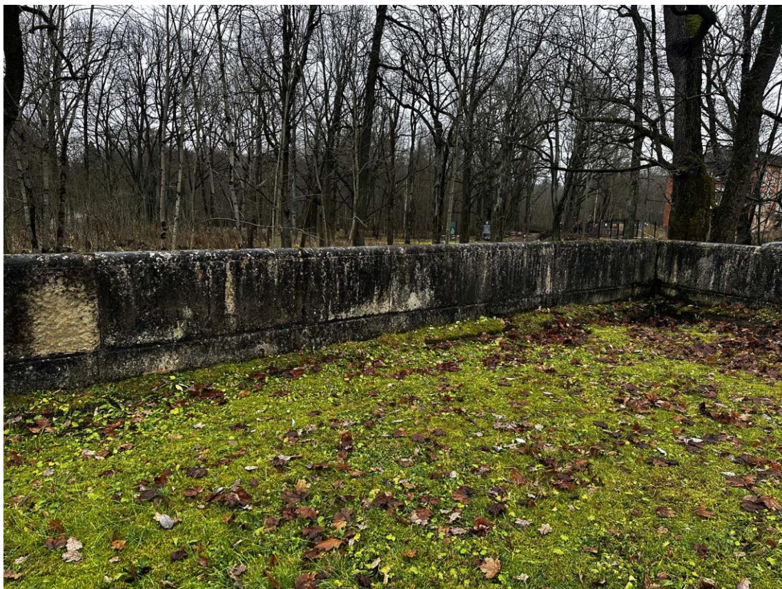
Фото 93. Юго-восточная часть подпорных (парапетных) стен. Фрагмент правой части внутренней стороны стены на участке 17-18 и угол поворота стены (точка 18). Фото с севера. Дата съемки: 15.11.2025 г. Автор съемки: Куваева Ю.П.
