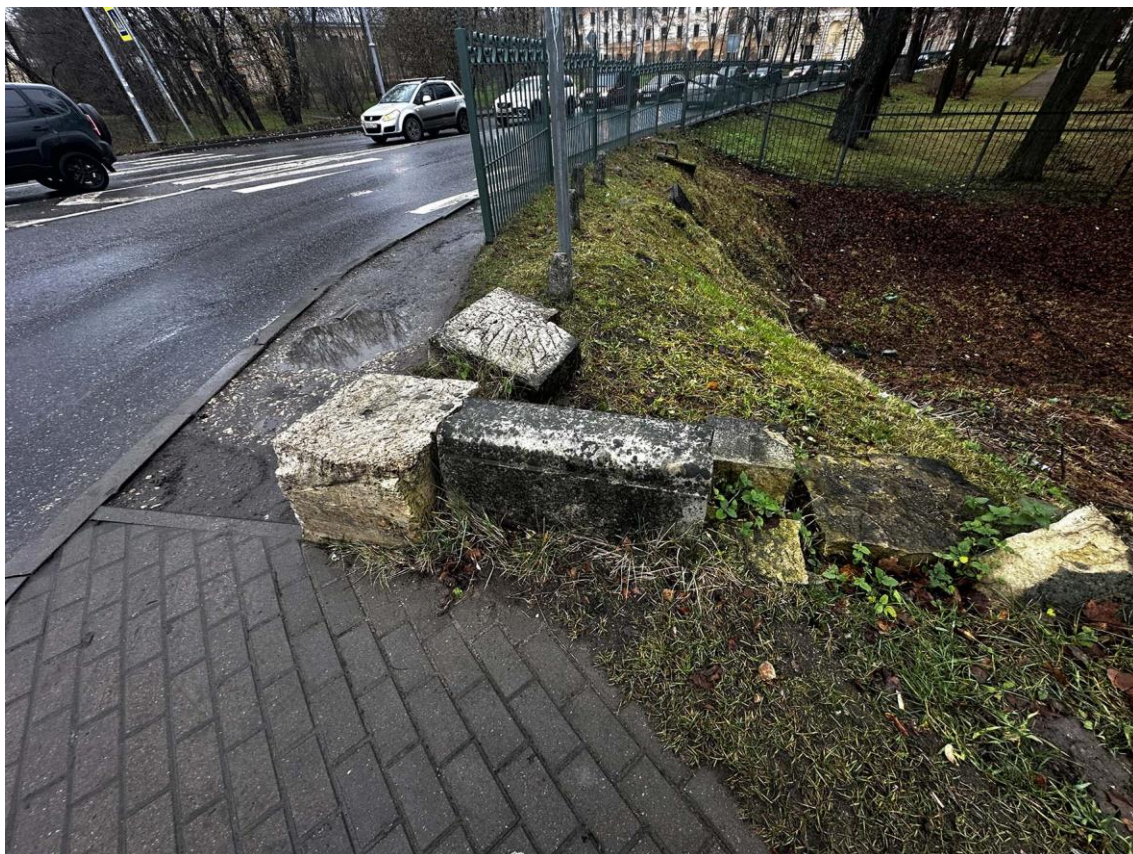
Фото 29. Северная часть подпорных (парапетных) стен. Фрагмент разрушенной завершающей тумбы стены. Фото внутренней стороны стены на участке 4-5. Фото с востока. Дата съемки: 15.11.2025 г. Автор съемки: Куваева Ю.П.
