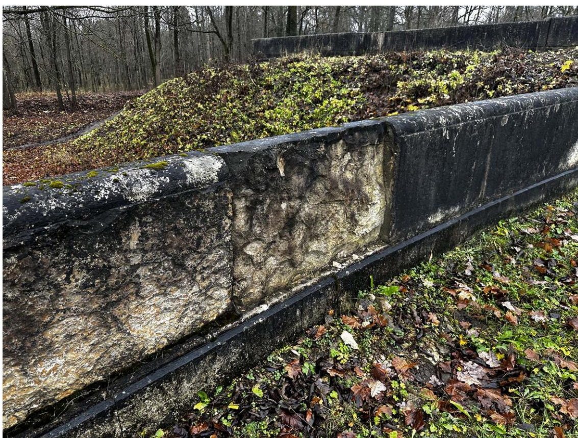
Фото 70. Юго-восточная часть подпорных (парапетных) стен. Фрагмент внутренней стороны стены на участке 11-12. Фото с севера. Дата съемки: 15.11.2025 г. Автор съемки: Куваева Ю.П.
