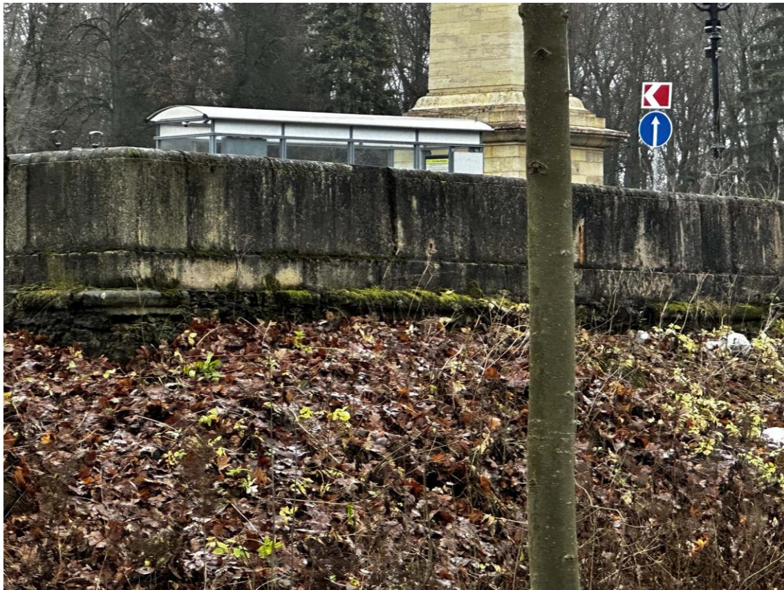
Фото 106. Юго-восточная часть подпорных (парапетных) стен. Угол поворота стены в точке 18. Фото с юга. Дата съемки: 15.11.2025 г. Автор съемки: Куваева Ю.П.
