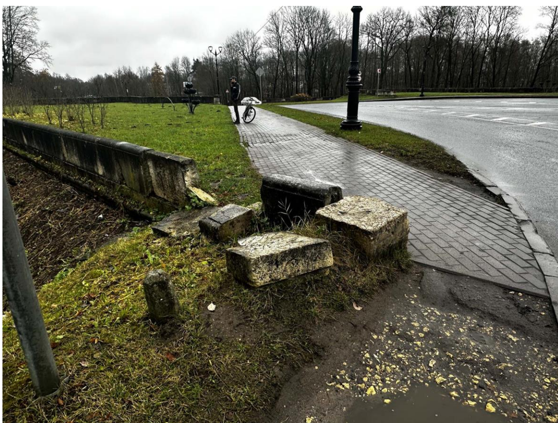
Фото 28. Северная часть подпорных (парапетных) стен. Фрагмент правой части наружной стороны стены на участке 5-4. Завершающая разрушенная тумба стены. Фото с запада. Дата съемки: 15.11.2025 г. Автор съемки: Куваева Ю.П.
