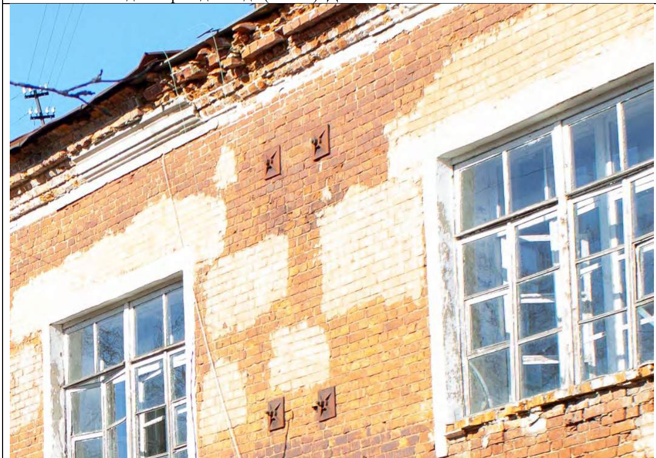
12. Металлические затяжки на фасаде. Дата съемки: 20.03.2026.
