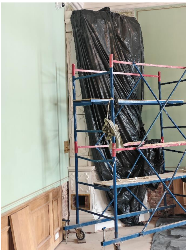
29. «Гатчинский дворец (с Арсенальным и Кухонным каре)», 1766-1781 г.г., 1793-1797 г.г. (перестроен), 1844-1851 г.г., Ленинградская область, Гатчинский муниципальный район, Гатчинское городское поселение город Гатчина, Красноармейский пр., д.1. Первый этаж. Нижняя тронная Павла I (помещение №62 по ПИБ). Фрагмент. Фото 20.02.2026г.
