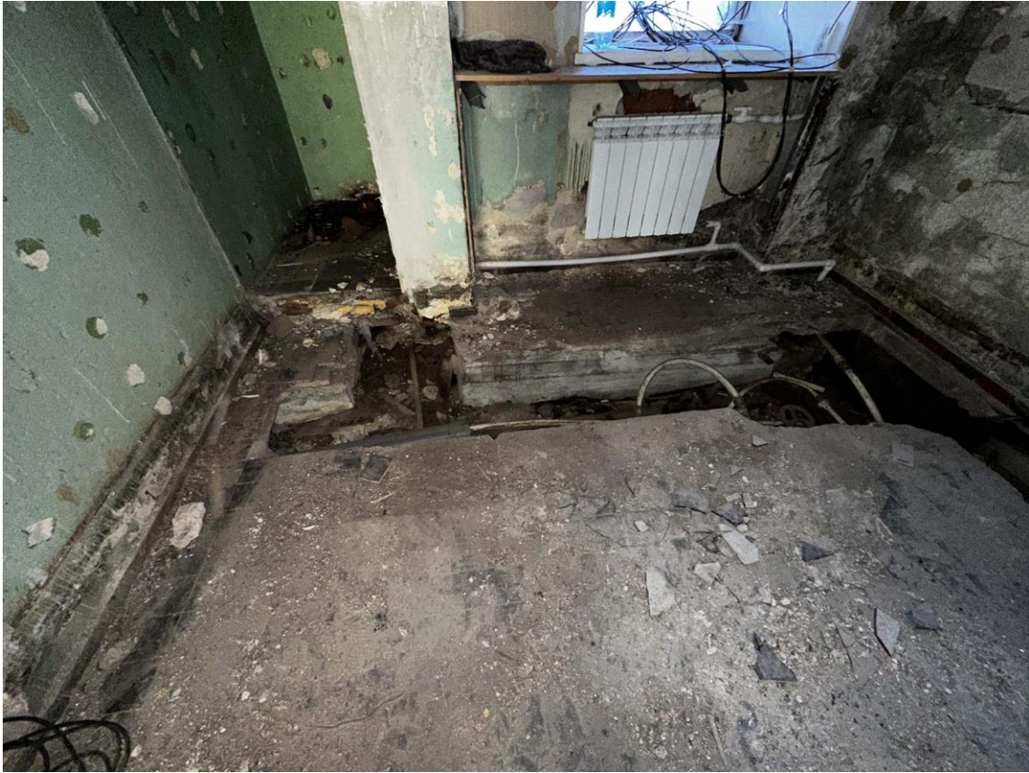
Фото 19. Пом. 1.4. Проложенные в полу коммуникации в северо-восточной части помещений. Дата съемки: 16.02.2026 г. Автор съемки: Глинская Н.Б.
