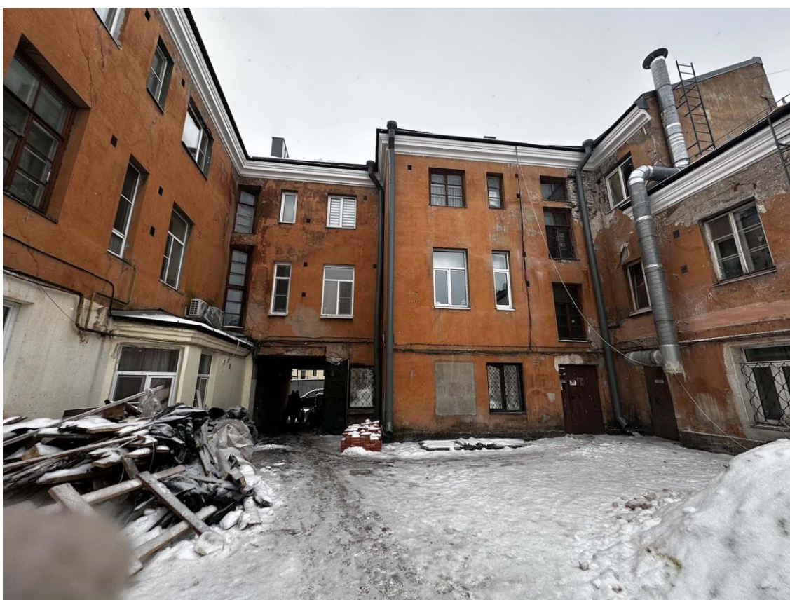
Фото 4. Общий вид северо-восточного дворового фасада здания. Фото с северо-запада. Дата съемки: 16.02.2026 г. Автор съемки: Глинская Н.Б.
