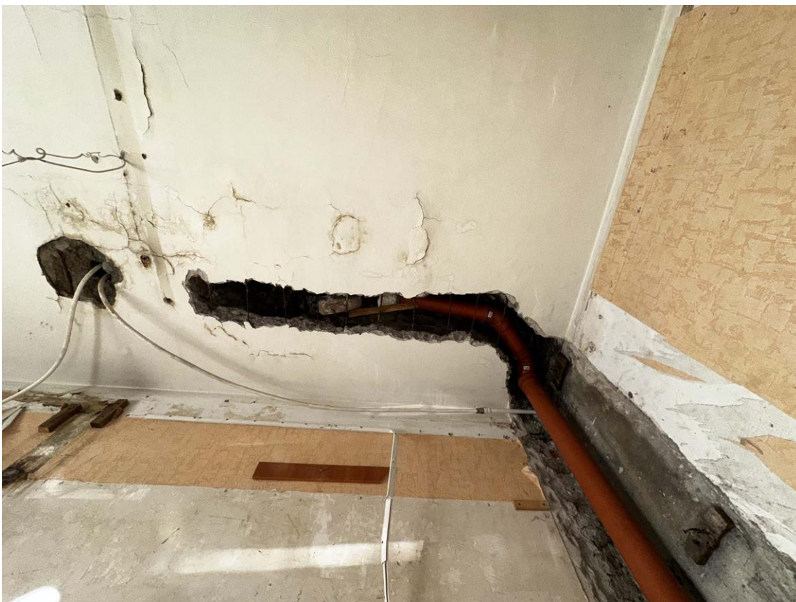
Фото 12. Пом. 1.2. Фрагмент разрушенного перекрытия в северной части помещения. Дата съемки: 16.02.2026 г. Автор съемки: Глинская Н.Б.
