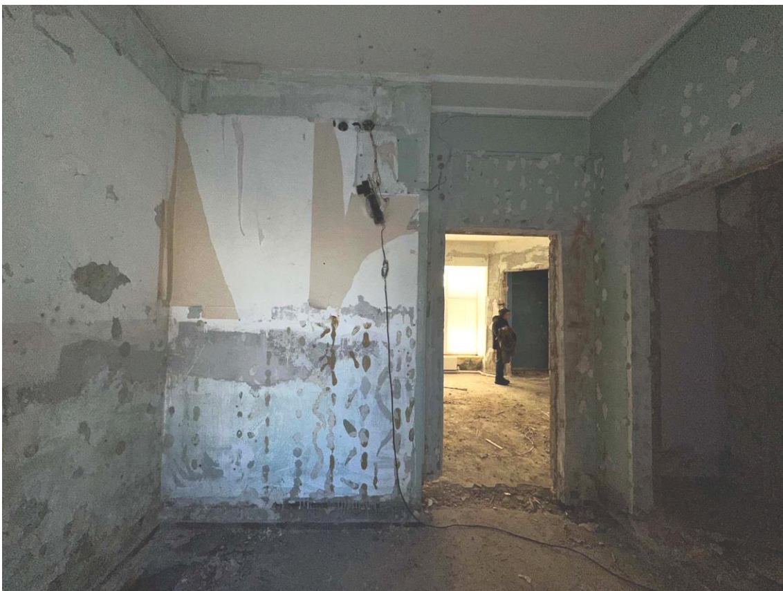
Фото 18. Пом.1.4. Общий вид помещения с северо-востока. Дата съемки: 16.02.2026 г. Автор съемки: Глинская Н.Б.
