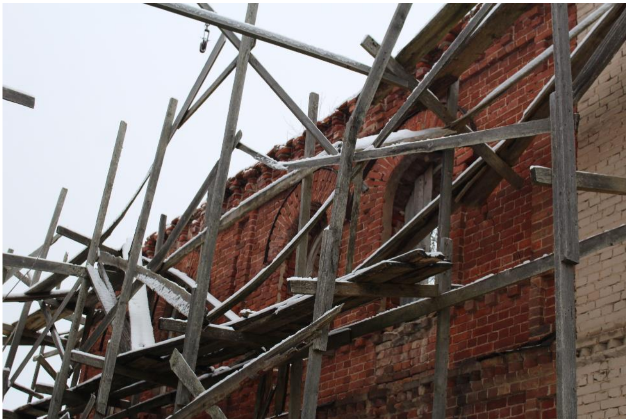
Фото 12. Фрагмент юго-западного фасада, второй этаж.
